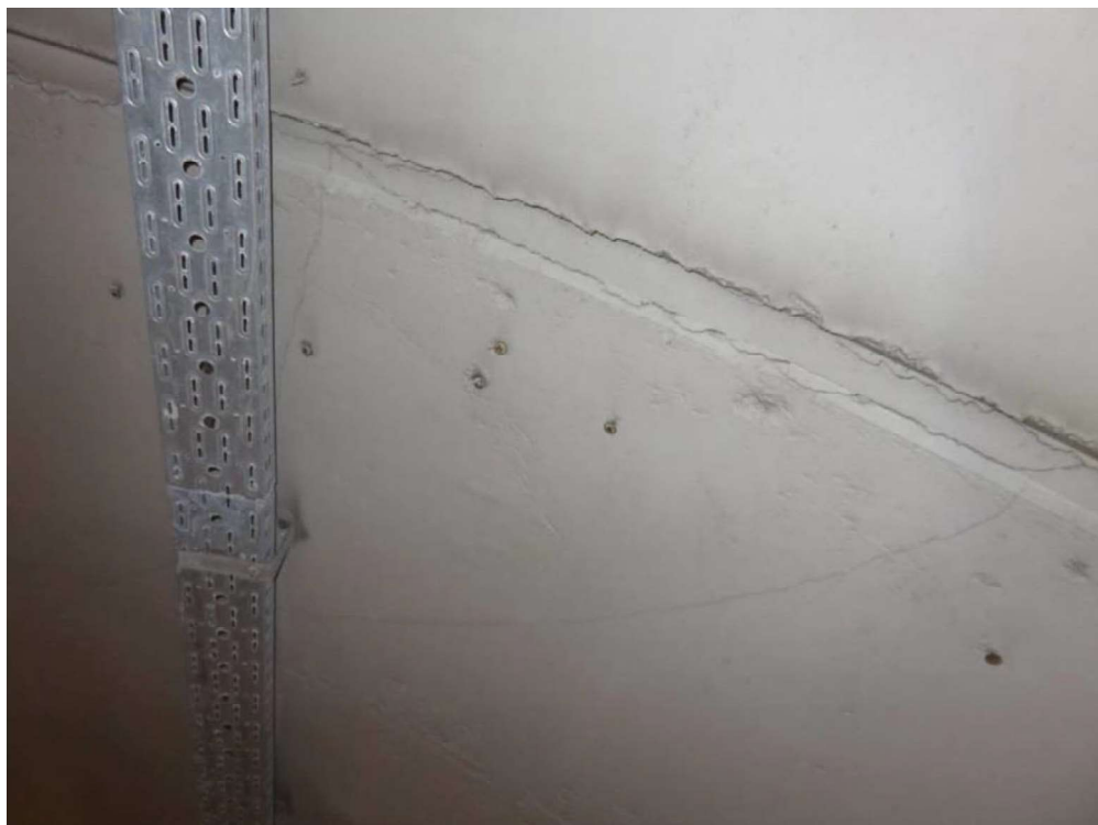
Slika 12: kampada 38 – ODLAMANJE BETONA
