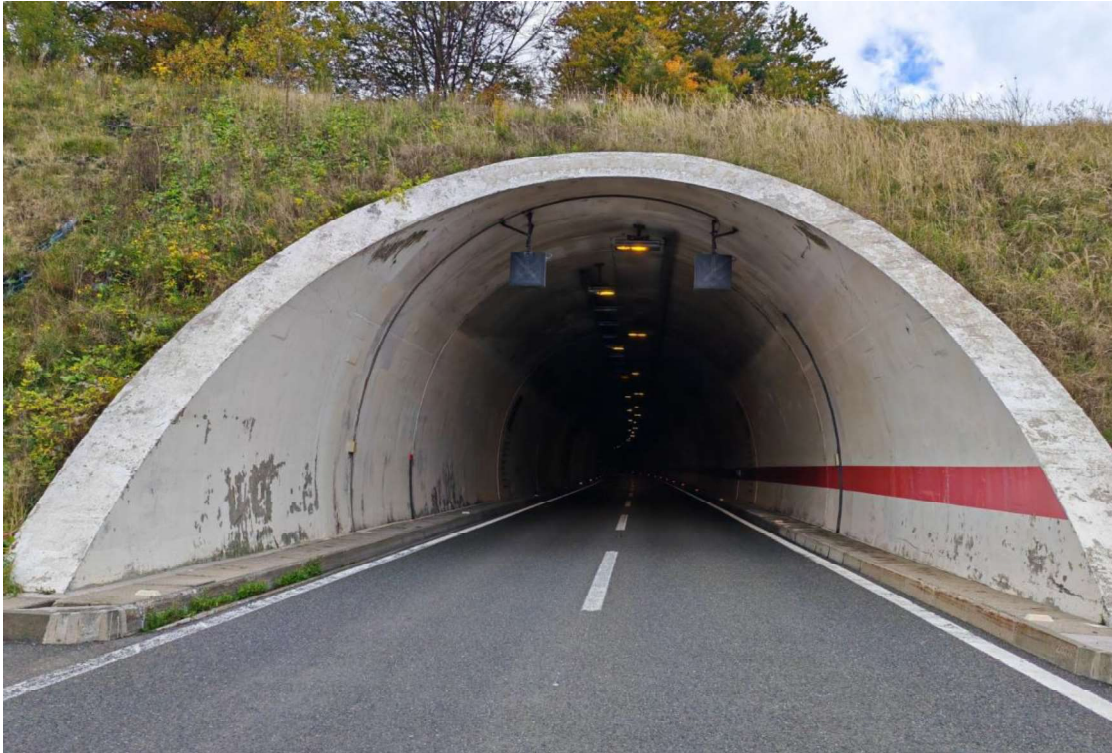
Slika 1: početni (izlazni) portal – LJUŠTENJE PREMAZA BETONA, KOROZIJA PLOČA HODNIKA
