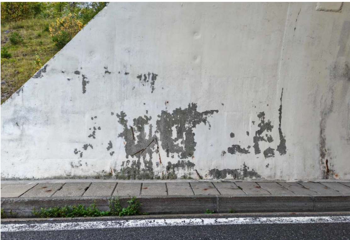
Slika 2: početni (izlazni) portal – LJUŠTENJE PREMAZA BETONA, KOROZIJA ARMATURE
