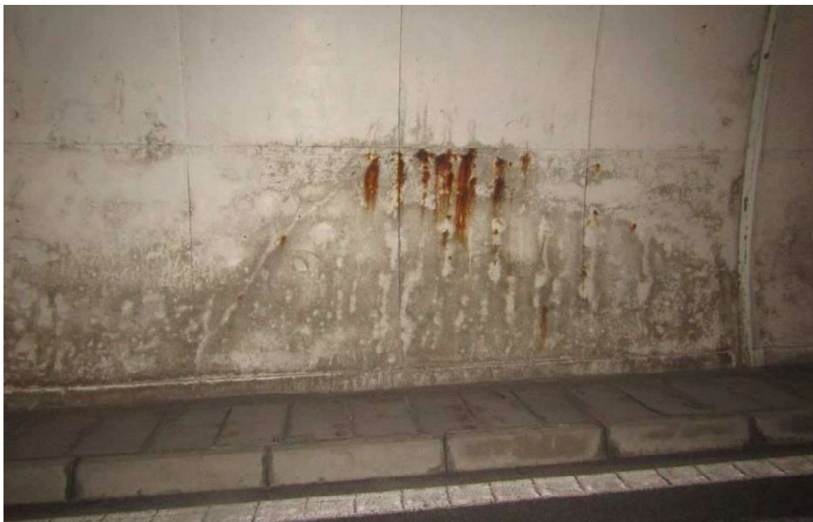
Slika 14: kampada 49 – KOROZIJA ARMATURE, MRLJE OD KOROZIJE
