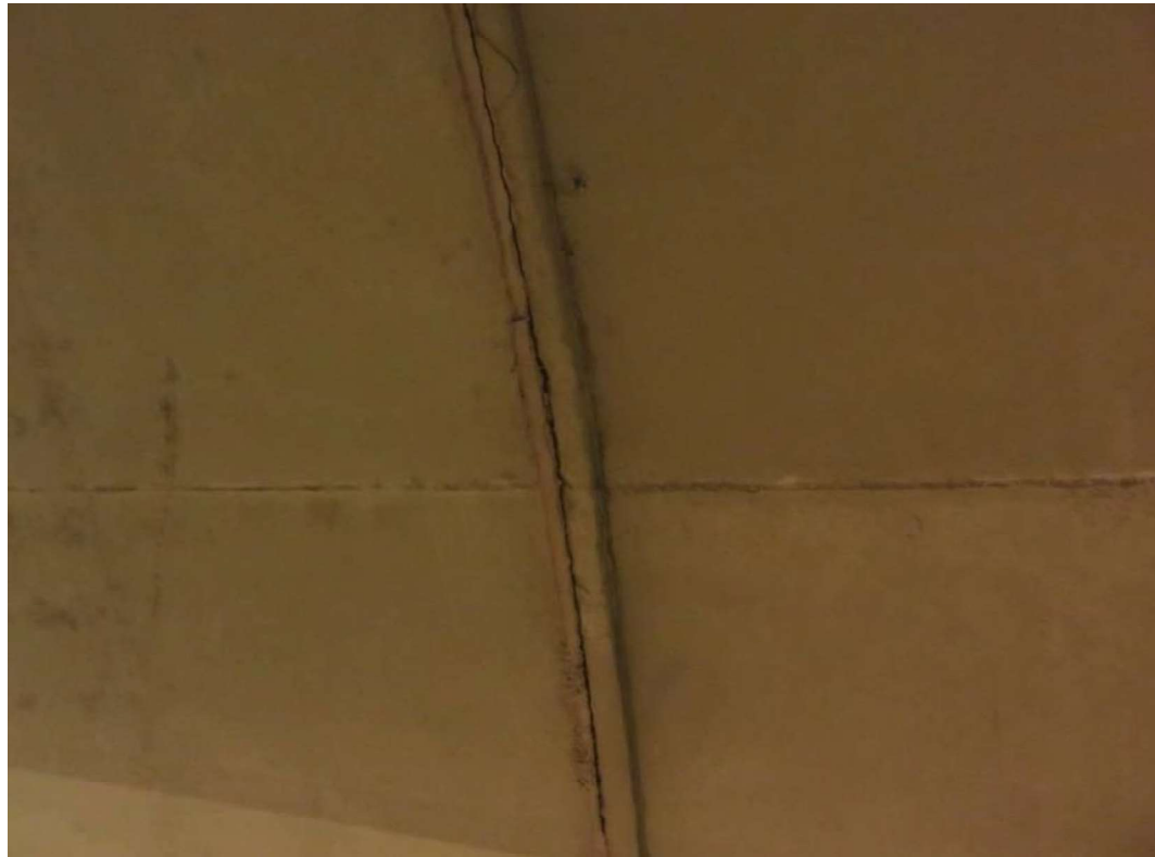
Slika 19: kampada 63 – ODLAMANJE BETONA
