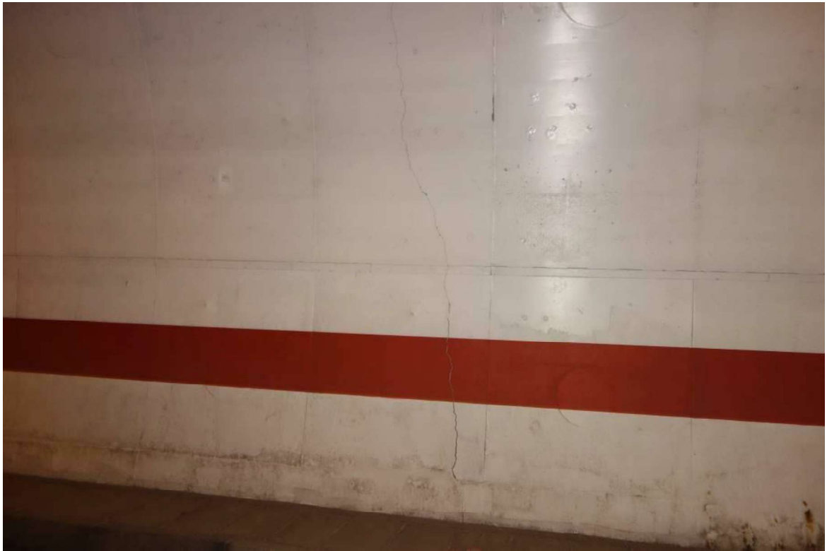
Slika 15: kampada 54 – PUKOTINA < 1mm
