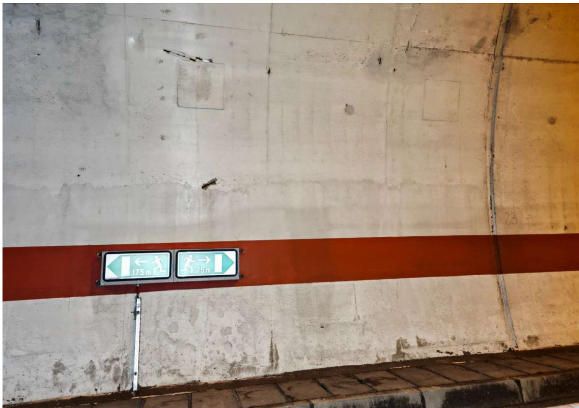
Slika 8: kampada 24 – KOROZIJA ARMATURE, NEDOSTATAK ZAŠTITNOG SLOJA
