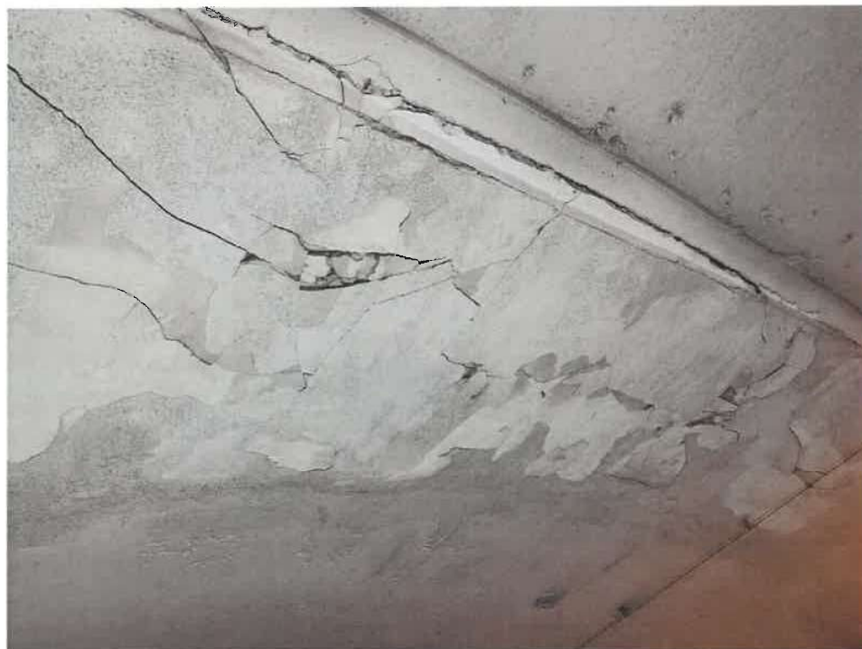
Slika 5. Pogled na kalotu: Mrežaste pukotine i pukotine do 5 mm; ljuštenja i odlamanja betona prethodne sanacije; mrlje od korozije i vidljiva korodirana armatura; vidljivo je izbočenje dijela oštećenog područja kalote kampade 28
