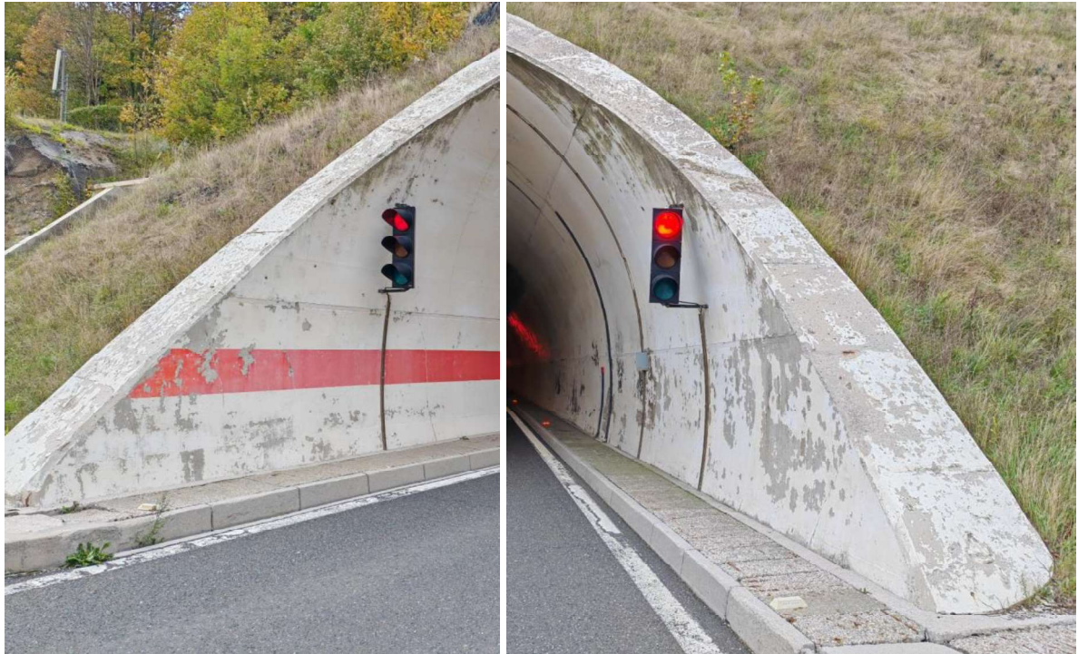
Slika 21: Ulazni portal - LJUŠTENJE PREMAZA BETONA, KORODIRANE PLOČE HODNIKA
