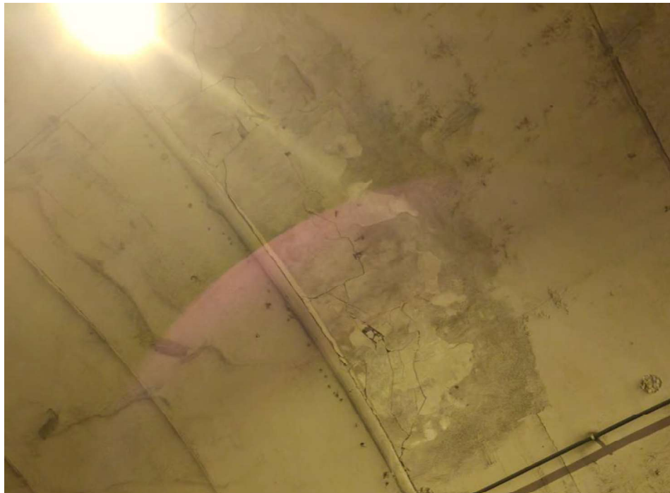
Slika 10: kampada 27 – ISPUCALO MJESTO SANACIJE, MOGUĆE ODLAMANJE
