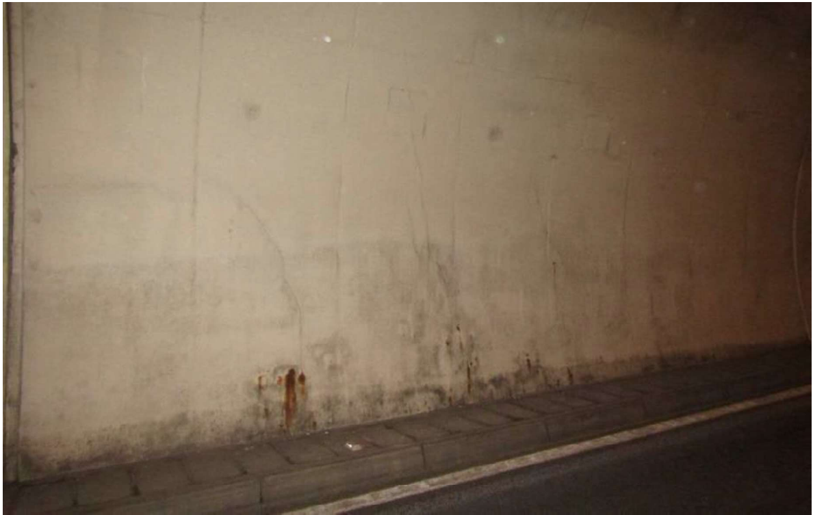
Slika 3: kampada 2 – RADIJALNE PUKOTINE <0,4mm, MRLJA OD KOROZIJE
