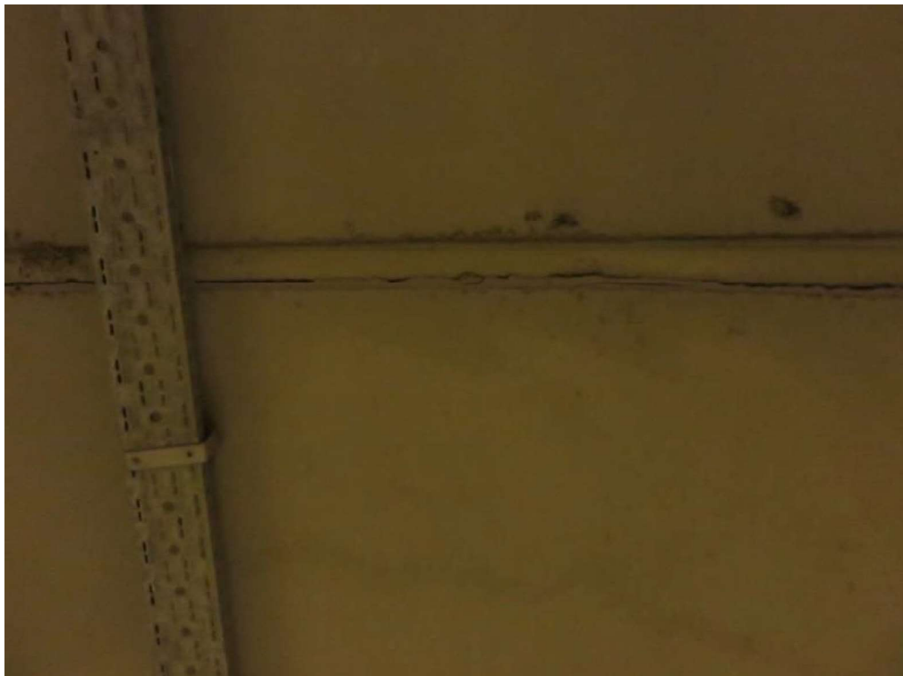
Slika 16: kampada 55 – ODLAMANJE BETONA
