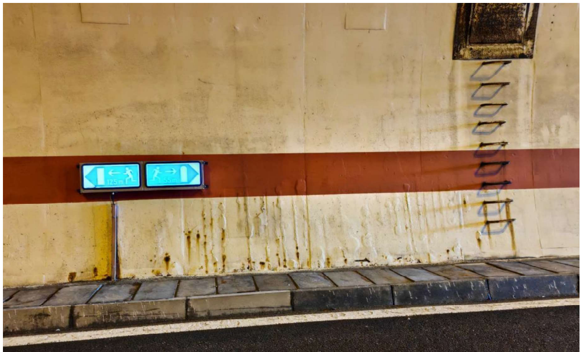
Slika 4: kampada 5 – ARMATURA BEZ ZAŠTITNOG SLOJA, KOROZIJA ARMATURE I LJUŠTENJE BETONA
