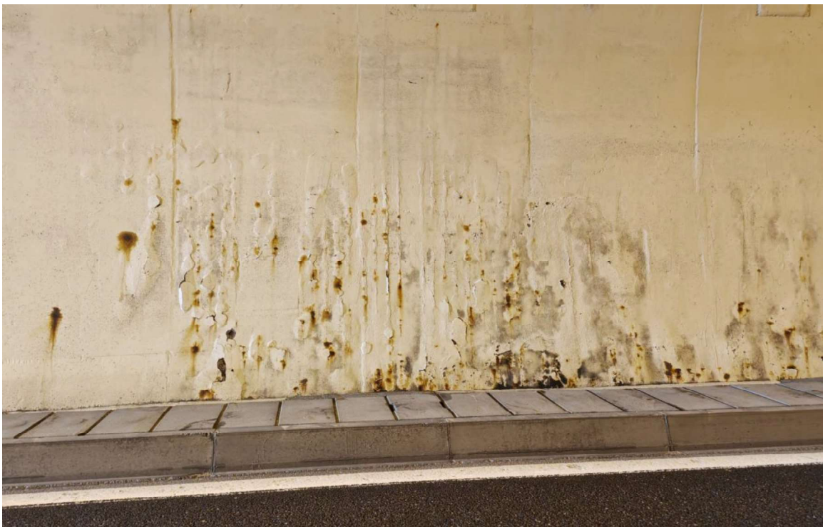
Slika 6: kampada 9 – ARMATURA BEZ ZAŠITNOG SLOJA, KOROZIJA ARMATURE I LJUŠTENJE BETONA
