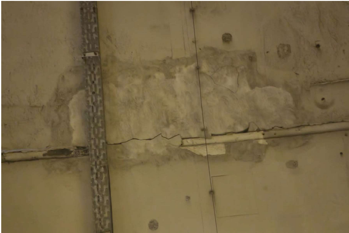
Slika 7: kampada 21 – LJUŠTENJE BETONA SANIRANOG MJESTA NA SPOJNICI SVODA
