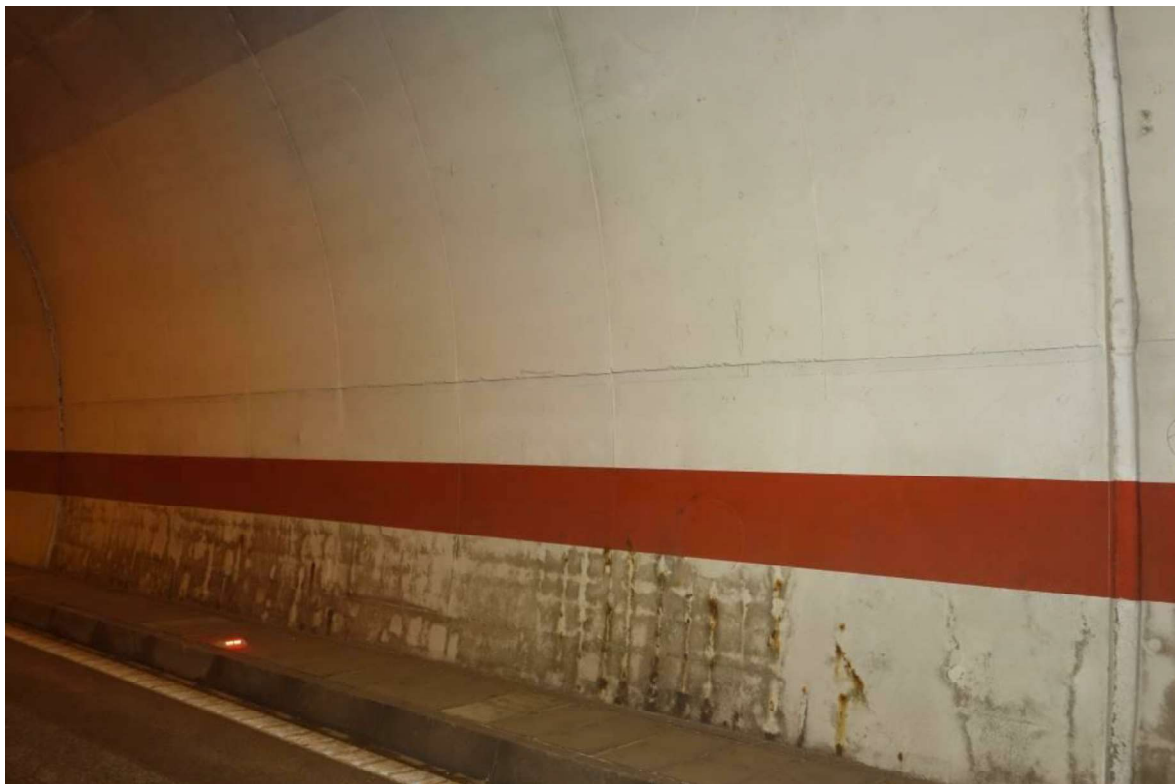
Slika 18: kampada 62 – KOROZIJA ARMATURE, MRLJE OD KOROZIJE
