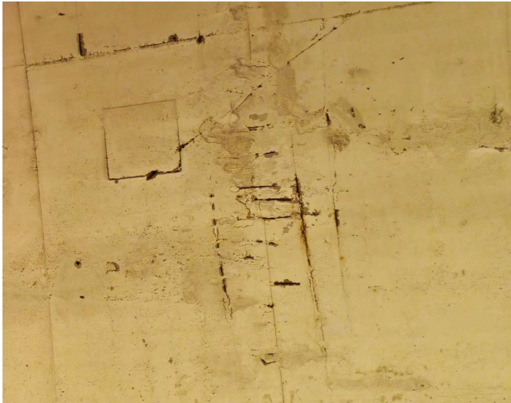
Slika 9: kampada 25 - KOROZIJA IZLOŽENE ARMATURA, LJUŠTENJE BETONA
