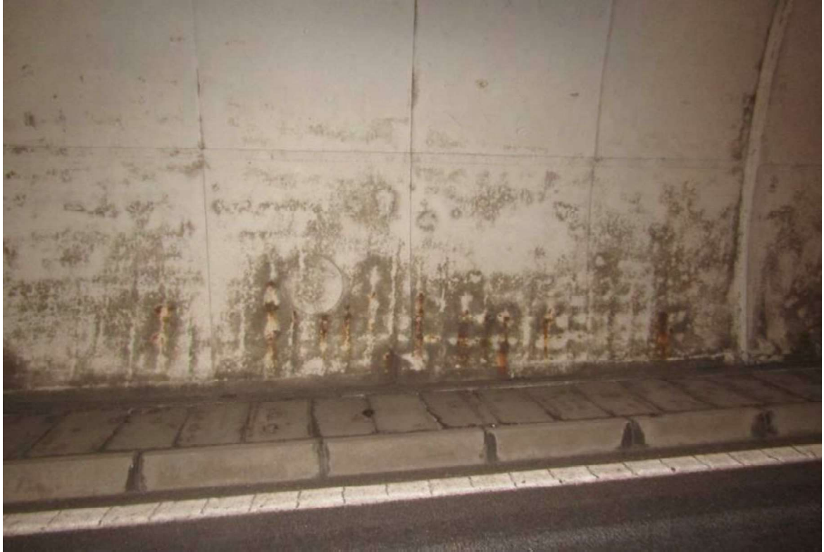
Slika 17: kampada 62 – KOROZIJA ARMATURE, MRLJE OD KOROZIJE
