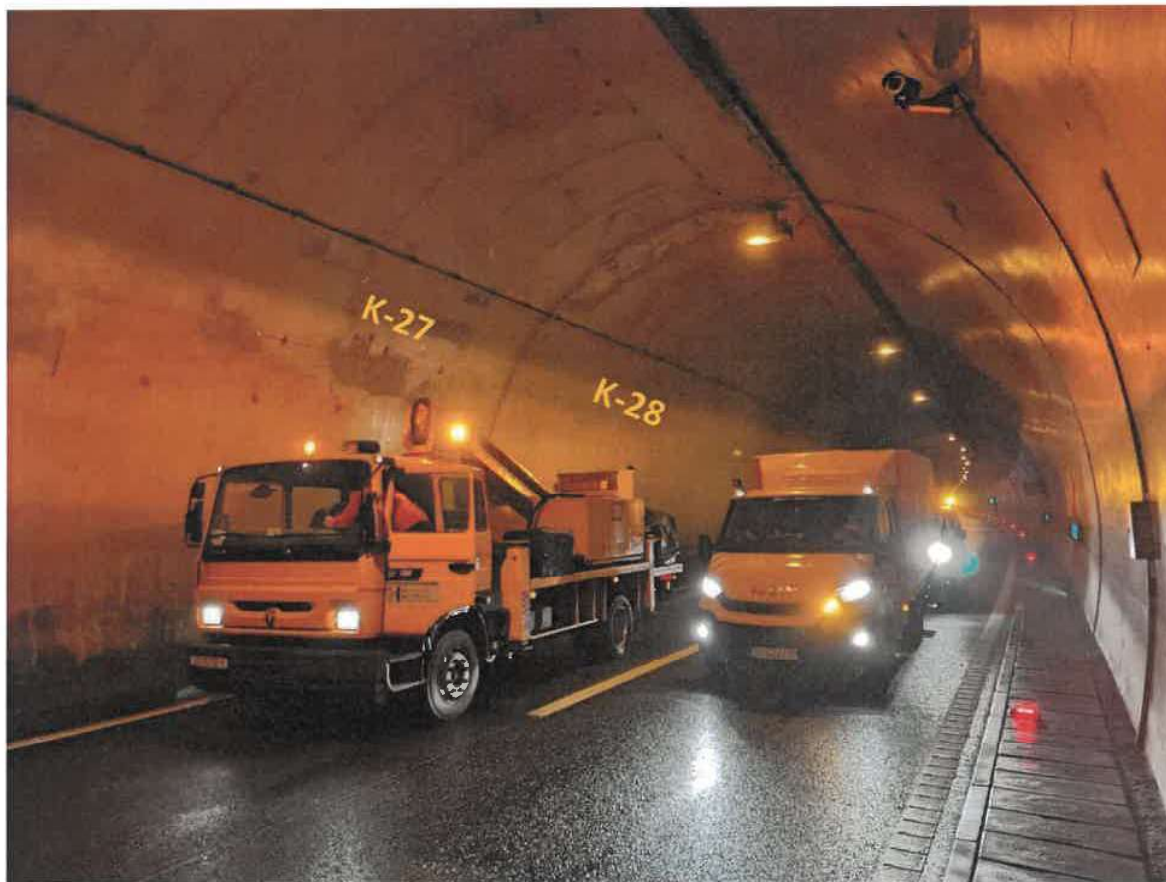
Slika 3. Pogled na lijevu tunelsku cijev u smjeru rasta stacionaže; vidljivo područje oštećenja na lijevoj strani kalote, kampada 28
