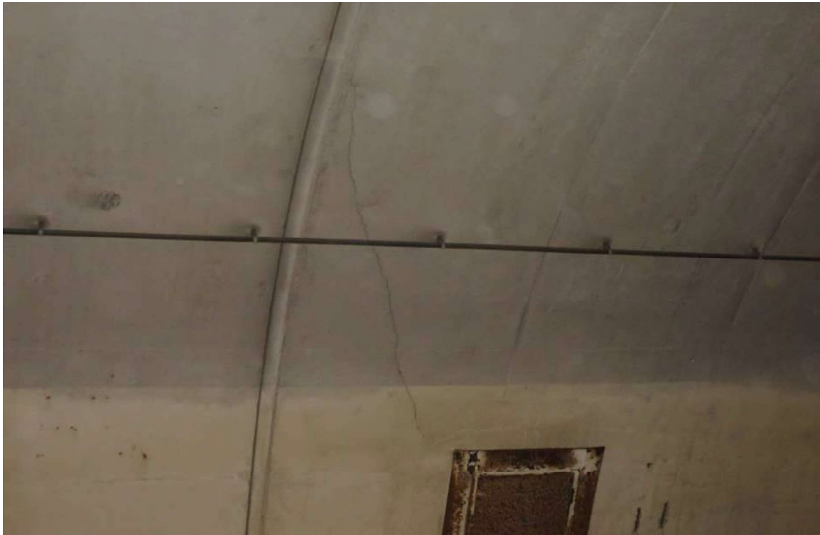
Slika 5: kampada 5 – DIJAGONALNA PUKOTINA < 1mm
