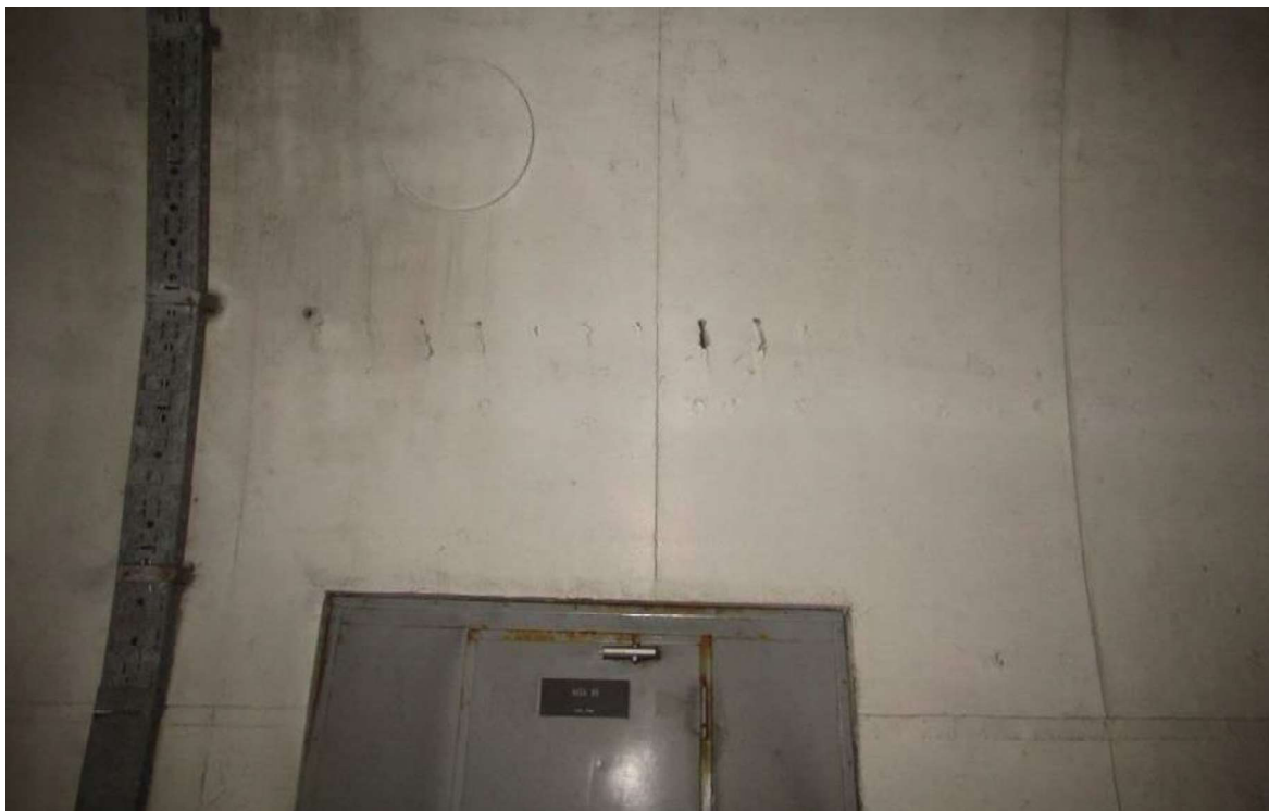
Slika 13: kampada 41 – KOROZIJA ARMATURE, LJUŠTENJE BETONA
