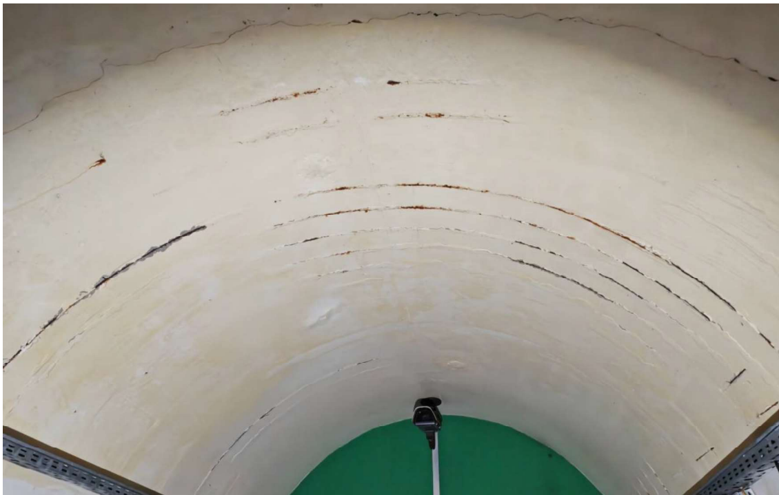
Slika 7: pješački prolaz 1 - KOROZIJA IZLOŽENE ARMATURA, LJUŠTENJE BETONA SVODA
