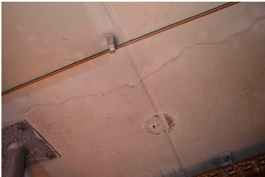
Slika 9: kampada 17 – VERTIKALNA PUKOTINA NA KALOTI
