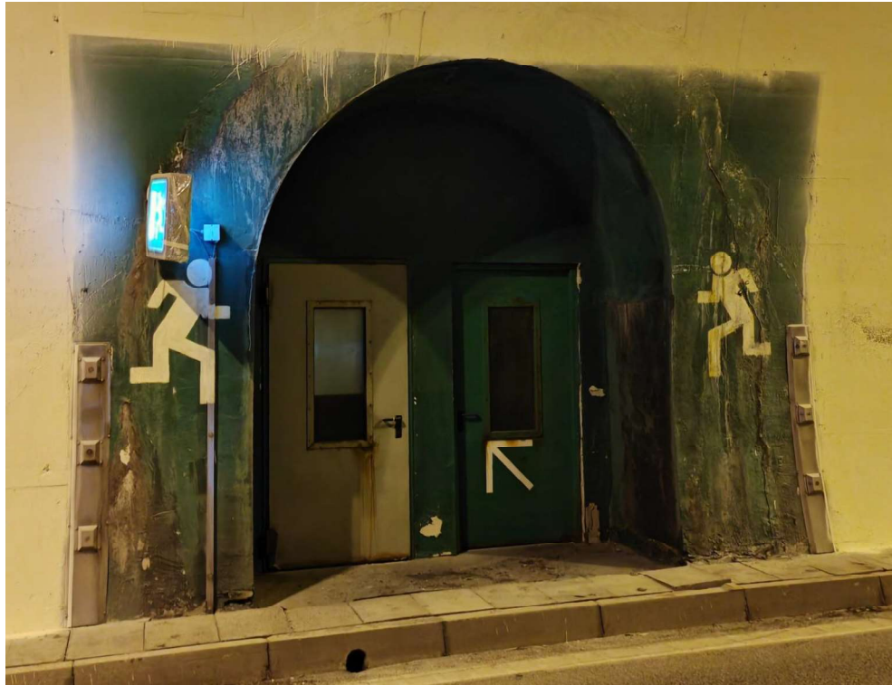
Slika 6: pješački prolaz 1 – pukotina sa luženjem spoja tunelske obloge i obloge pješačkog prolaza
