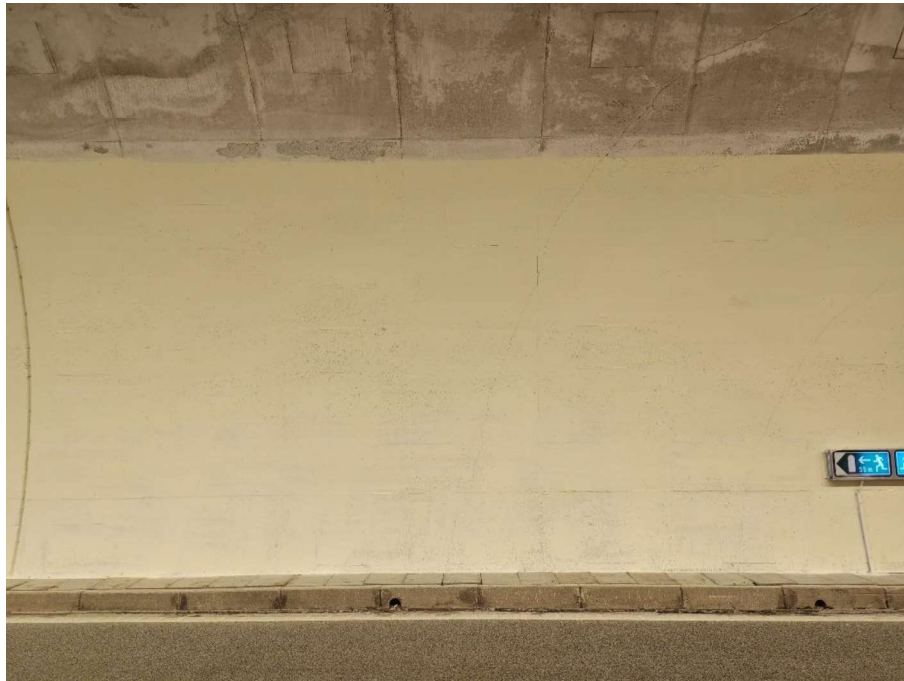
Slika 4: kampada 2 – RADIJALNA PUKOTINA NA DESNOM BOKU
