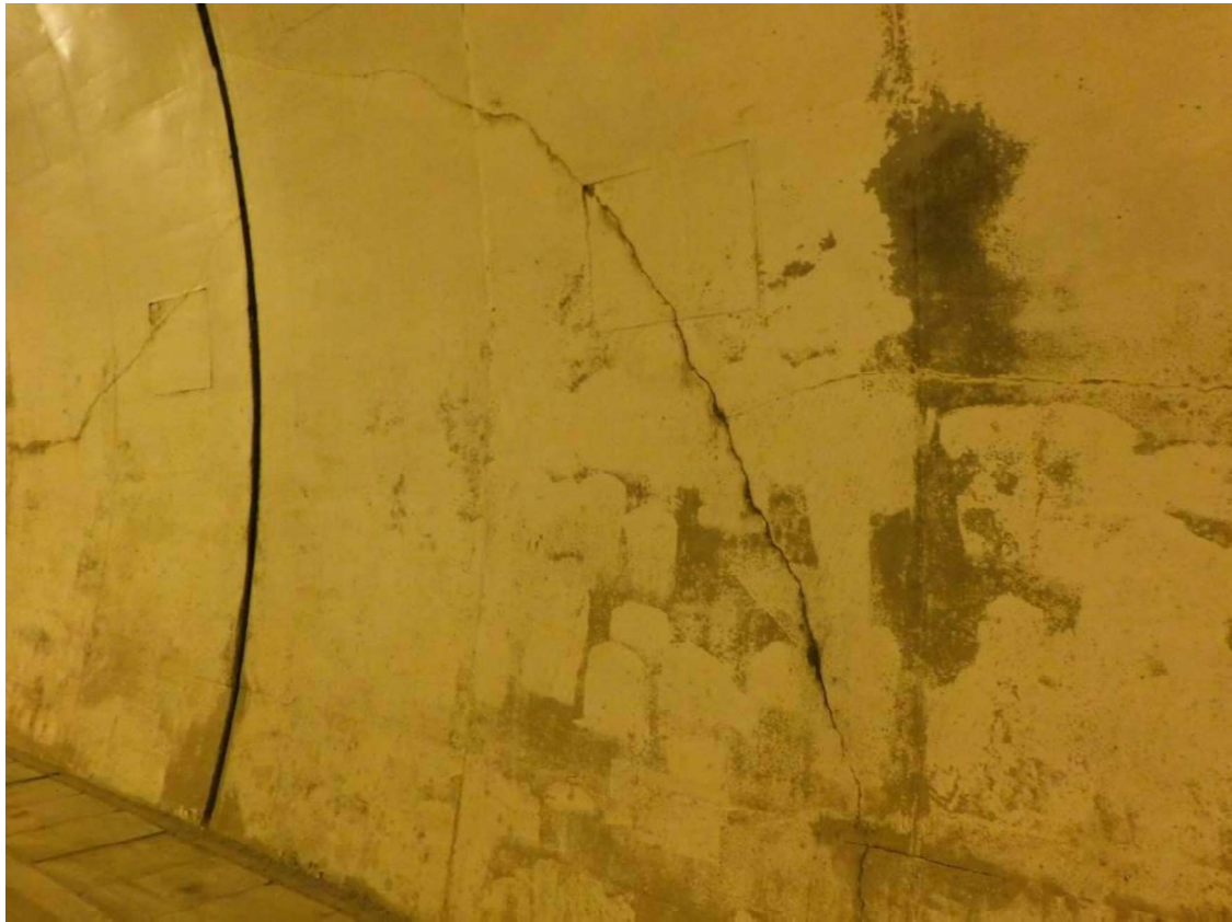
Slika 8: kampada 16 – DIJAGONALNA PUKOTINA NA DESNOM BOKU
