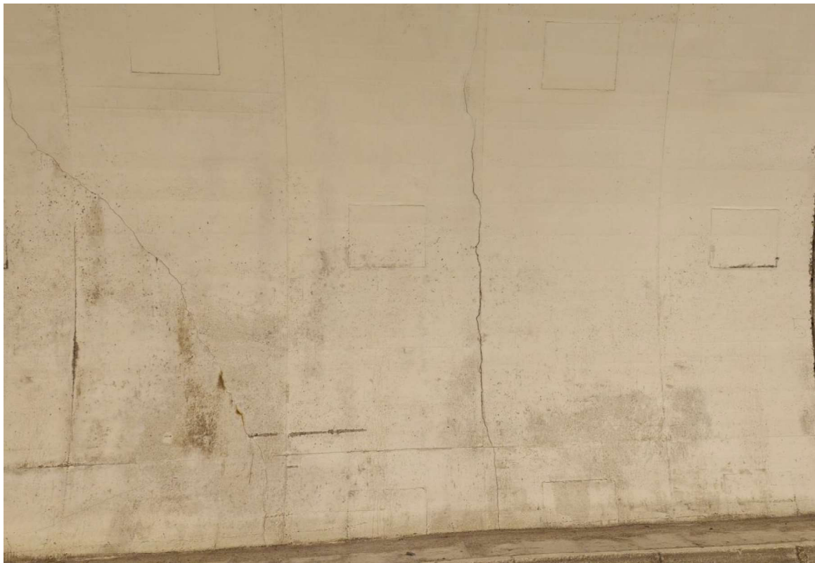
Slika 3: kampada 5 - LJUŠTENJE PREMAZA BETONA I RADIJALNA PUKOTINA
