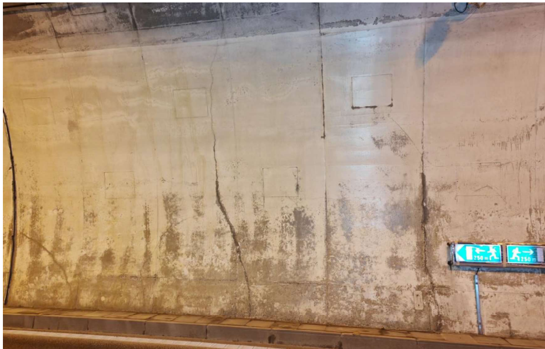
Slika 11: kampada 38 – RADIJALNE PUKOTINE NA DESNOM BOKU
