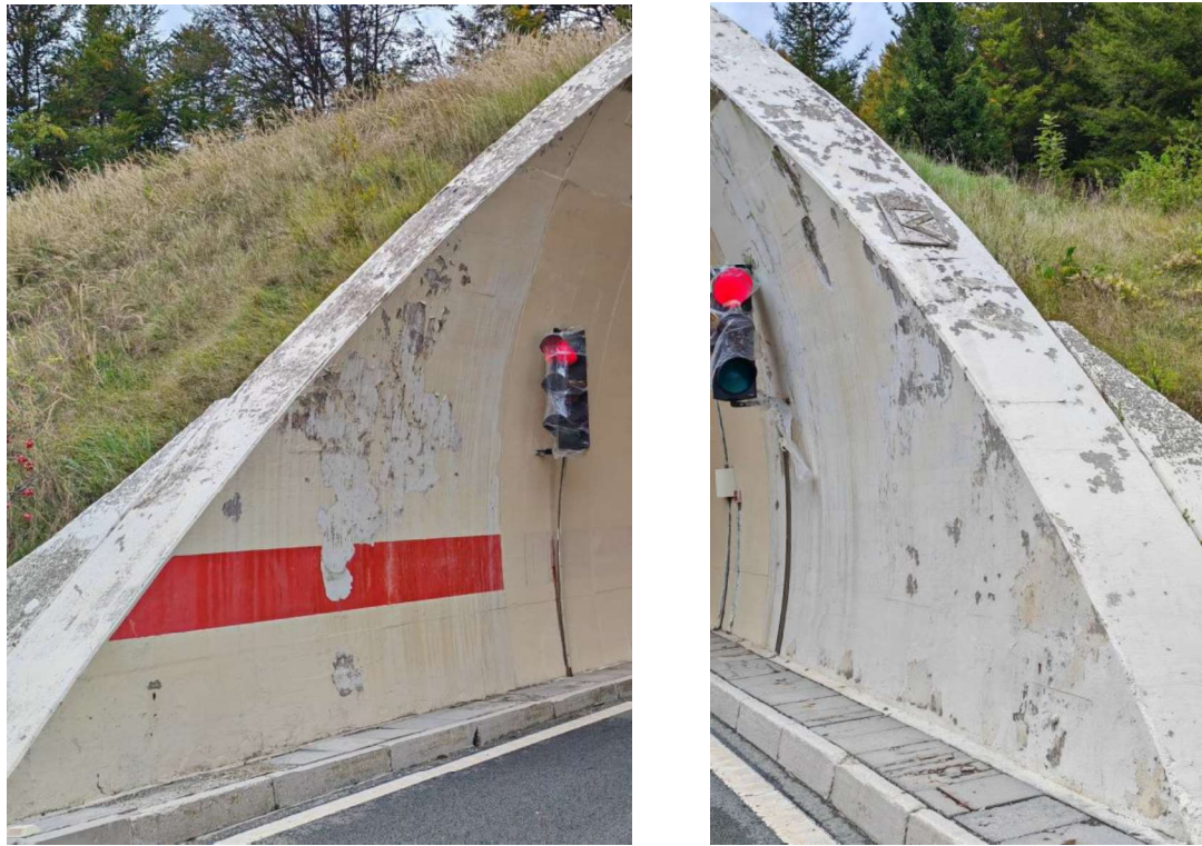
Slika 1: Ulazni portal - LJUŠTENJE PREMAZA BETONA
