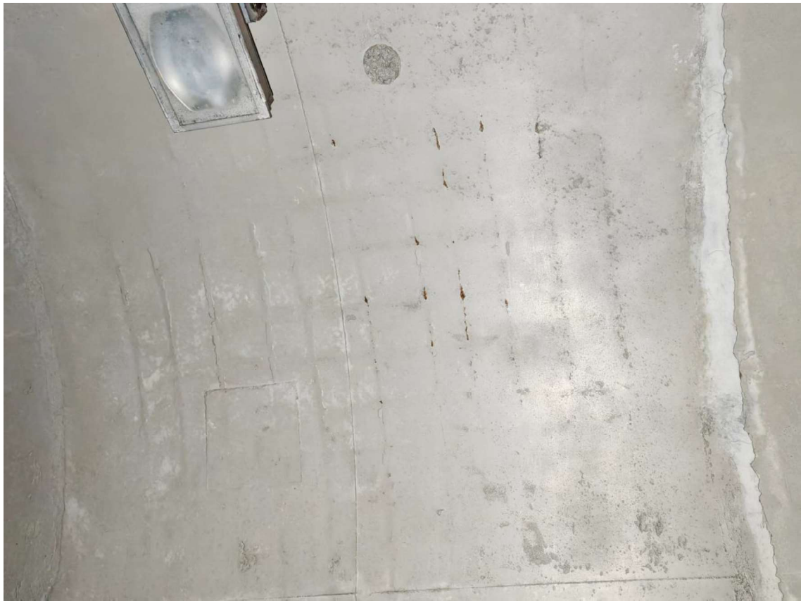
Slika 10: pješački prolaz 2/ prolaz za vozila – KOROZIJA IZLOŽENE ARMATURA
