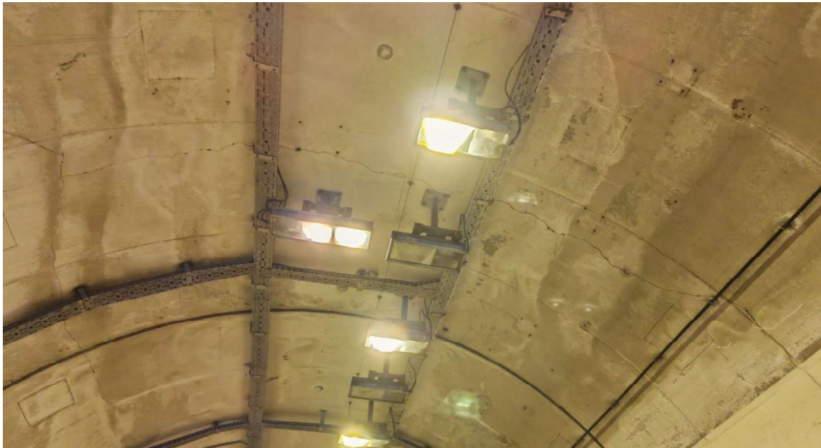
Slika 4: kampada 5 – RADIJALNA I UZDUŽNA PUKOTINA SVODA
