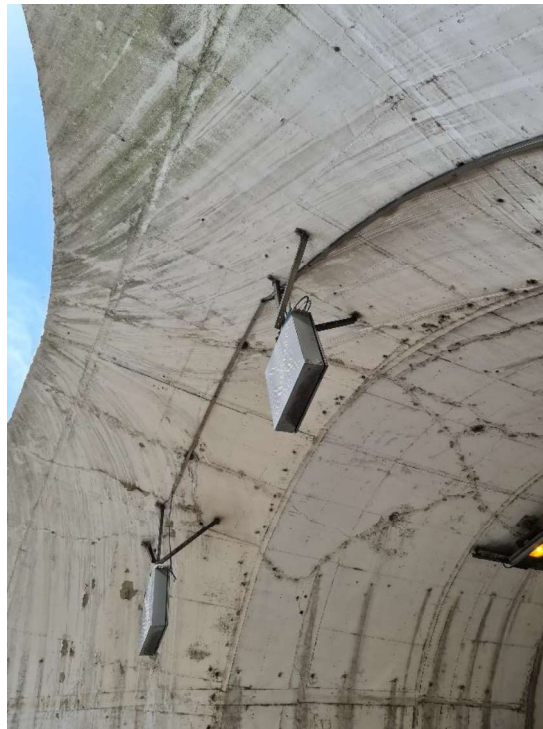
Slika 2: Uzdužne pukotine i ljuštenje premaza betona na izlaznom portalu
