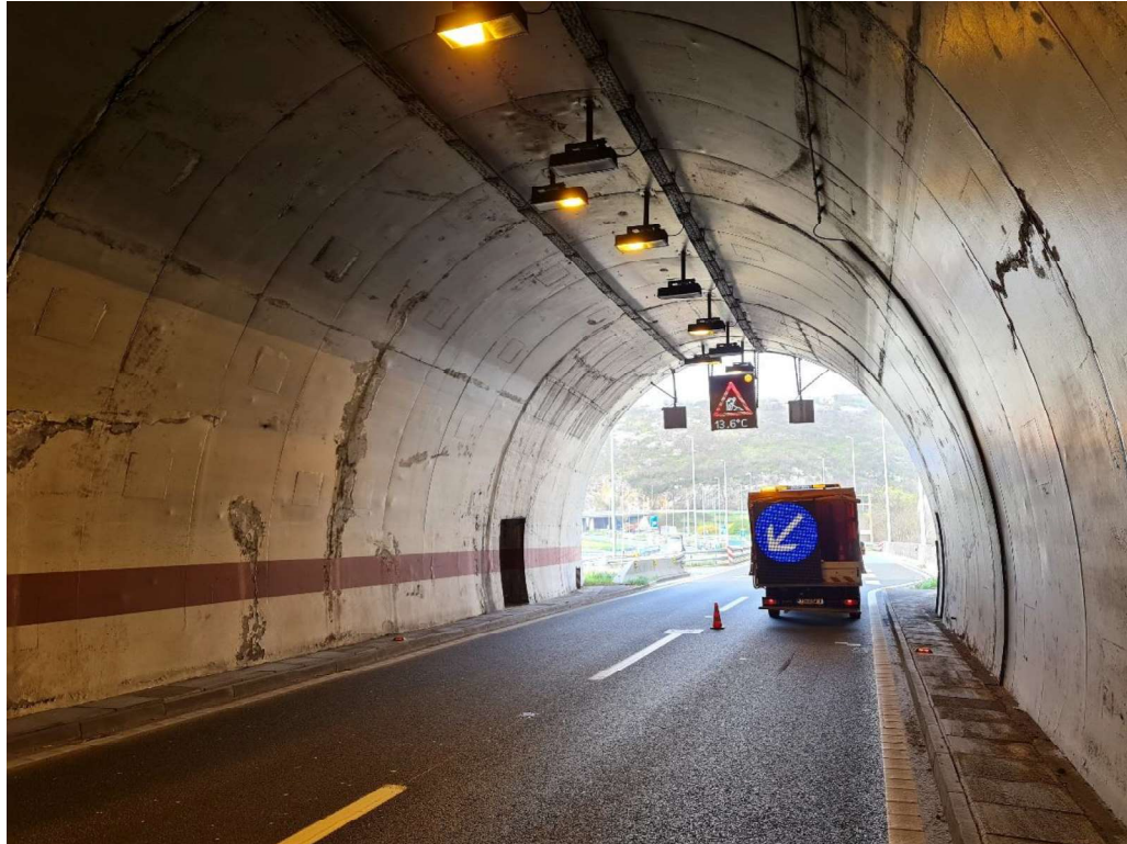
Slika 10: Odlamanje betona na dilatacijskoj rešci
