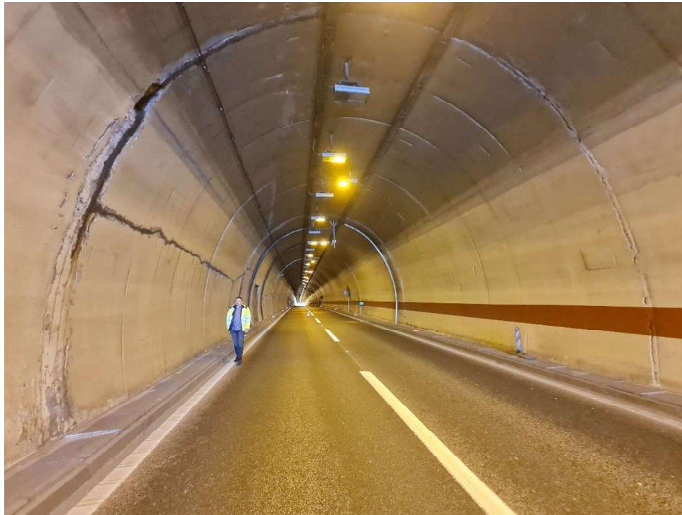
Slika 5: Procurivanje vode na dilatacijskoj rešci, stacionaža 24+400 km, šupljina u rešci
