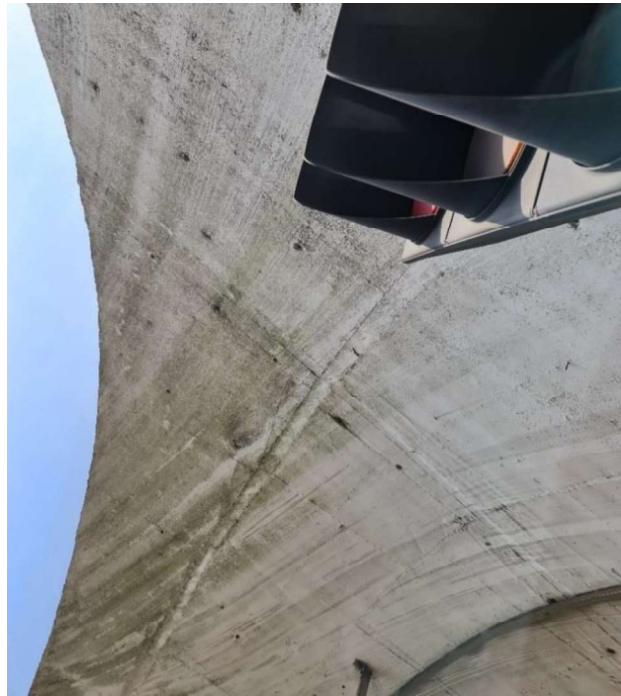
Slika 1: Ljuštenje premaza betona (izlazni portal)
