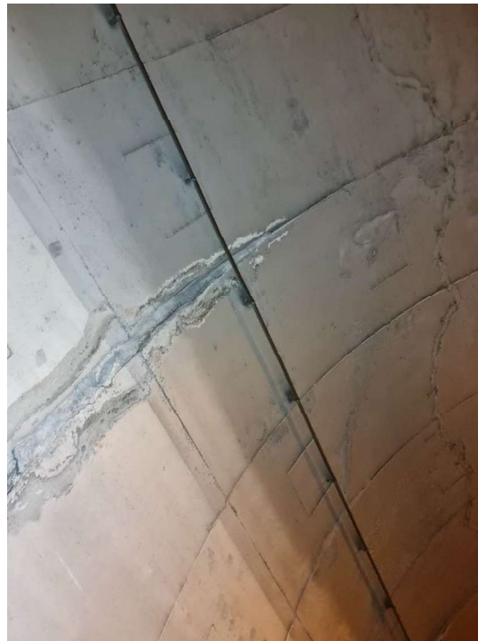
Slika 4: Procurivanje na dilatacijskoj rešci, stacionaža 24+250 km
