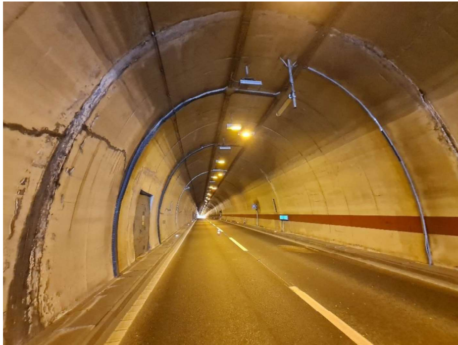
Slika 7: Procurivanje vode na dilatacijskoj rešci, stacionaža 24+460 km
