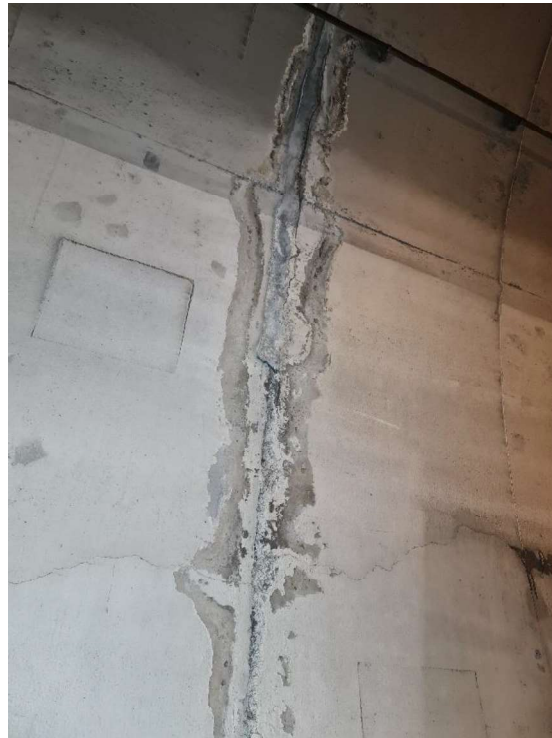
Slika 3: Procurivanje na dilatacijskoj rešci, stacionaža 24+250 km
