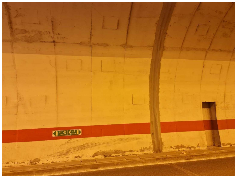
Slika 12: Oštećenje završnog premaza
