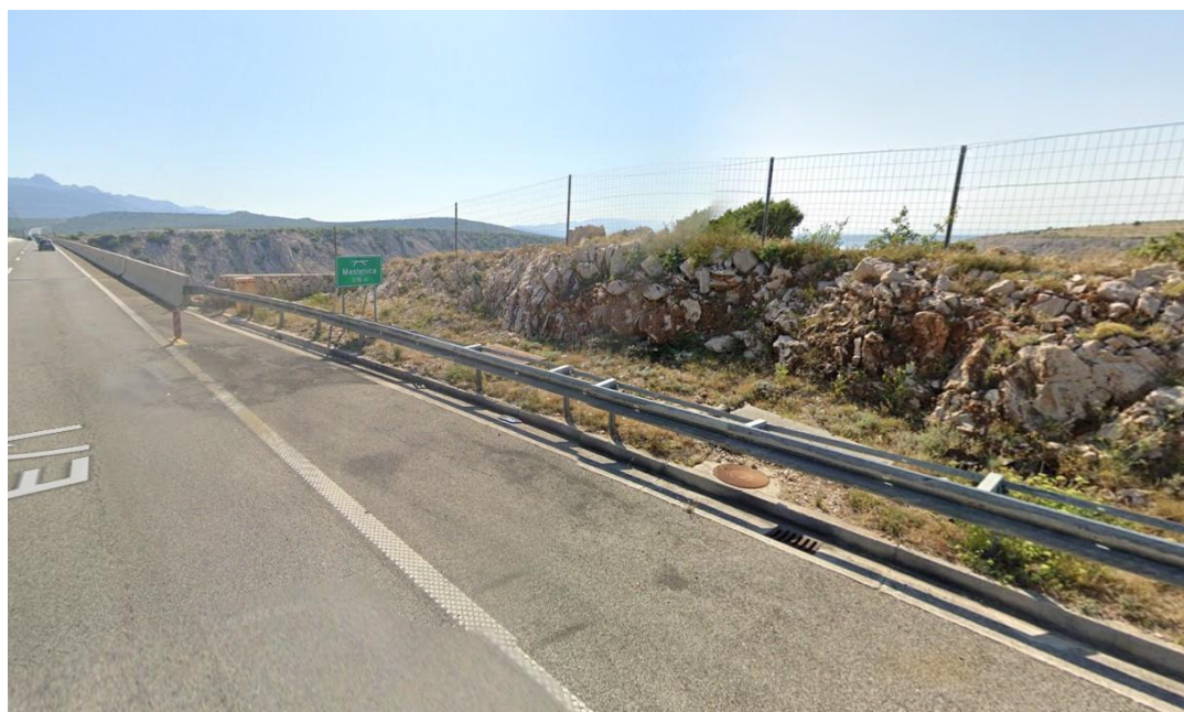
Slika 2. Prikaz neodgovarajuće zaštićene betonske ograde na mostu
