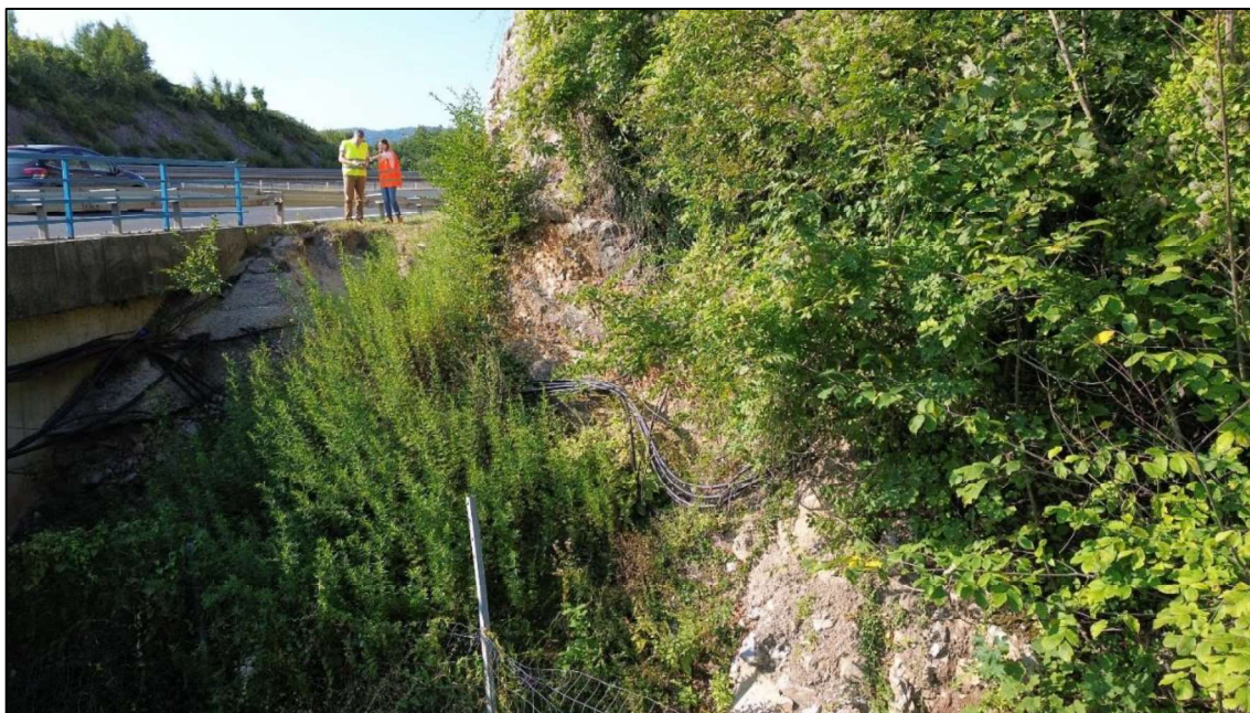
Slika 2. Pogled na erodiranu kosinu i vidljive kabelske instalacije (2)
