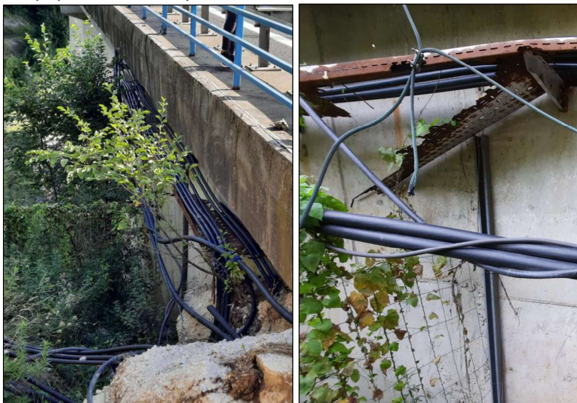
Slika 10. Oštećene kablovske police i nezaštićeni kablovi
