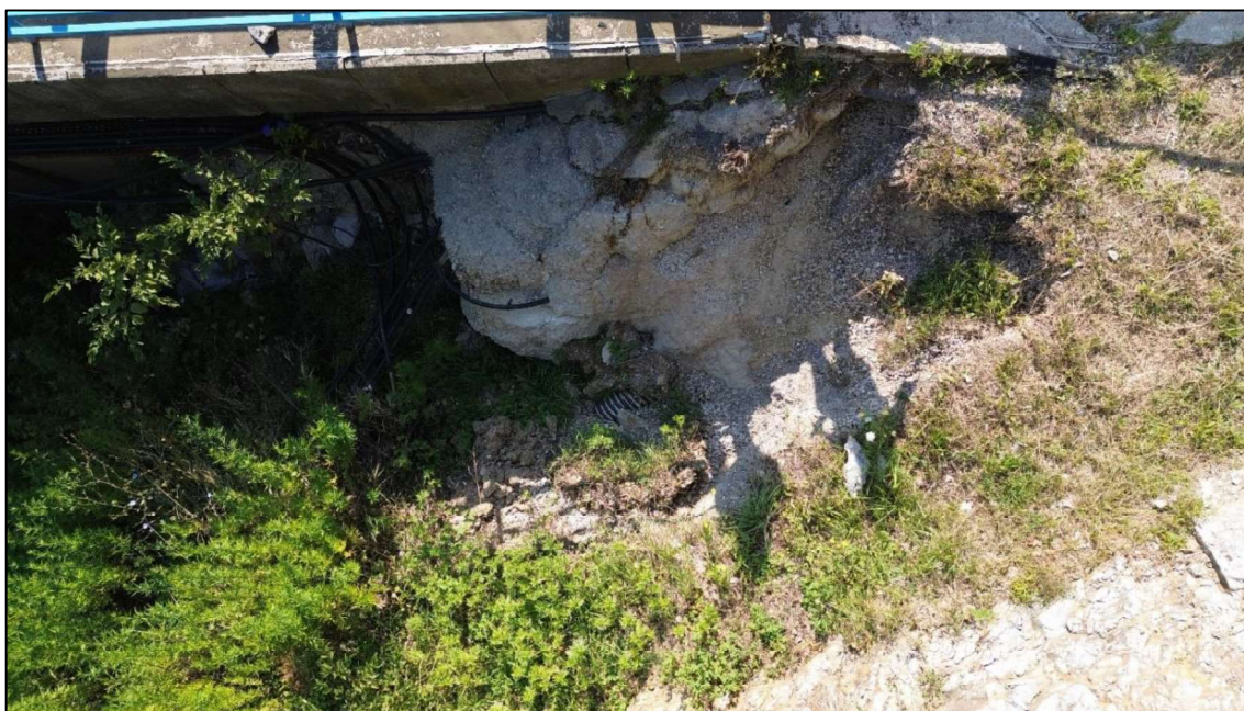
Slika 3. Pogled na erodiranu kosinu i vidljive kabelske instalacije (3)
