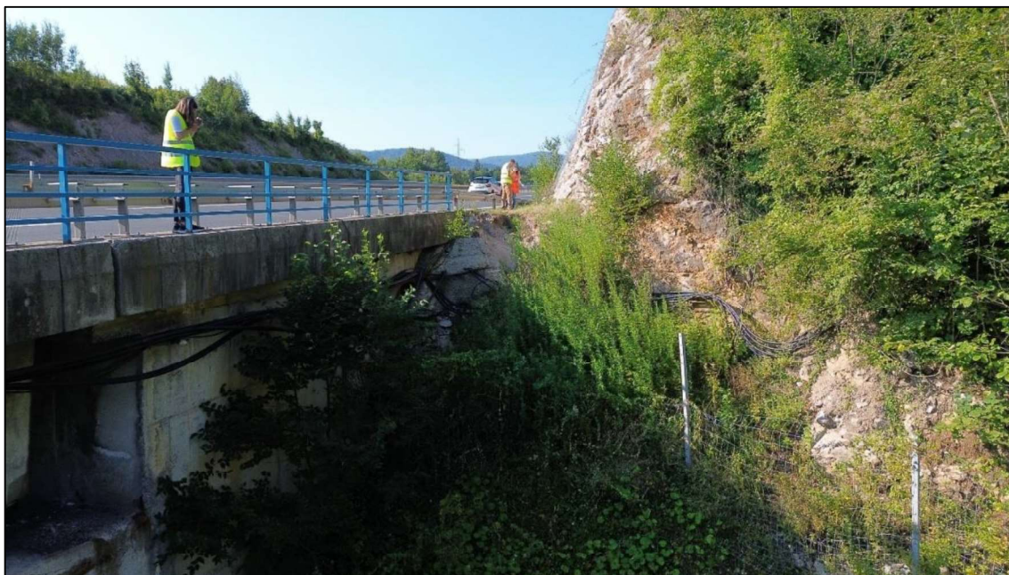
Slika 1. Pogled na erodiranu kosinu i vidljive kableske instalacije (1)
