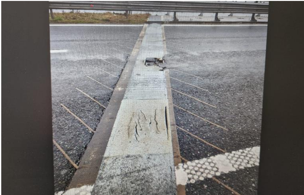
Slika 5_Prikat karakterističnih oštećenja prijelazne naprave
