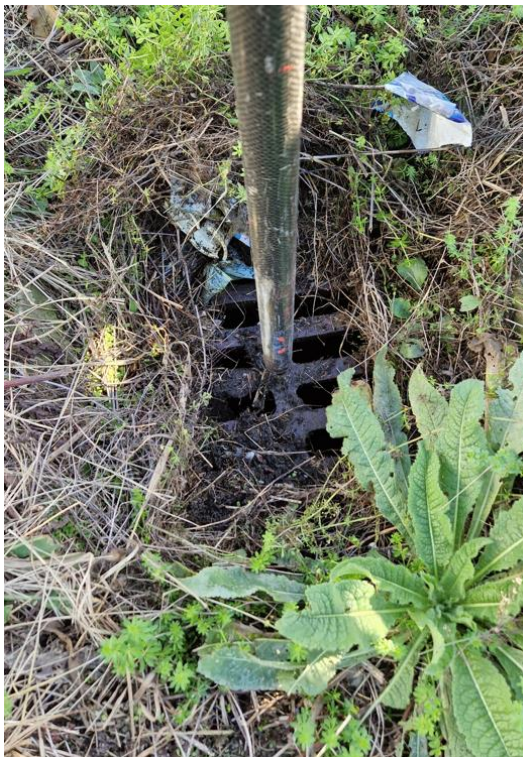
Slika 4. Postojeći slivnik u središnjem razdjelnom pojasu
