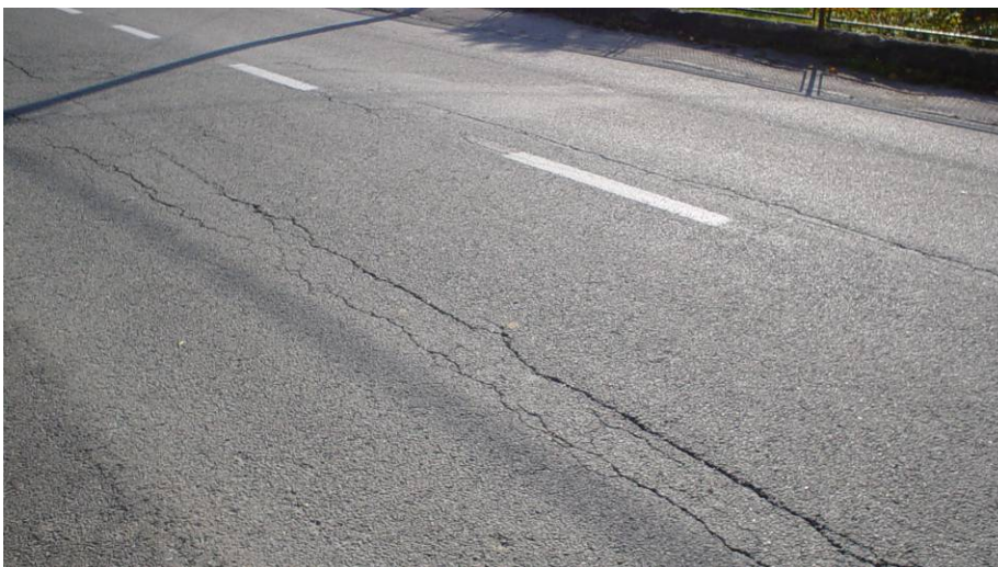
Slika 1.1.4.1.4 Uzdužna pukotina, visok stupanj oštećenja
