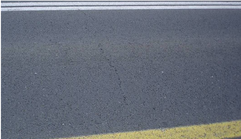
Slika 1.1.3.1.2 Poprečna pukotina, nizak stupanj oštećenja
