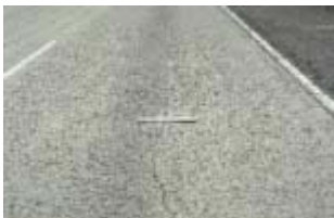
Slika 1.2.1.2.2 Uzdužne pukotine, nizak stupanj oštećenja
