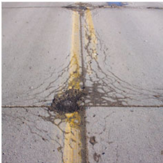
Slika 1.2.2.1.3 D-pukotine, visok stupanj oštećenja i odlamanje
