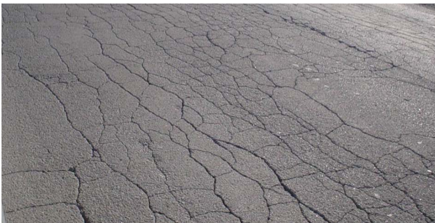
Slika 1.1.1.1.4 Mrežaste pukotine, visok stupanj oštećenja
