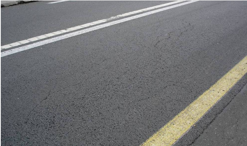
Slika 1.1.1.1.2 Mrežaste pukotine, nizak stupanj oštećenja
