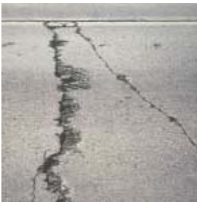
Slika 1.2.1.3.4 Poprečne pukotine, visok stupanj oštećenja i odlamanje
