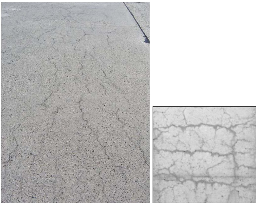
Slika 1.2.1.1.1 Mrežaste pukotine na betonskoj ploči
