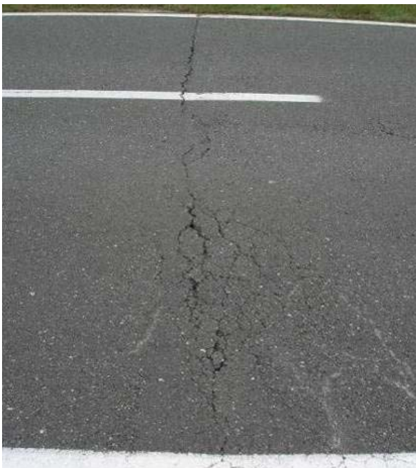
Slika 1.1.3.1.4 Poprečna pukotina, razgranata, visok stupanj oštećenja
