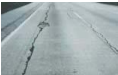
Slika 1.2.1.2.4 Uzdužne pukotine, visok stupanj oštećenja i odlamanje
