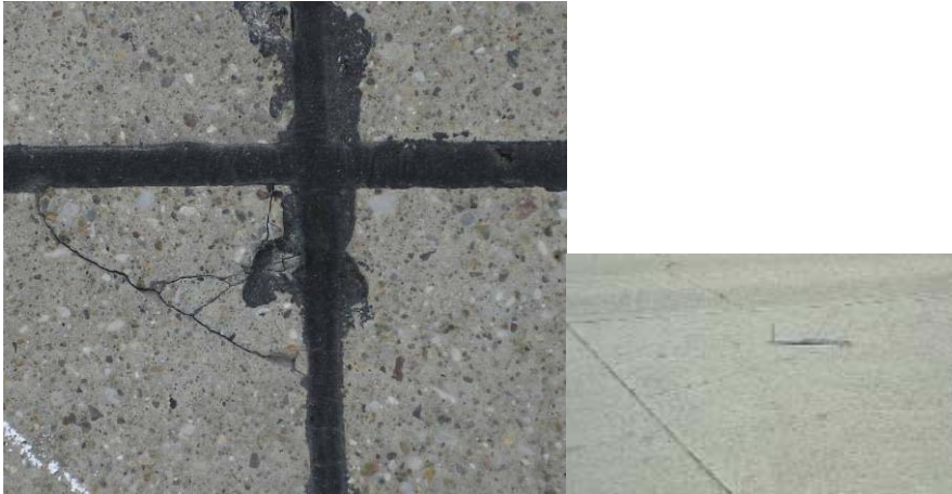
Slika 1.2.2.2.2 Dijagonalna pukotina, nizak stupanj oštećenja
