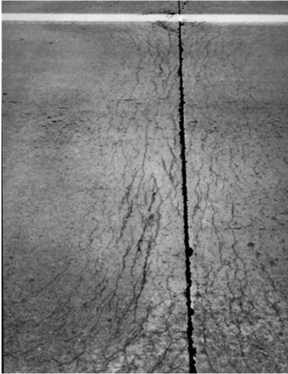
Slika 1.2.2.1.2 D-pukotine, visok stupanj oštećenja
