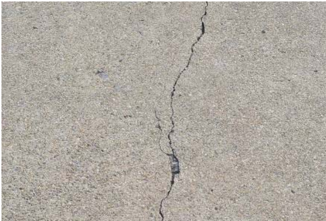
Slika 1.2.1.3.3 Poprečne pukotine, umjeren stupanj oštećenja i odlamanje
