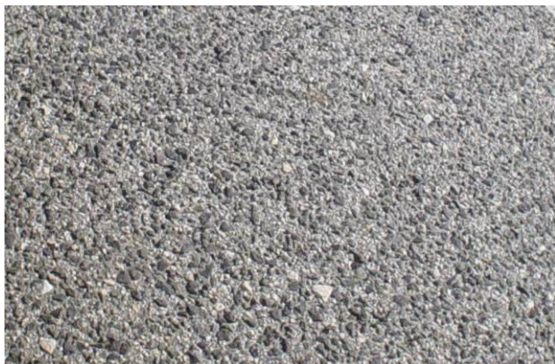
Slika 2.1.2.1.1 Krunjenje, nizak stupanj oštećenja
