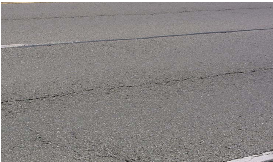
Slika 1.1.4.1.3 Uzdužna pukotina, umjeren stupanj oštećenja
