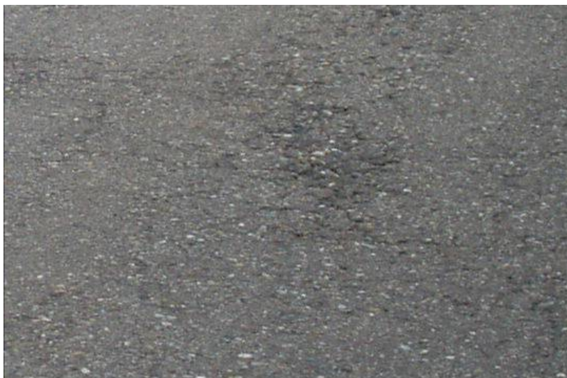
Slika 2.1.2.1.2 Krunjenje, umjeren stupanj oštećenja
