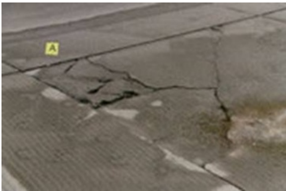
Slika 1.2.2.2.4 Dijagonalna pukotina, visok stupanj oštećenja
