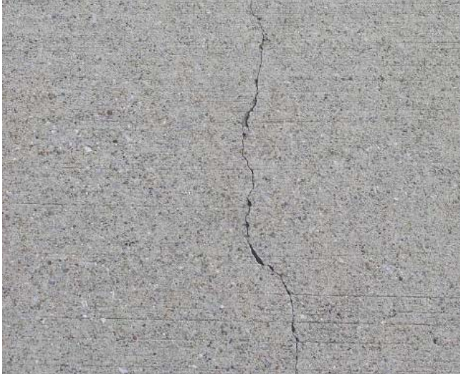
Slika 1.2.1.3.2 Poprečne pukotine, nizak stupanj oštećenja
