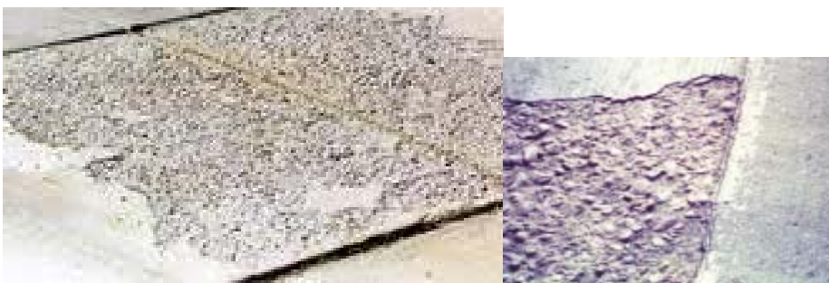
Slika 2.2.1.1.2 Odlamanje završnog sloja betona, umjeren stupanj oštećenja
