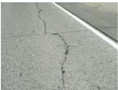
Slika 1.2.1.2.3 Uzdužne pukotine, umjeren stupanj oštećenja i odlamanje
