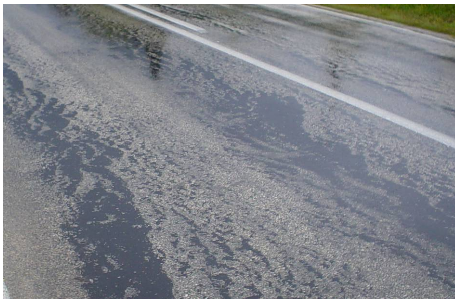
Slika 2.1.1.1.1 Izbijanje bitumenskog veziva, visok stupanj oštećenja
