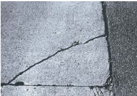
Slika 1.2.2.2.3 Dijagonalna pukotina, umjeren stupanj oštećenja
