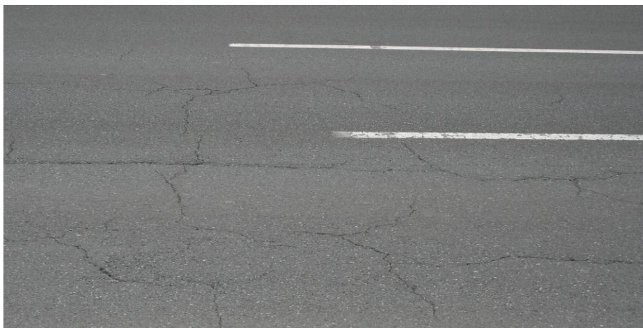
Slika 1.1.2.1.2 Blok pukotine, nizak stupanj oštećenja
