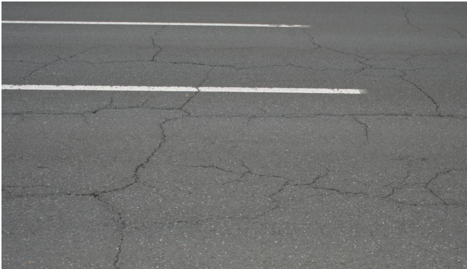
Slika 1.1.2.1.3 Blok pukotine, umjeren stupanj oštećenja
