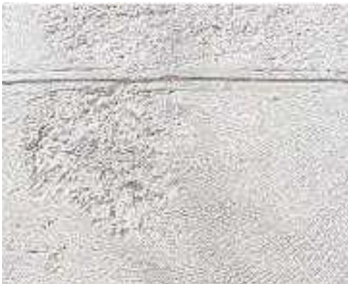
Slika 2.2.1.1.1 Odlamanje završnog sloja betona, nizak stupanj oštećenja
