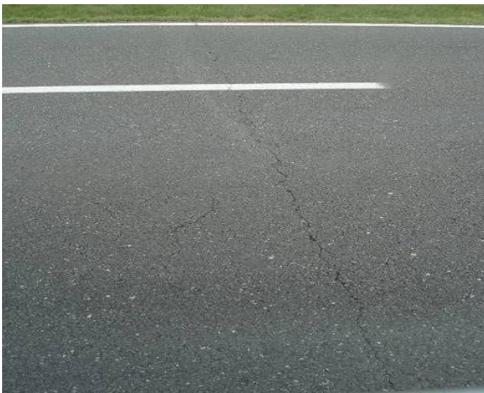
Slika 1.1.3.1.3 Poprečna pukotina, umjeren stupanj oštećenja
