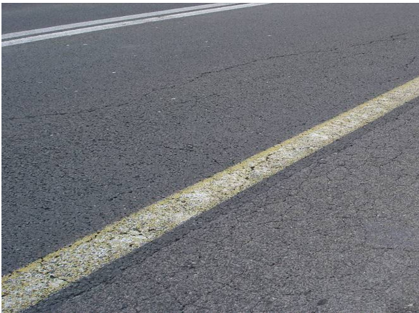
Slika 1.1.1.1.3 Mrežaste pukotine, umjeren stupanj oštećenja
