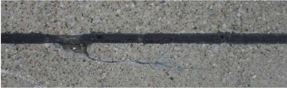
Slika 2.2.2.2.2 Odlamanje u razdjelnici, nizak stupanj oštećenja
