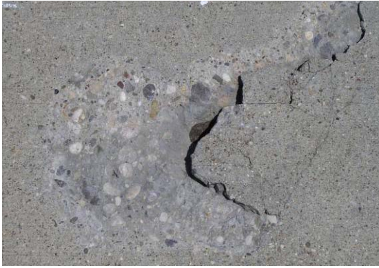
Slika 2.2.1.1.3 Odlamanje završnog sloja, visok stupanj oštećenja
