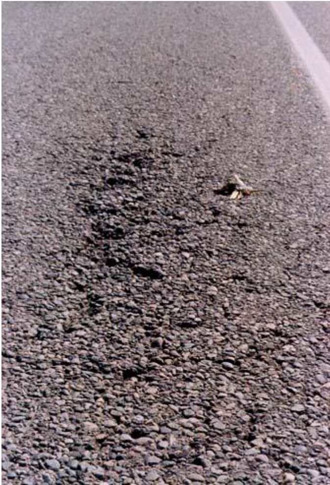
Slika 2.1.2.1.3 Krunjenje, visok stupanj oštećenja
