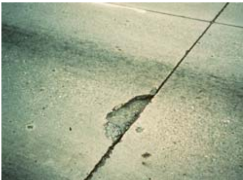
Slika 2.2.2.2.4 Odlamanje u razdjelnici, visok stupanj oštećenja
