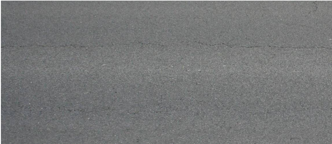
Slika 1.1.4.1.2 Uzdužna pukotina, nizak stupanj oštećenja
