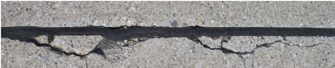
Slika 2.2.2.2.3 Odlamanje u razdjelnici, umjeren stupanj oštećenja
