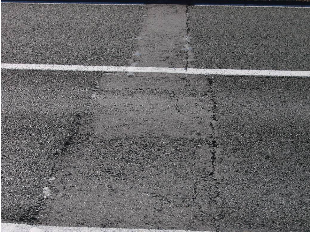
Slika 2.1.3.1.4 Popravak, visok stupanj oštećenja
