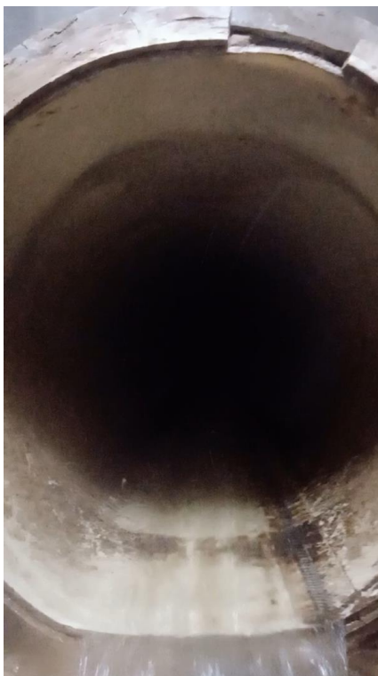
Slika 10 Dovodna cijev DN 700 mm
