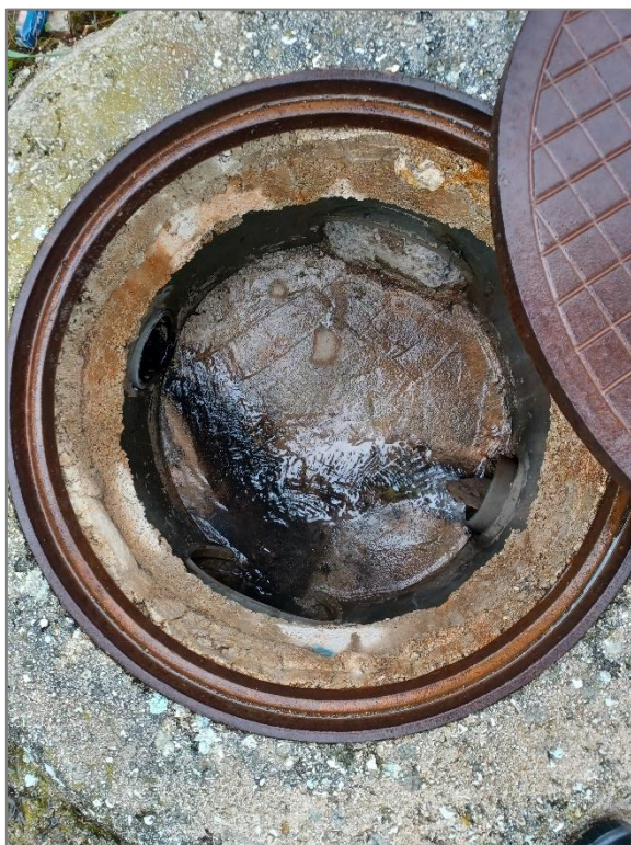
Slika 13 Početno okno cjevovoda DN 300 mm na kojemu je potrebno ugraditi poklopac sa zapornim učvršćenjem
