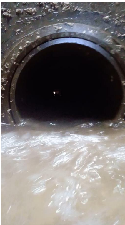
Slika 8 Dovodna cijev DN 300 mm
