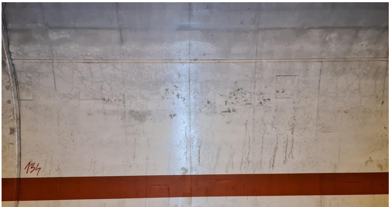
Slika 17: Kampada 134 - MREŽASTE PUKOTINE
