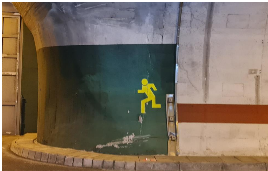
Slika 21: Kampada 91 - RADIJALNA PUKOTINA, MEHANIČKO OŠTEĆENJE OBLOGE
