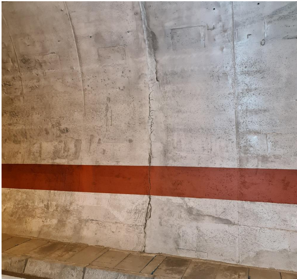
Slika 26: Kampada 39 - RADIJALNA/ MREŽASTA PUKOTINA SPOJNICE SA VLAŽENJEM
