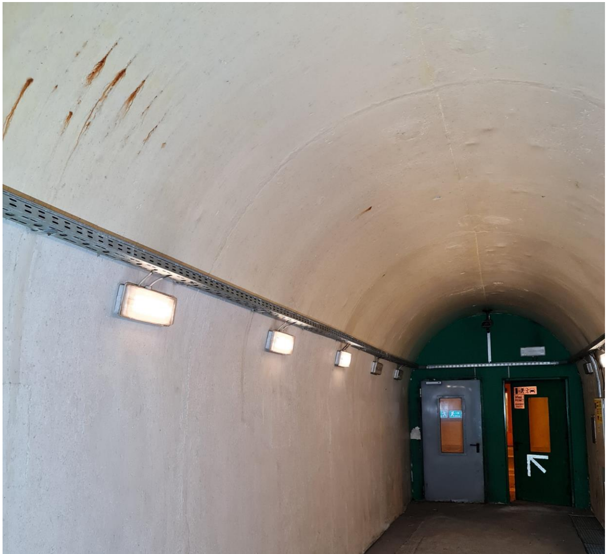
Slika 11: Pješački prolaz - KOROZIJA ARMATURE, NEDOSTATAK ZAŠITNOG SLOJA
