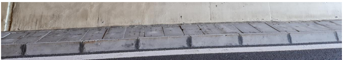
Slika 34: Kampada 2 - KOROZIJA ARMATURE AB PLOČA HODNIKA
