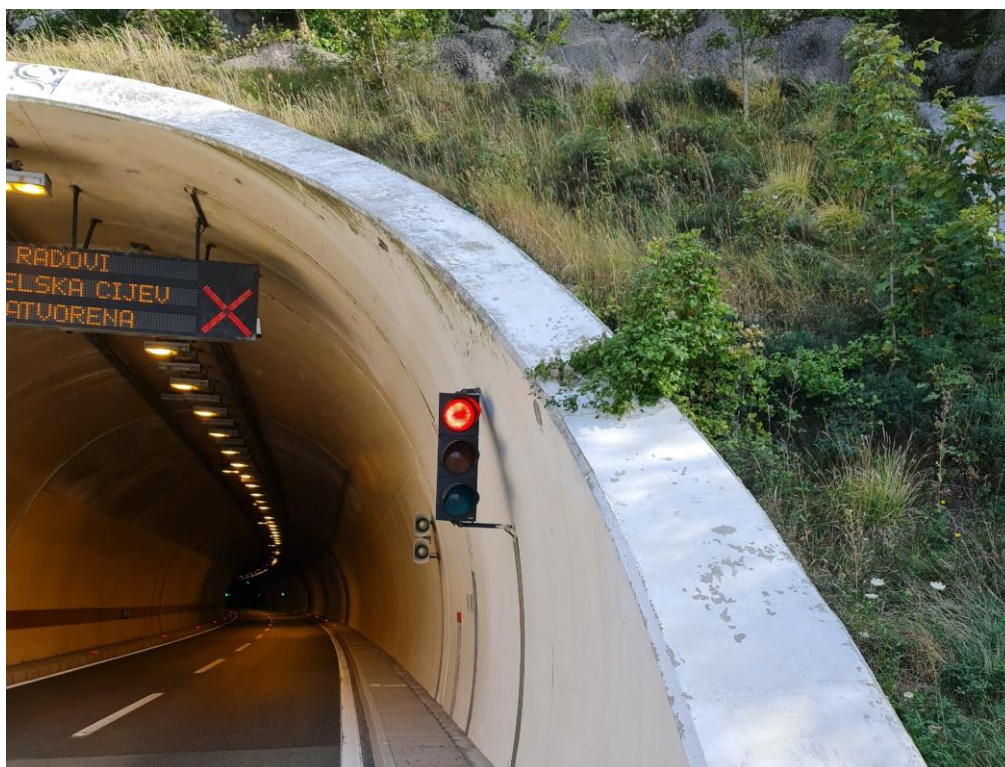
Slika 2: Ulazni portal - LJUŠTENJE PREMAZA BETONA
