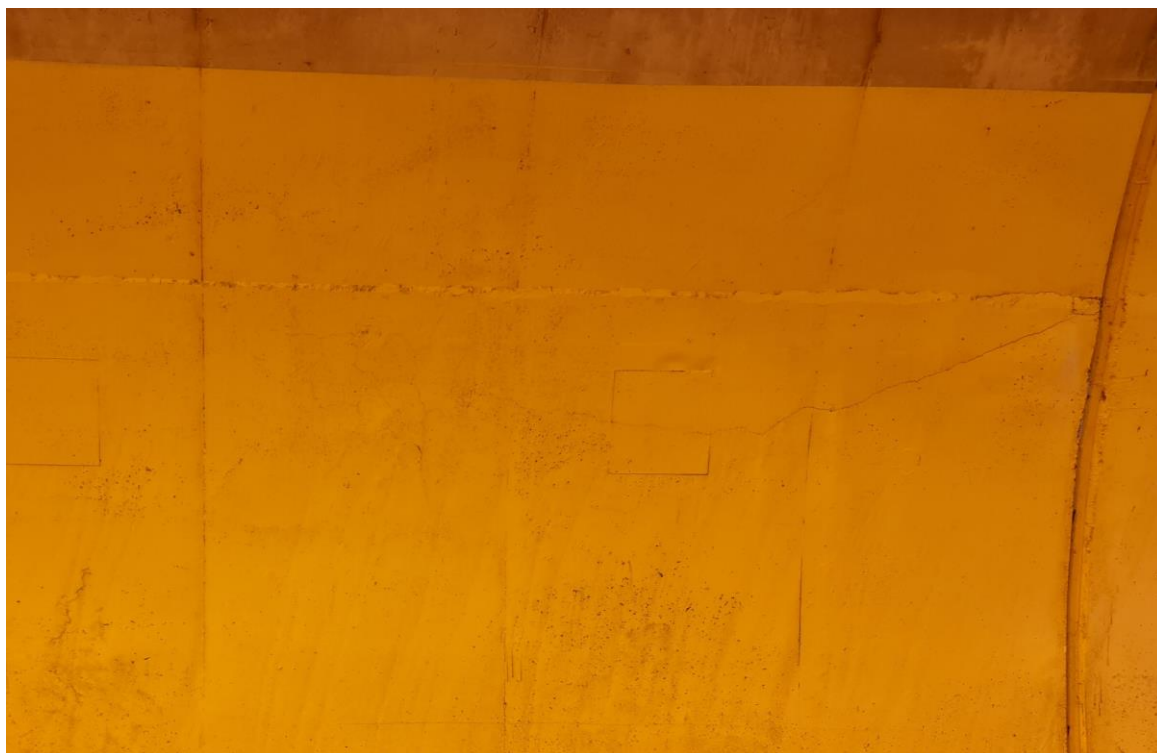
Slika 9: Kampada 180 - UZDUŽNA PUKOTINA BOKA
