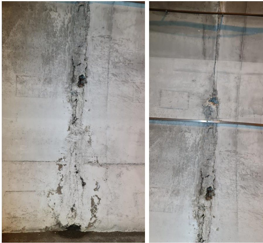
Slika 22: Kampada 91 - PUKOTINE, VLAŽENJE I LJUŠTENJE SANIRANE SPOJNICE
