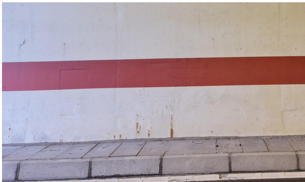
Slika 4: Kampada 183 - MRLJE OD KOROZIJE ARMATURE
