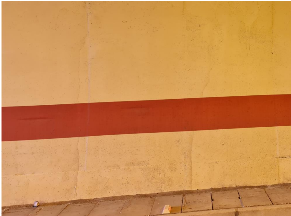
Slika 5: Kampada 182 - RADIJALNE PUKOTINE
