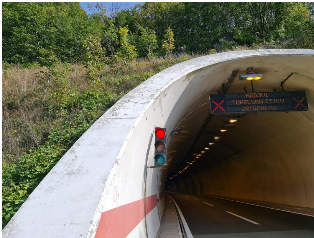
Slika 1: Ulazni portal - LJUŠTENJE PREMAZA BETONA
