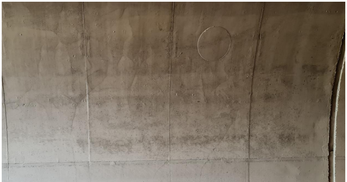
Slika 33: Kampada 2 - MREŽASTE PUKOTINE
