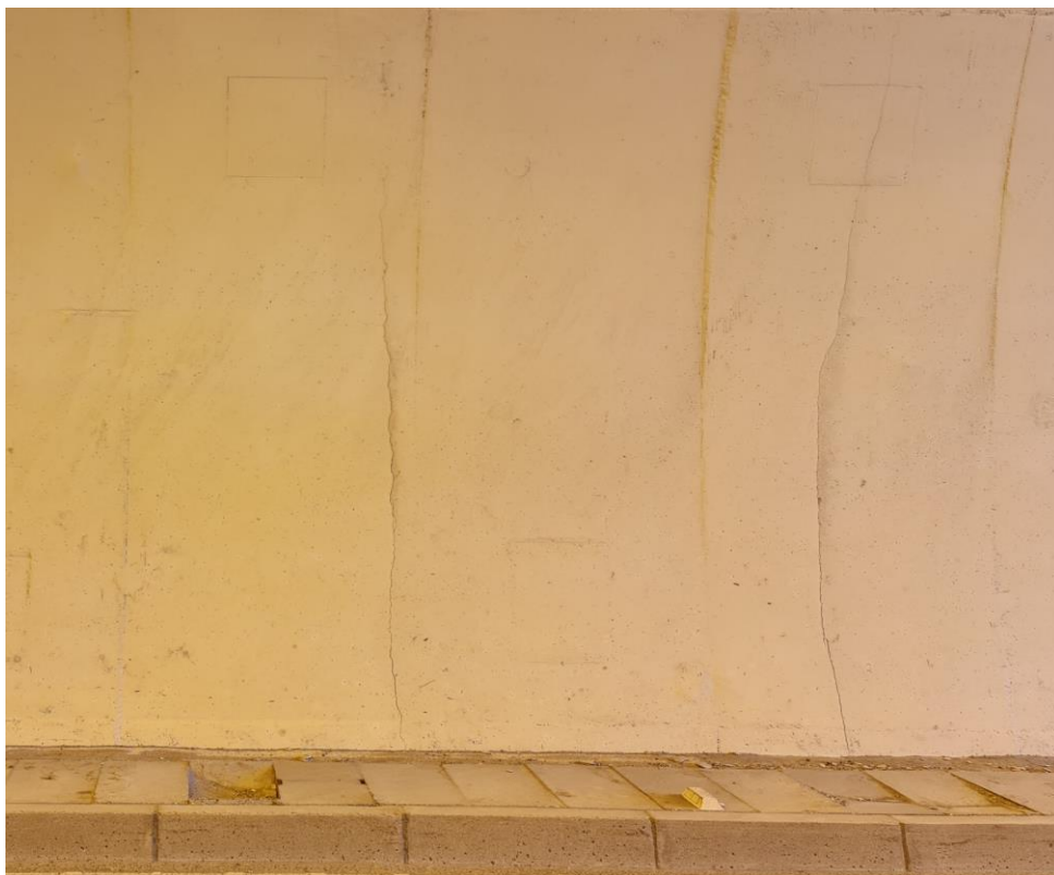
Slika 6: Kampada 181 - RADIJALNE PUKOTINE
