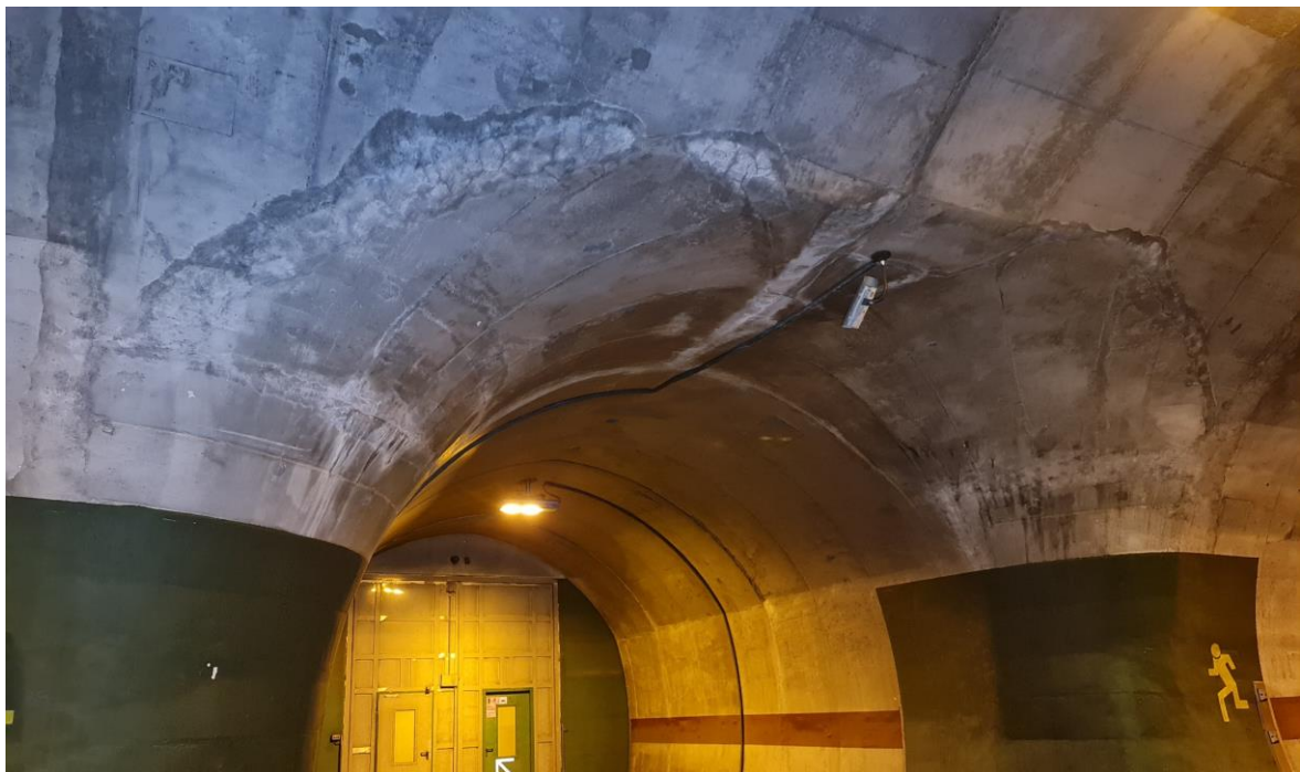
Slika 27: Kampada 38 - UZDUŽNE PUKOTINE SA IZLUŽIVANJEM
