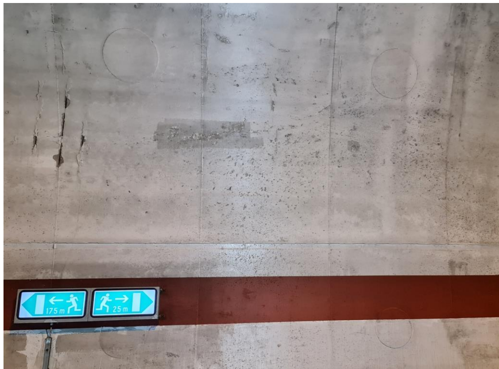
Slika 25: Kampada 59 - SEGREGACIJA, KOROZIJA ARMATURE I LJUŠTENJE BETONA
