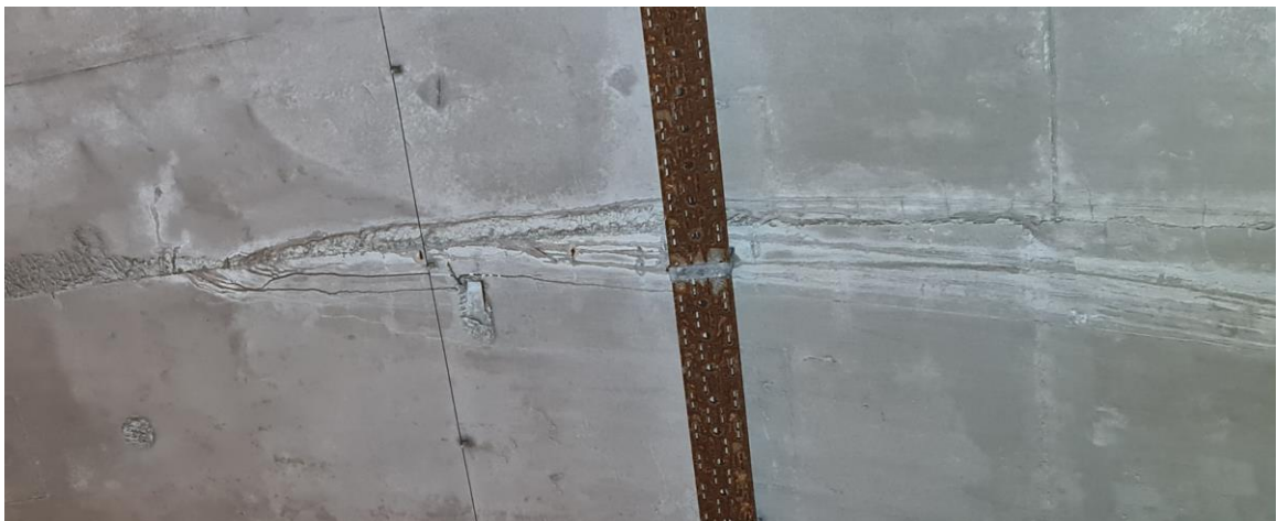
Slika 13: Kampada 148 - PUKOTINA SA IZLUŽIVANJEM
