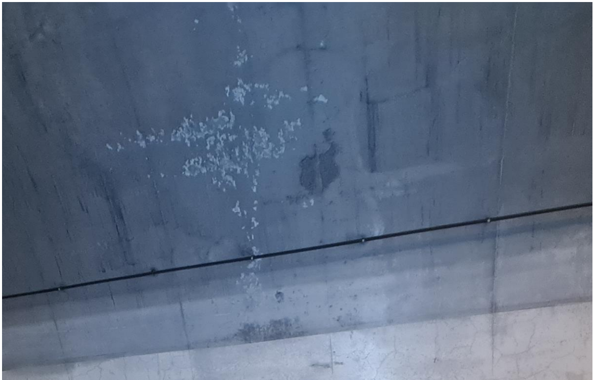
Slika 18: Kampada 127 - LJUŠTENJE POVRŠINE BETONA
