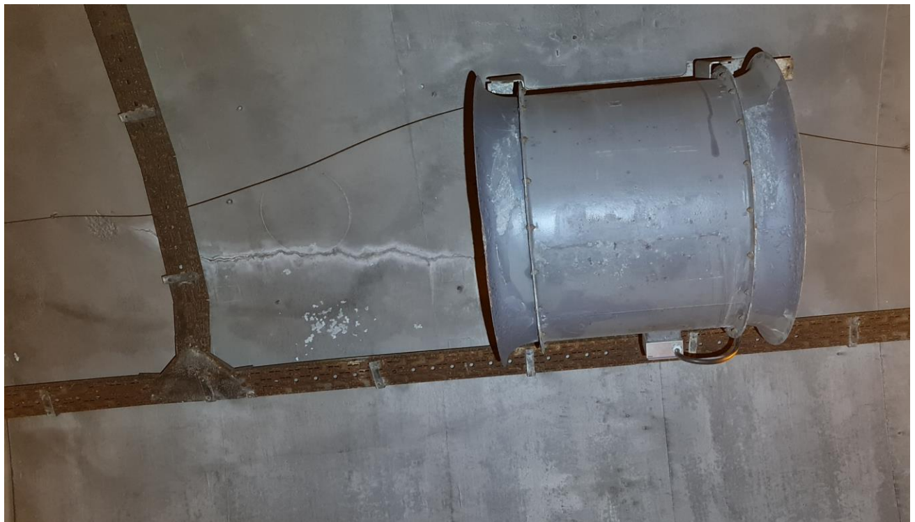
Slika 30: Kampada 35 - UZDUŽNA PUKOTINA, IZLUŽIVANJE
