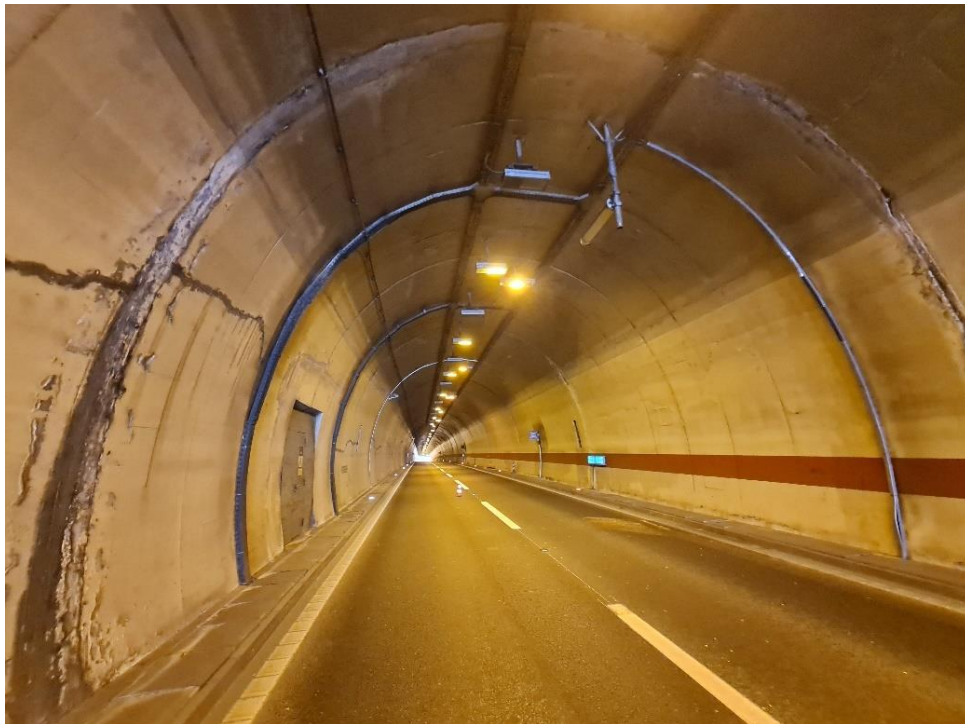
Slika 7: Procurivanje vode na dilatacijskoj rešci, stacionaža 24+460 km
