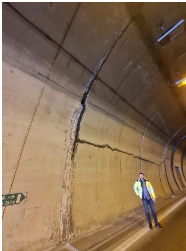
Slika 6: Procurivanje na dilatacijskoj rešci, stacionaža 24+400 km
