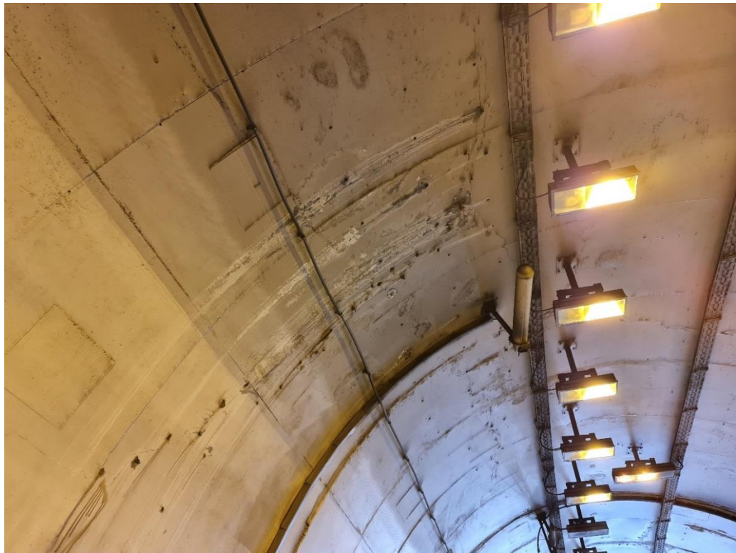
Slika 9: Oštećenje prethodno saniranih betonskih površina
