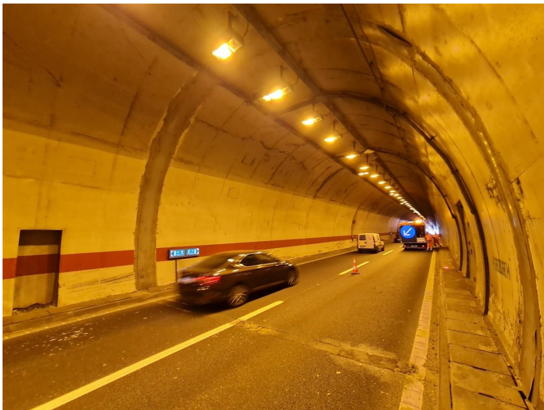
Slika 8: Procurivanje na dilatacijskoj rešci, stacionaža 24+577 km
