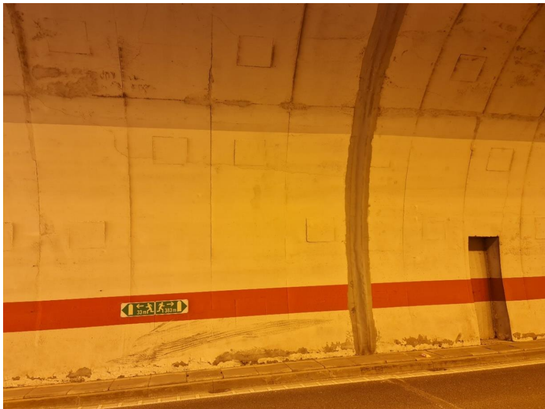
Slika 12: Oštećenje završnog premaza
