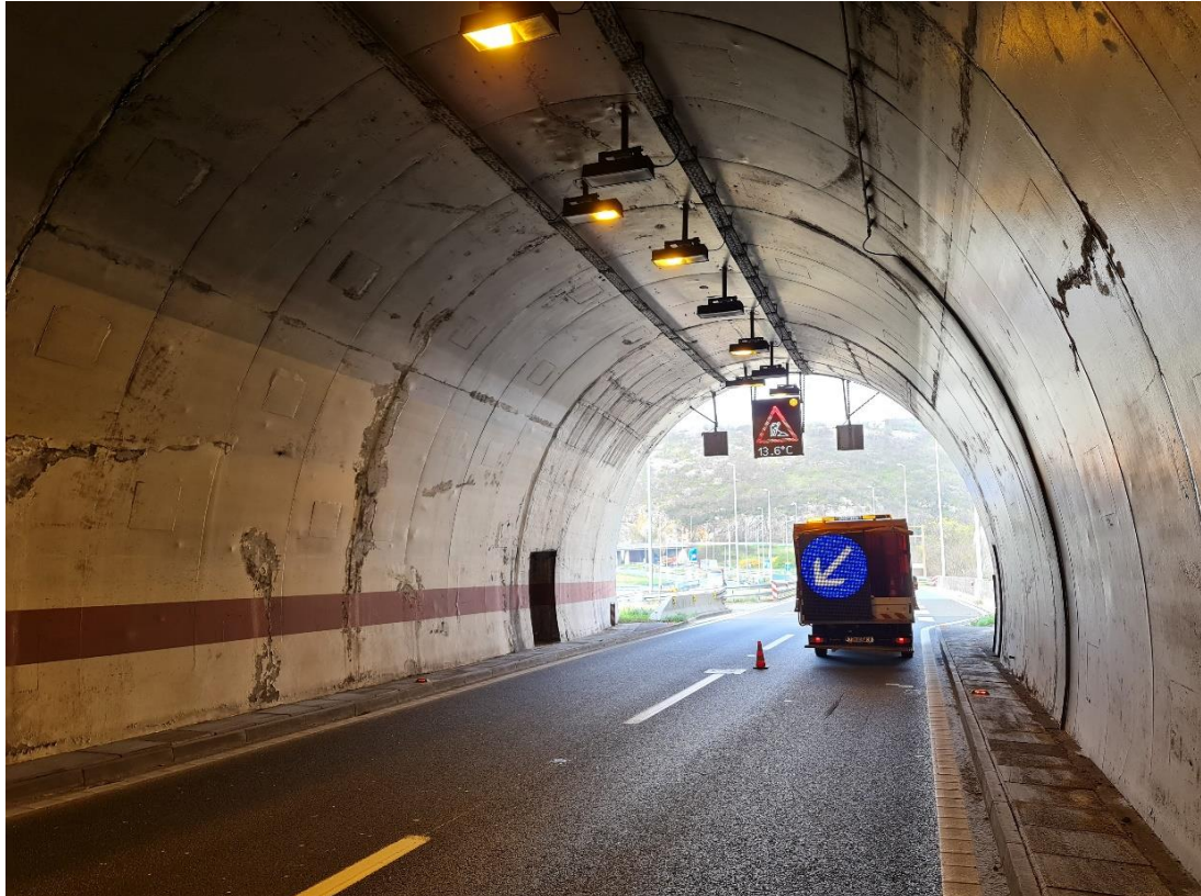
Slika 10: Odlamanje betona na dilatacijskoj rešci
