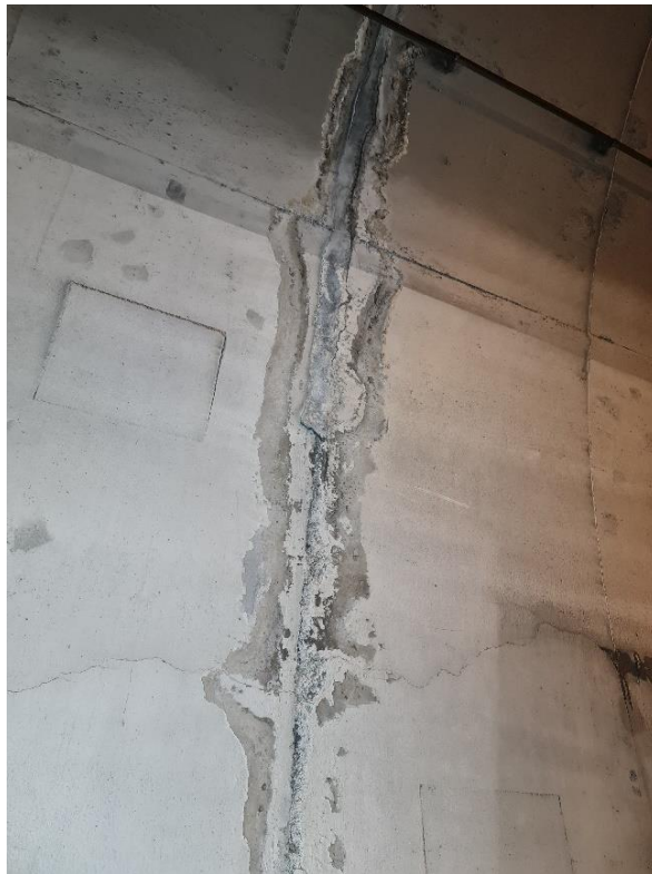
Slika 3: Procurivanje na dilatacijskoj rešci, stacionaža 24+250 km
