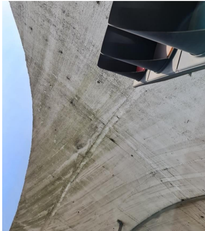
Slika 1: Ljuštenje premaza betona (izlazni portal)
