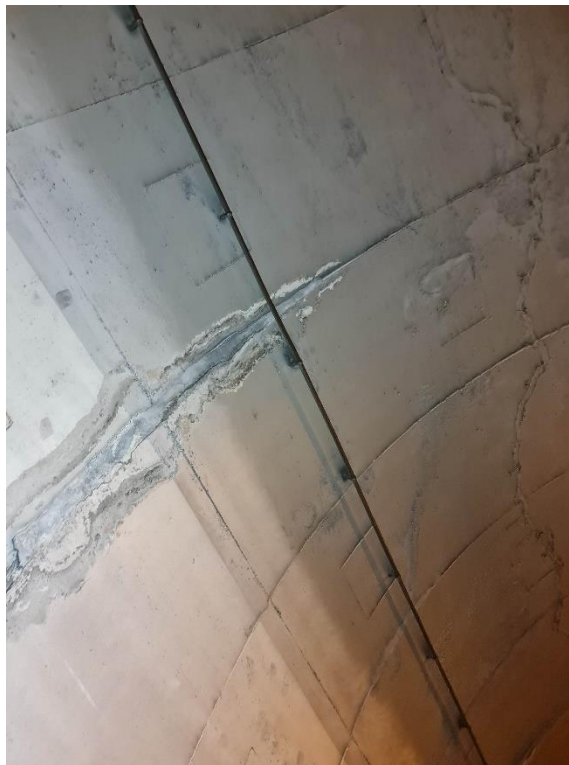
Slika 4: Procurivanje na dilatacijskoj rešci, stacionaža 24+250 km
