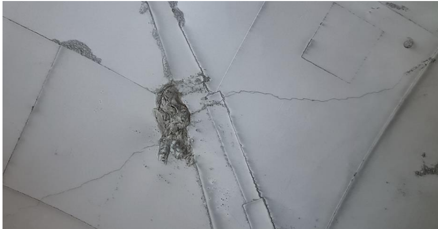
Slika 26: Prolaz za vozila 3D – PUKOTINE, SEGREGACIJA
