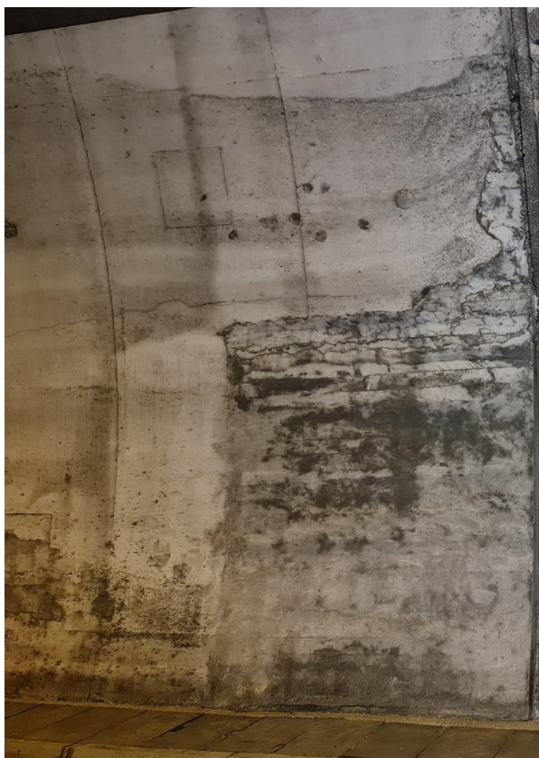
Slika 22: Kampada 438 – PUKOTINE, PROCJEDIVANJE
