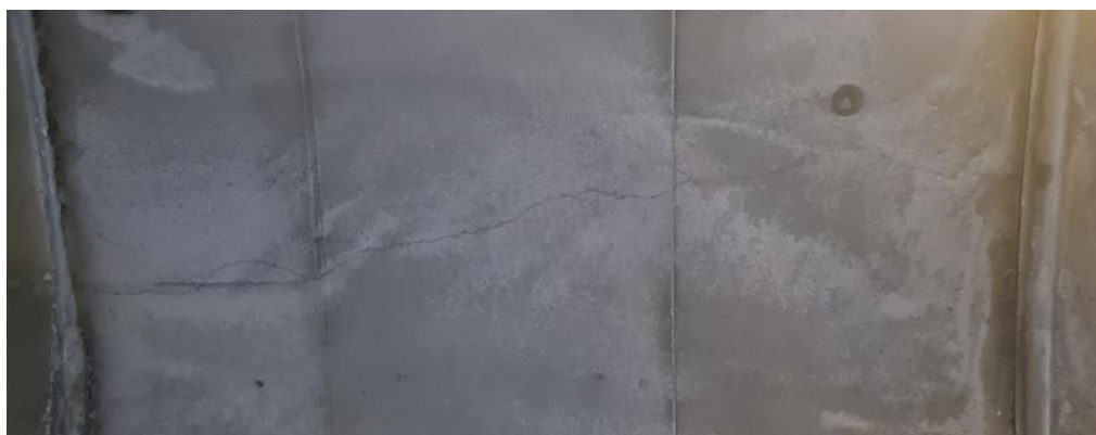
Slika 9: Kampada 523 – PUKOTINE, ODLAMANJE U SPOJNICAMA, OŠTEĆENJE BOJE, SEGREGACIJA
