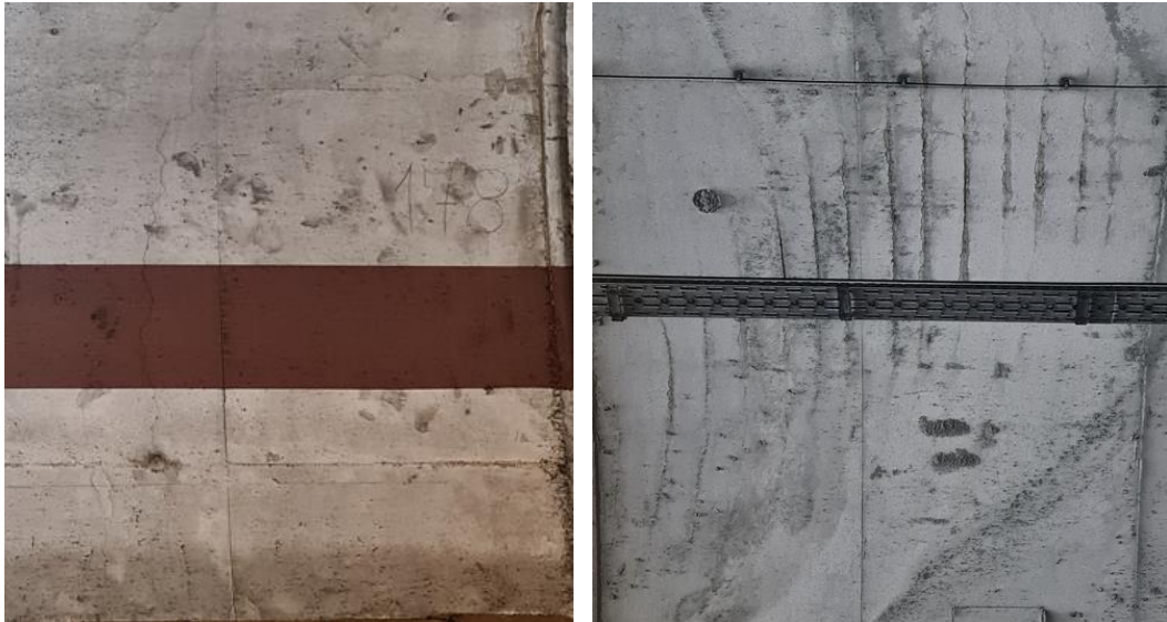
Slika 41: Kampada 178 – PUKOTINE, SEGREGACIJA
