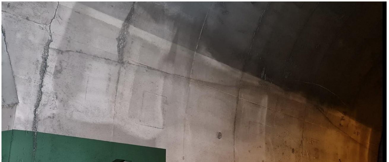
Slika 20: Prolaz za vozila 4L – PUKOTINE, ODLAMANJE U SPOJNICAMA
