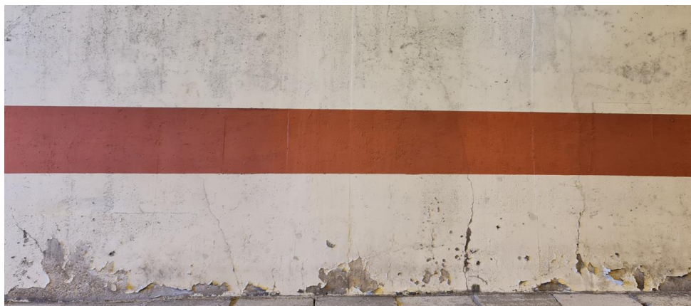
Slika 6: Kampada 568 – PUKOTINE, ODLAMANJE U SPOJNICAMA, OŠTEĆENJE BOJE
