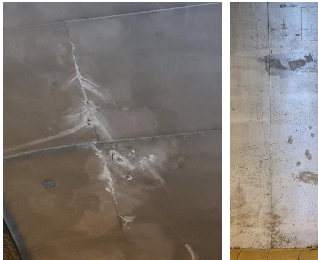
Slika 12: Kampada 478 – PUKOTINE, LJUŠTENJE, ARMATURA
