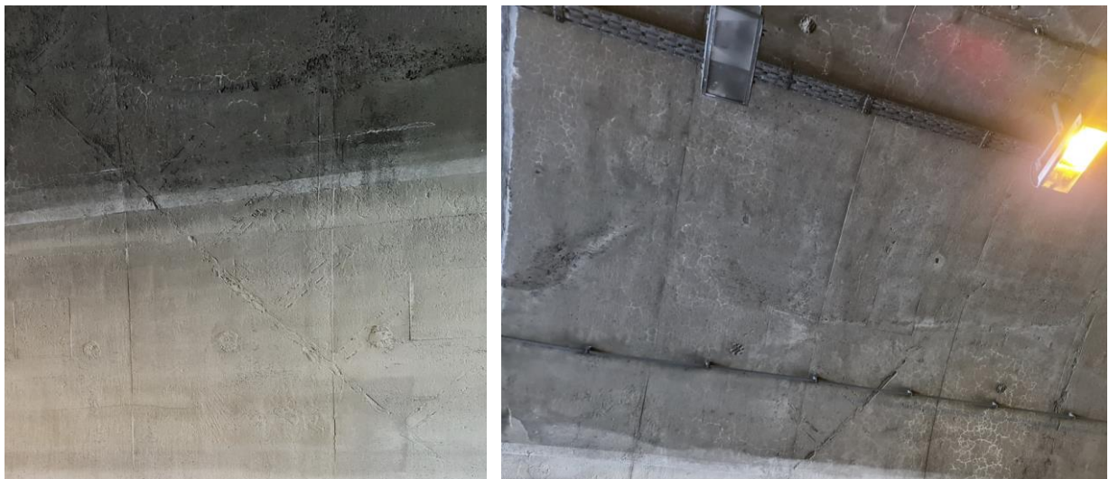
Slika 47: Kampada 3 – PUKOTINE, SEGREGACIJA
