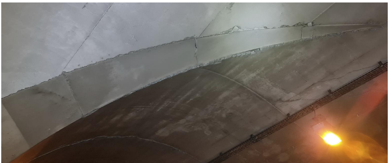
Slika 16: Prolaz za vozila 4D – PUKOTINE
