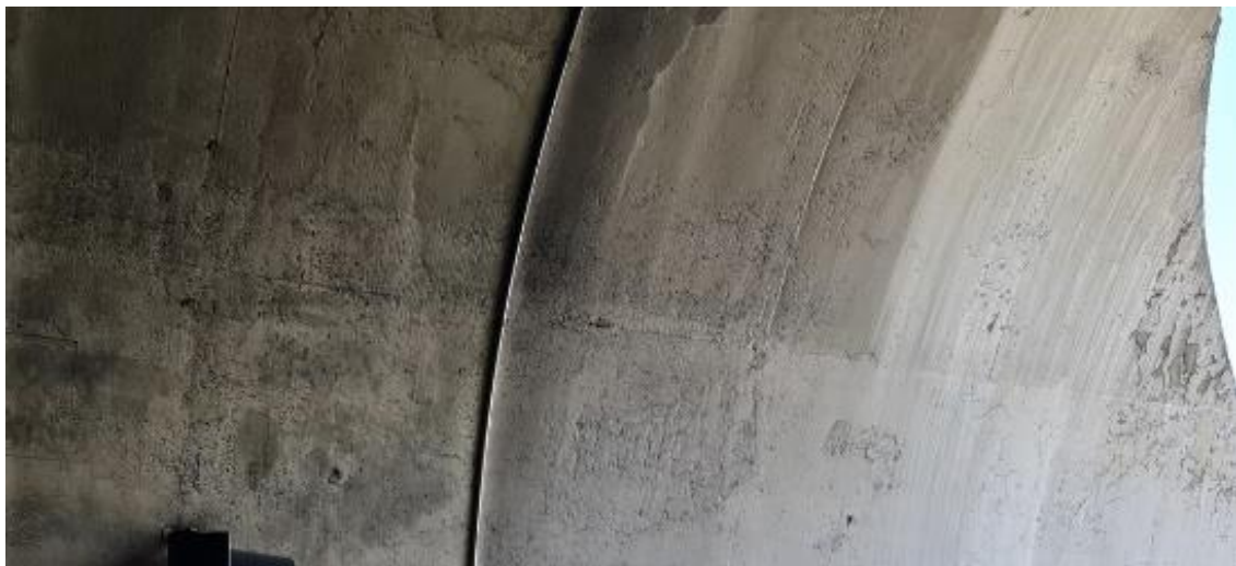
Slika 50: Kampada 1 – LJUŠTENJE, SEGREGACIJA, OŠTEĆENJE BOJE, PUKOTINE
