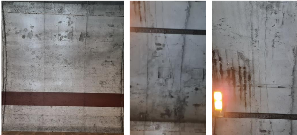
Slika 38: Kampada 193 – PUKOTINE, ARMATURA
