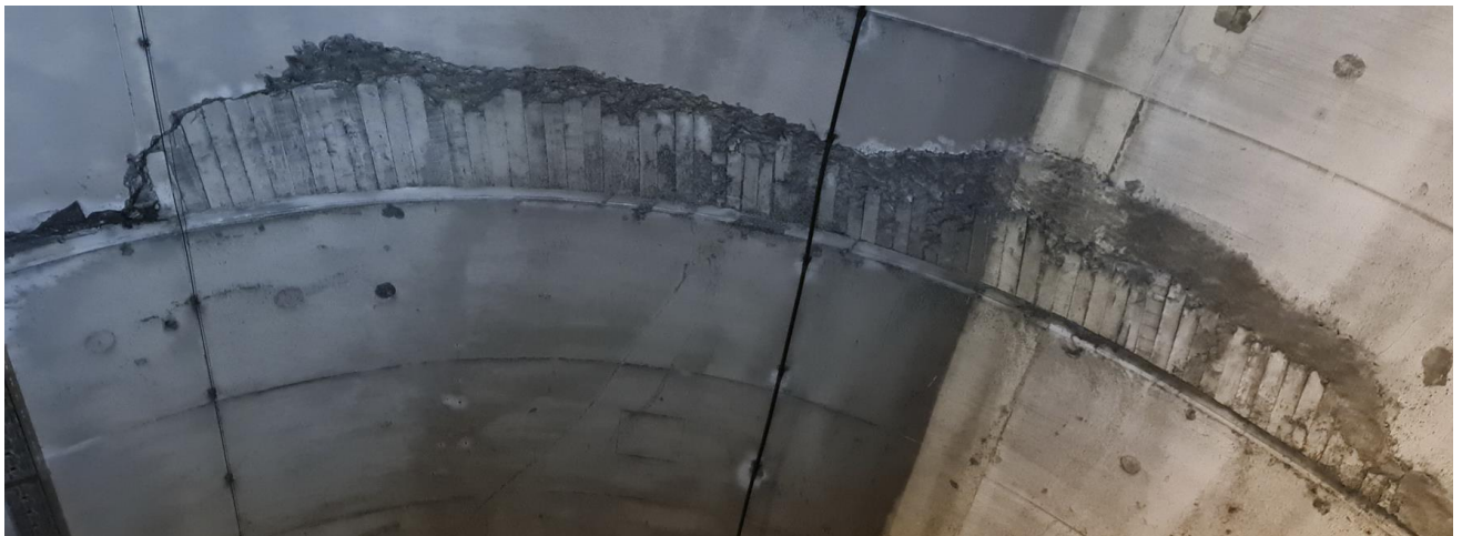
Slika 30: ODLAMANJE U SPOJNICAMA, SEGREGACIJA
