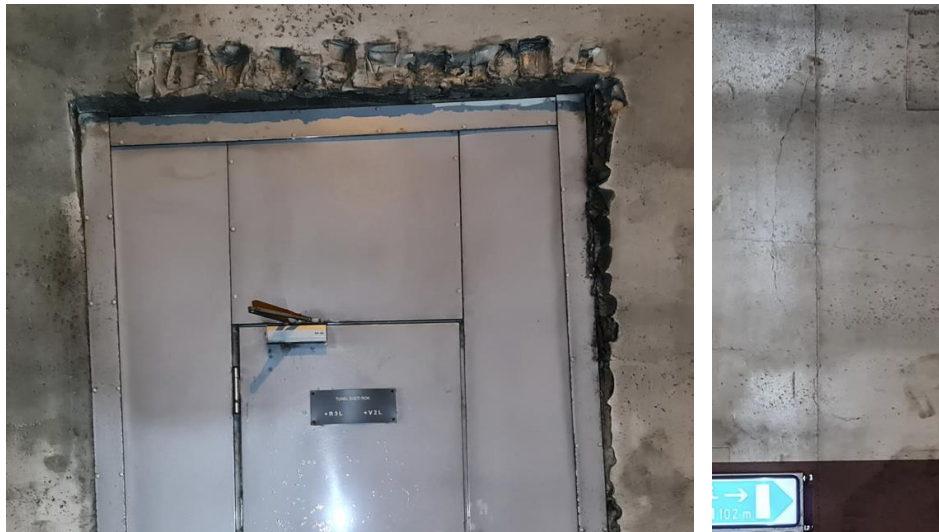
Slika 46: Kampada 39 – ODLAMANJE, PUKOTINE
