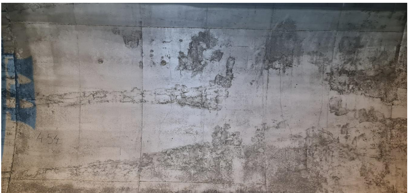
Slika 21: Kampada 454 – PUKOTINE, SEGREGACIJA
