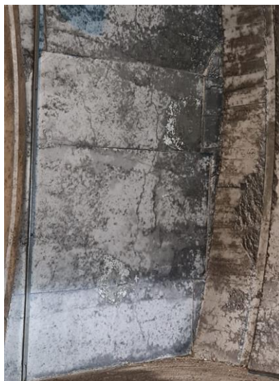
Slika 28: Kampada 348 – PUKOTINE, SEGREGACIJA
