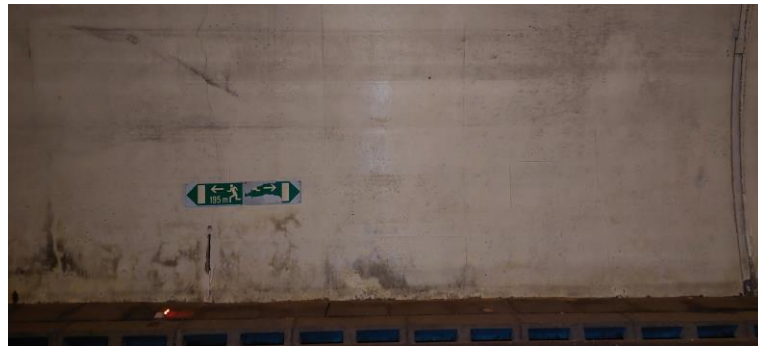
Slika 6: Kampada 57 - ARMATURA, PUKOTINE
