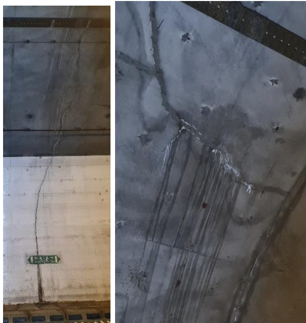
Slika 14: Kampada 195 – PUKOTINE, PROCJEĐIVANJE (CURENJE KROZ BETON)
