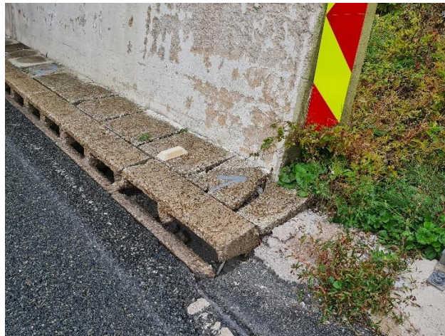
Slika 3: Kampada 1, ulazni portal - ODLAMANJE BETONSKE PLOČE HODNIKA
