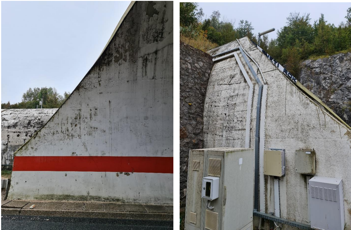
Slika 1: Kampada 1 - LJUŠTENJE, PUKOTINE
