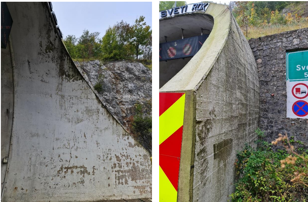
Slika 2: Kampada 1 - LJUŠTENJE, PUKOTINE
