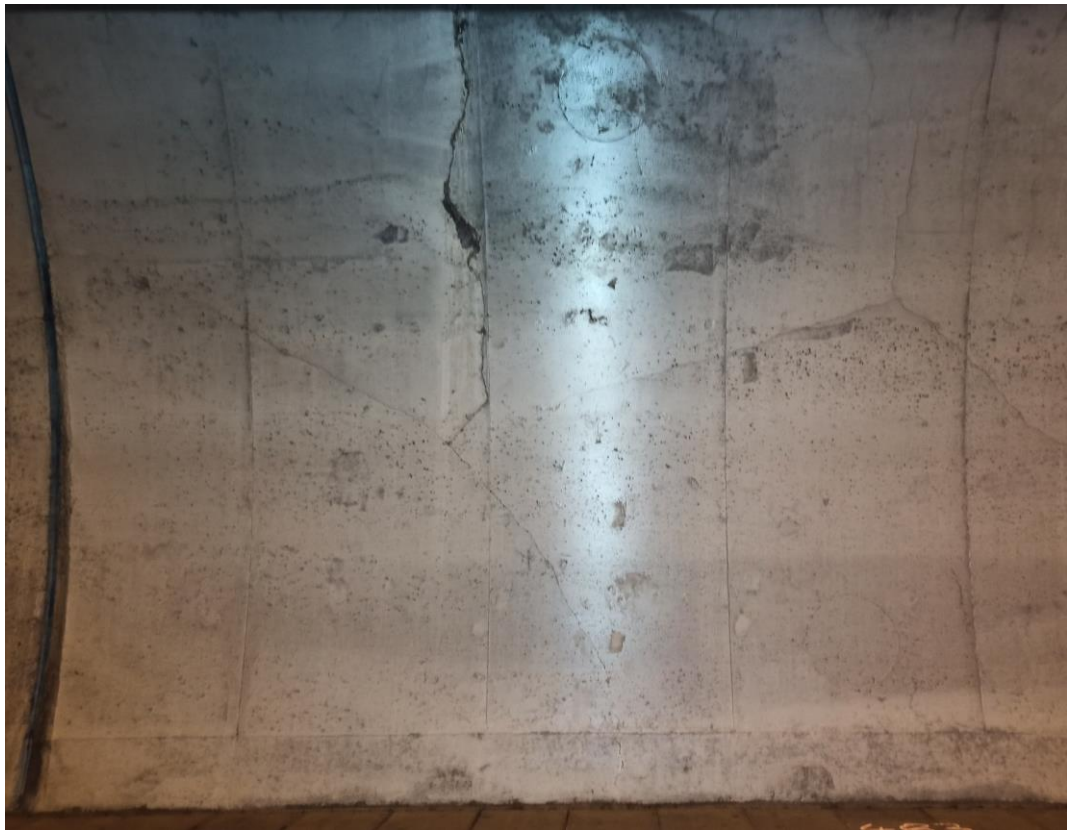
Slika 37: Kampada 483 - DIJAGONALNE/ RADIJALNE PUKOTINE, LJUŠTENJE PREMAZA
