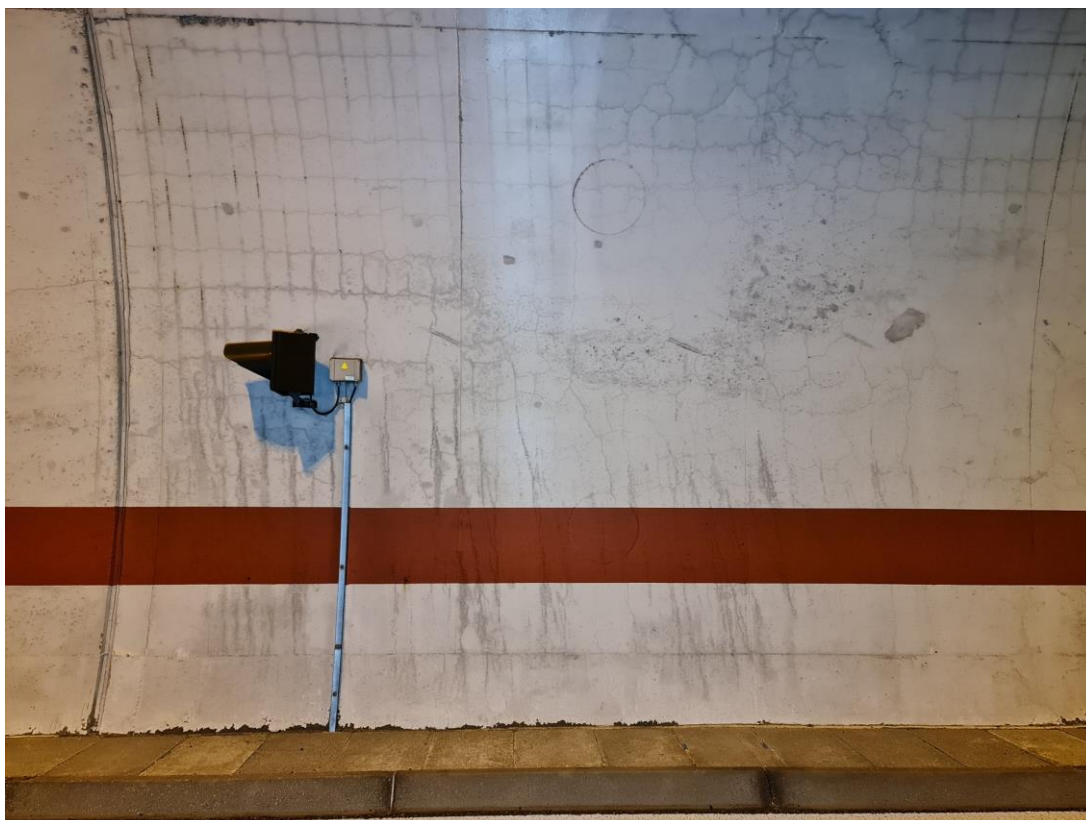
Slika 23: Kampada 31 - NEDOSTATAK ZAŠTITNOG SLOJA, KOROZIJA ARMATURE
