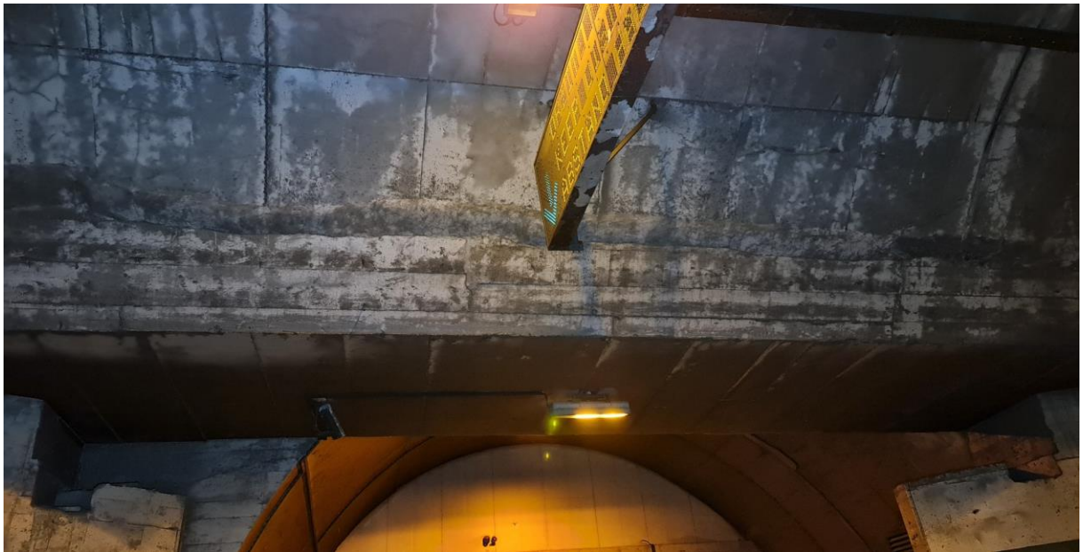
Slika 25: Okretište za automobile 2 - SEGREGACIJA I LJUŠTENJE POVRŠINE BETONA
