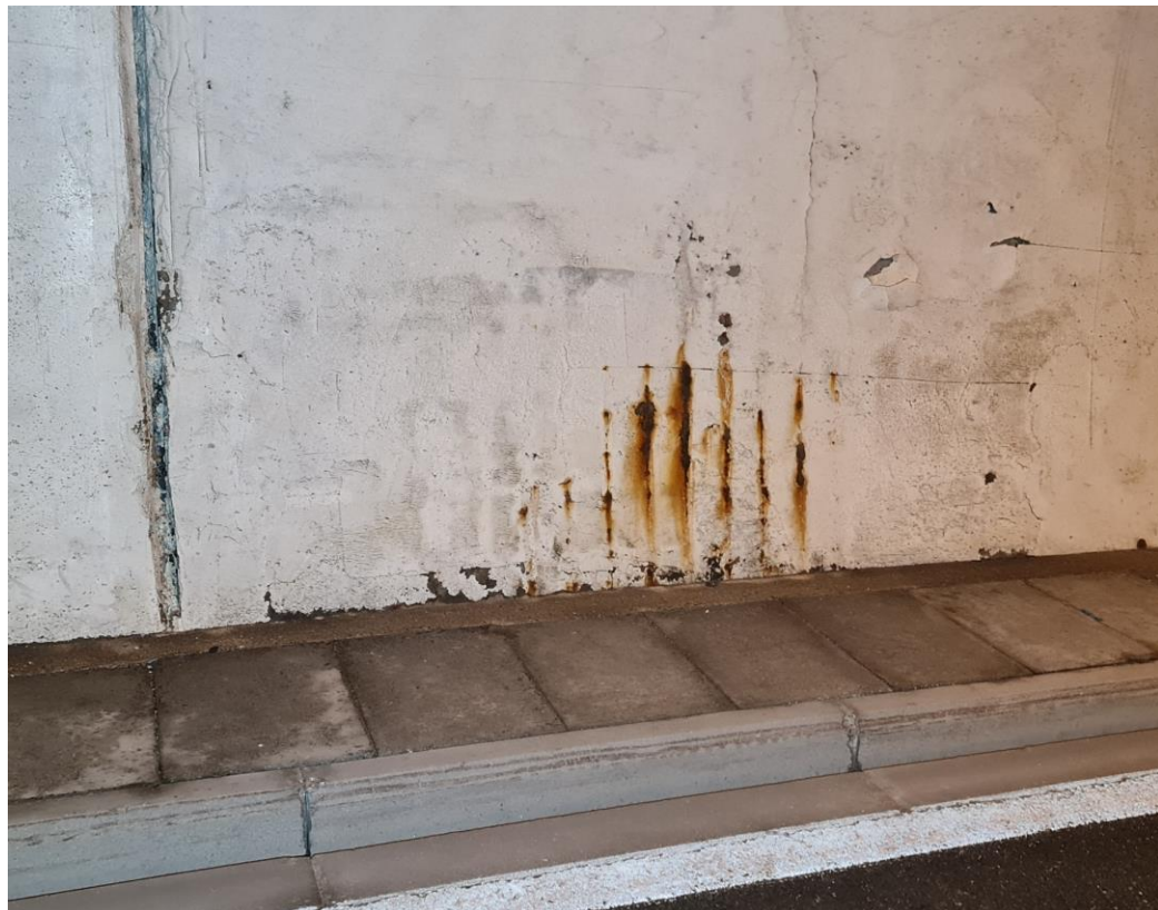
Slika 6: Kampada 3 - NEDOSTATAK ZAŠTITNOG SLOJA, KOROZIJA ARMATURE
