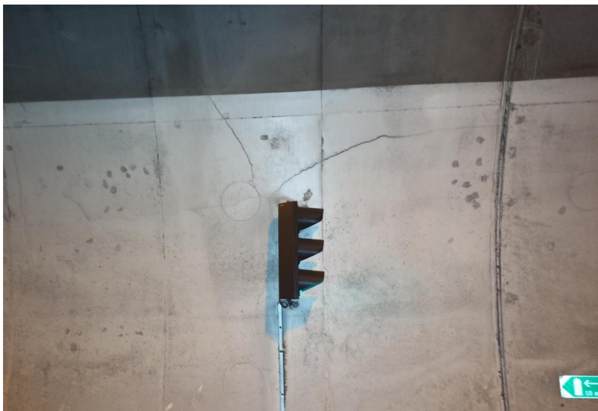
Slika 14: Kampada 90 - UZDUŽNA I RADIJALNA PUKOTINA
