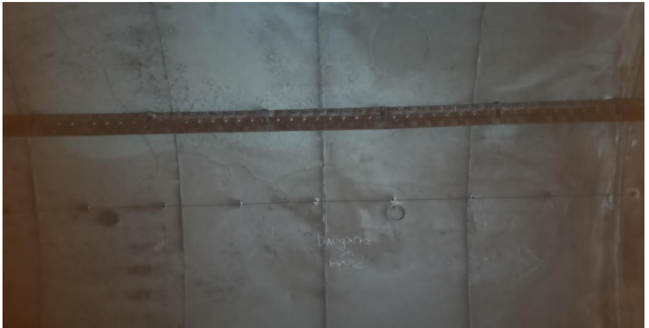
Slika 34: Kampada 471 - UZDUŽNA/ DIJAGONALNA PUKOTINA SVODA
