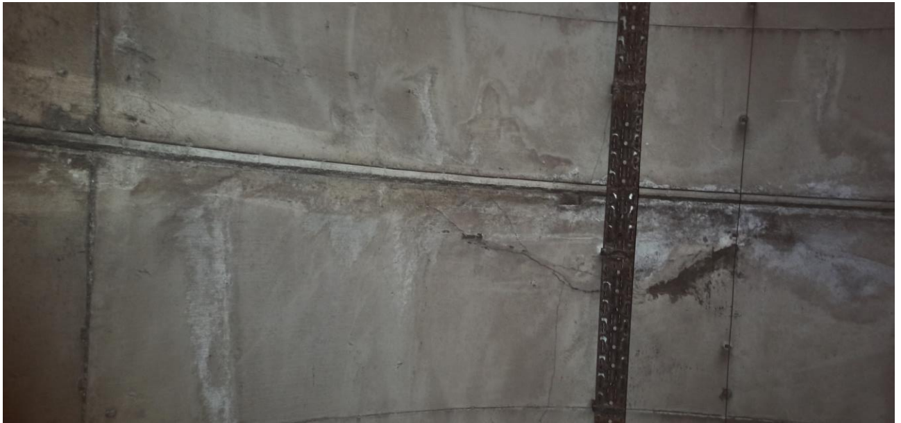
Slika 33: Kampada 464 - IZLUŽIVANJE I LJUŠTENJE BETONA NA SPOJNICI
