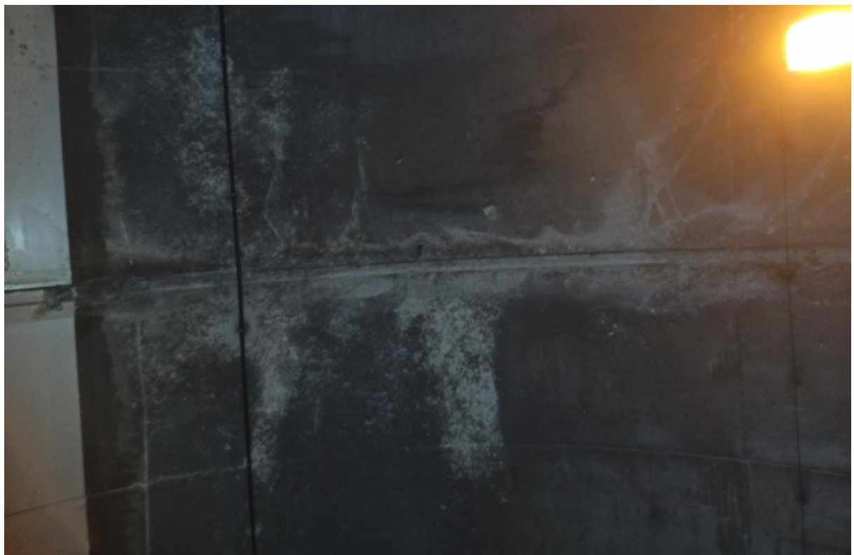
Slika 18: Kampada 131 - LJUŠTENJE BETONA NA SPOJNICI
