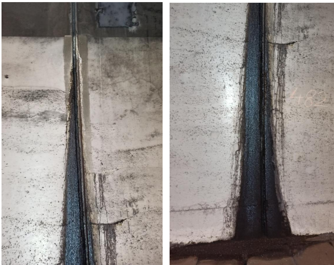
Slika 36: Kampada 481 - UZDUŽNA/ RADIJALNA PUKOTINA
