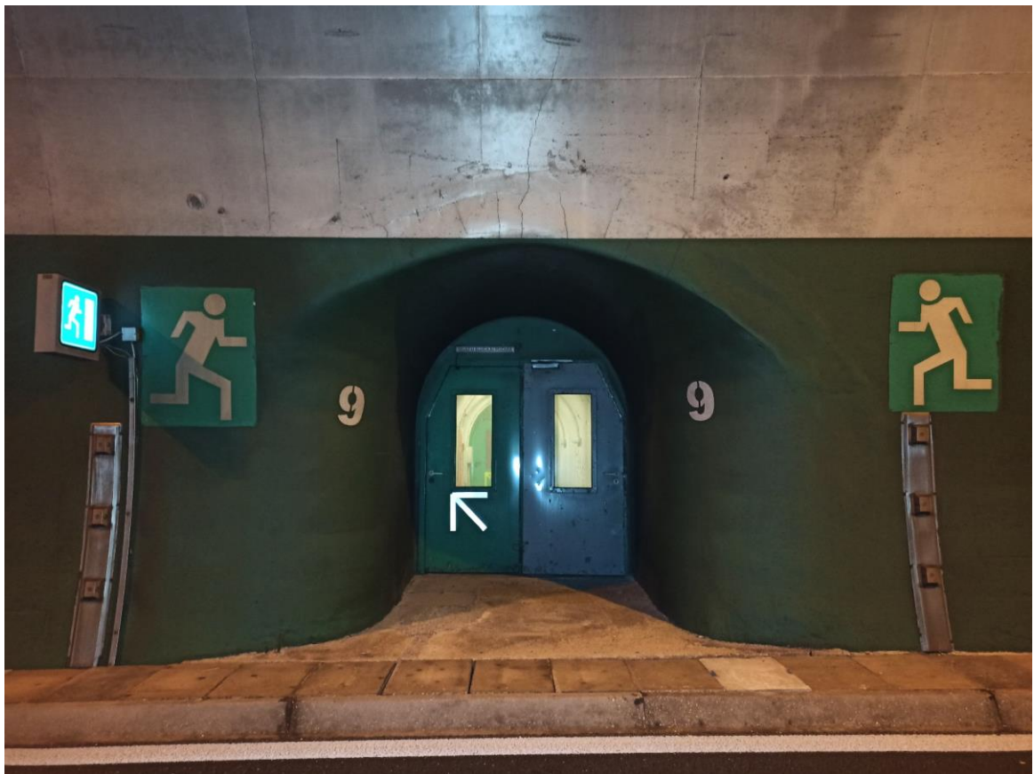
Slika 19: Pješački prolaz 9 - MREŽASTE PUKOTINE SANIRANOG ULAZNOG SVODA
