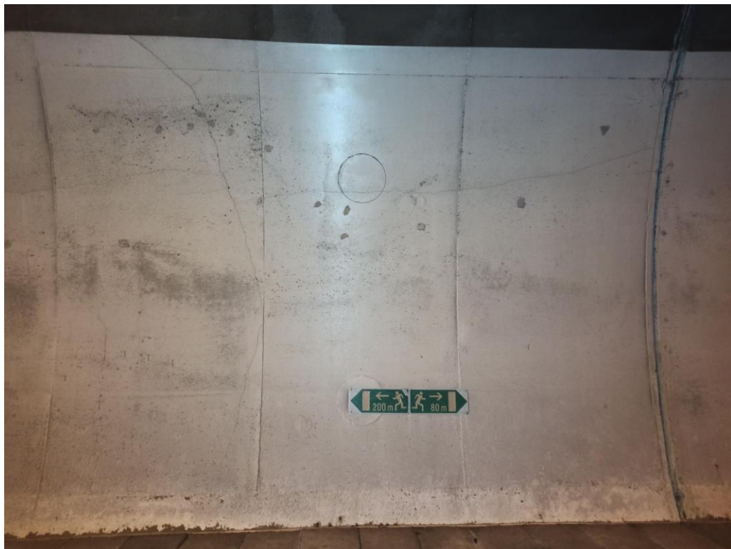
Slika 15: Kampada 101 - UZDUŽNE I RADIJALNE PUKOTINE
