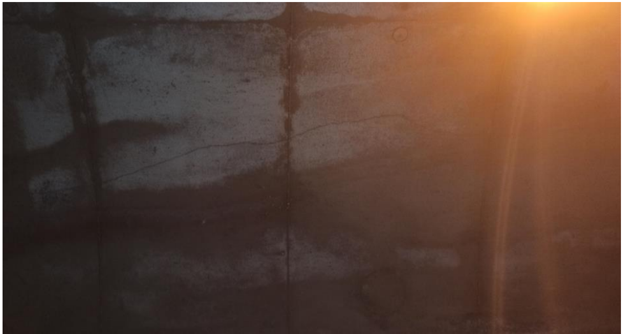
Slika 17: Kampada 104 - UZDUŽNA PUKOTINA SVODA
