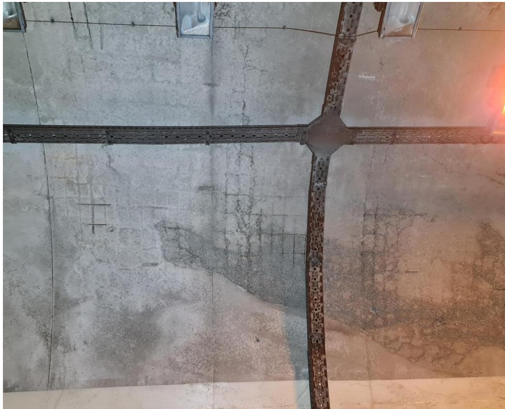
Slika 5: Kampada 3 - SEGREGACIJA, NEDOSTATAK ZAŠTITNOG SLOJA
