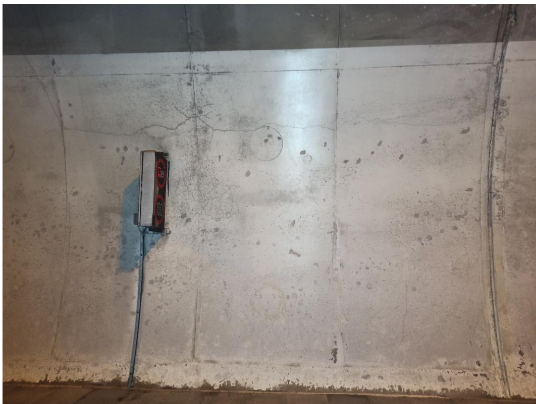
Slika 13: Kampada 84 - UZDUŽNA I RADIJALNA PUKOTINA
