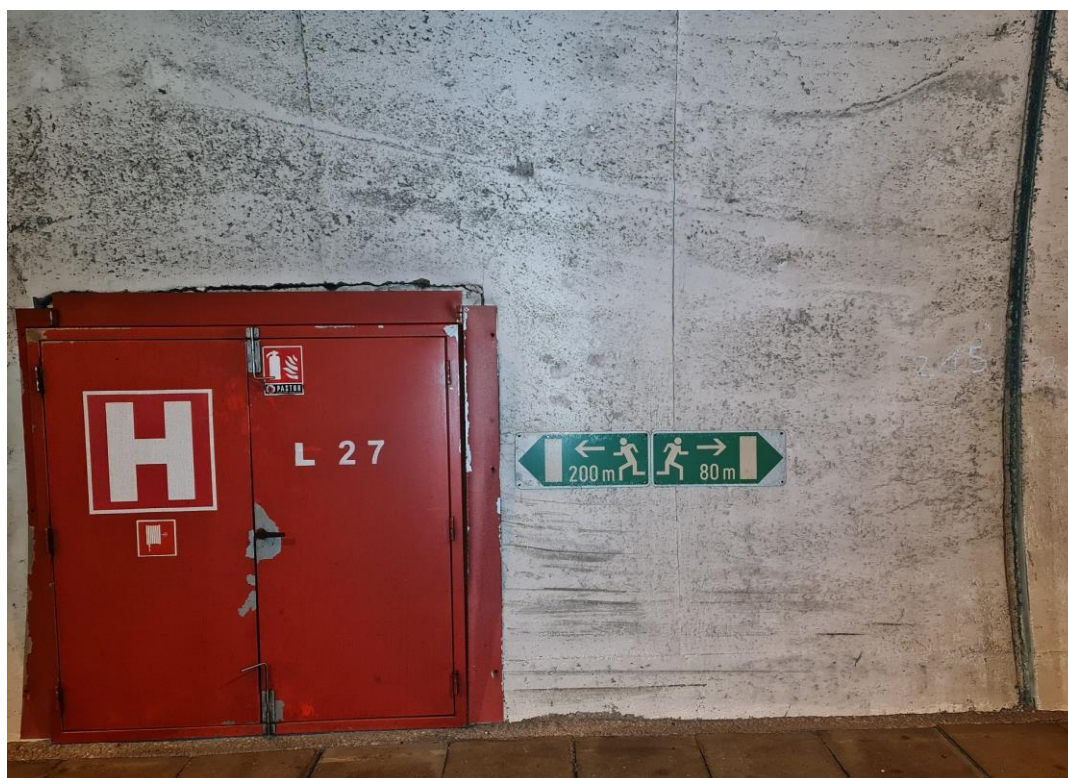
Slika 24: Kampada 215 - SEGREGACIJA I LJUŠTENJE POVRŠINE BETONA
