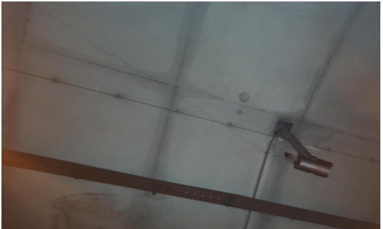
Slika 12: Kampada 76 - UZDUŽNA PUKOTINA SVODA
