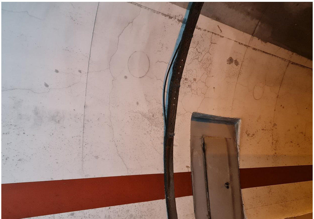
Slika 10: Kampada 53 - poprečne i mrežaste pukotine
