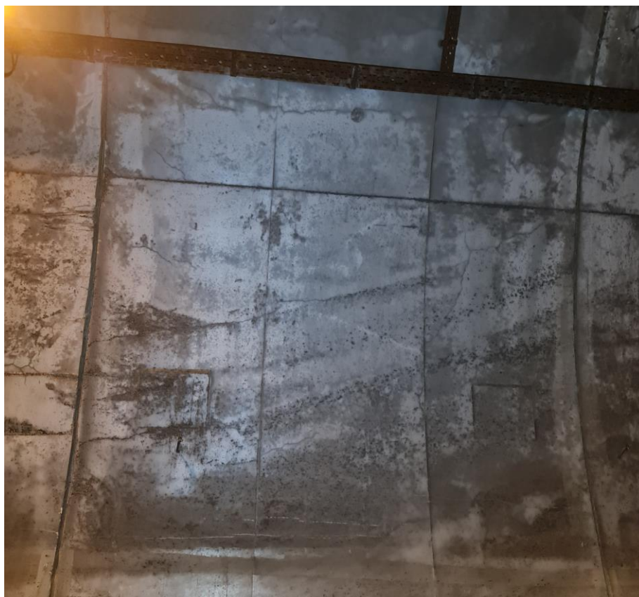
Slika 29: Kampada 430 - UZDUŽNE/ DIJAGONALNE PUKOTINE
