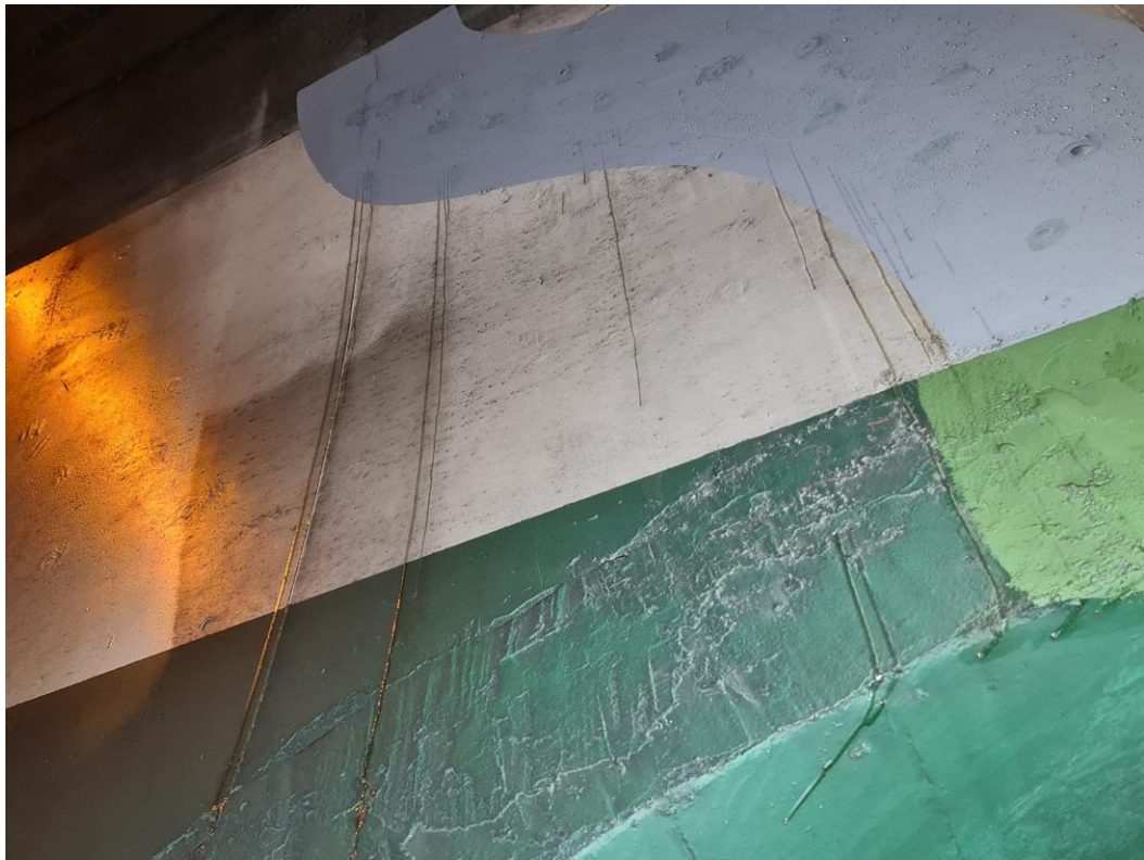
Slika 27: Pješački prolaz 3 - VLAŽENJE/ CURENJE NA MJESTU SANACIJE PUKOTINE
