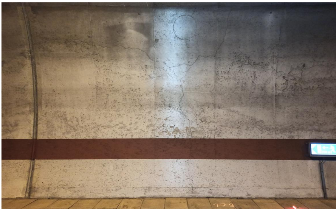
Slika 35: Kampada 479 - UZDUŽNA/ RADIJALNA PUKOTINA
