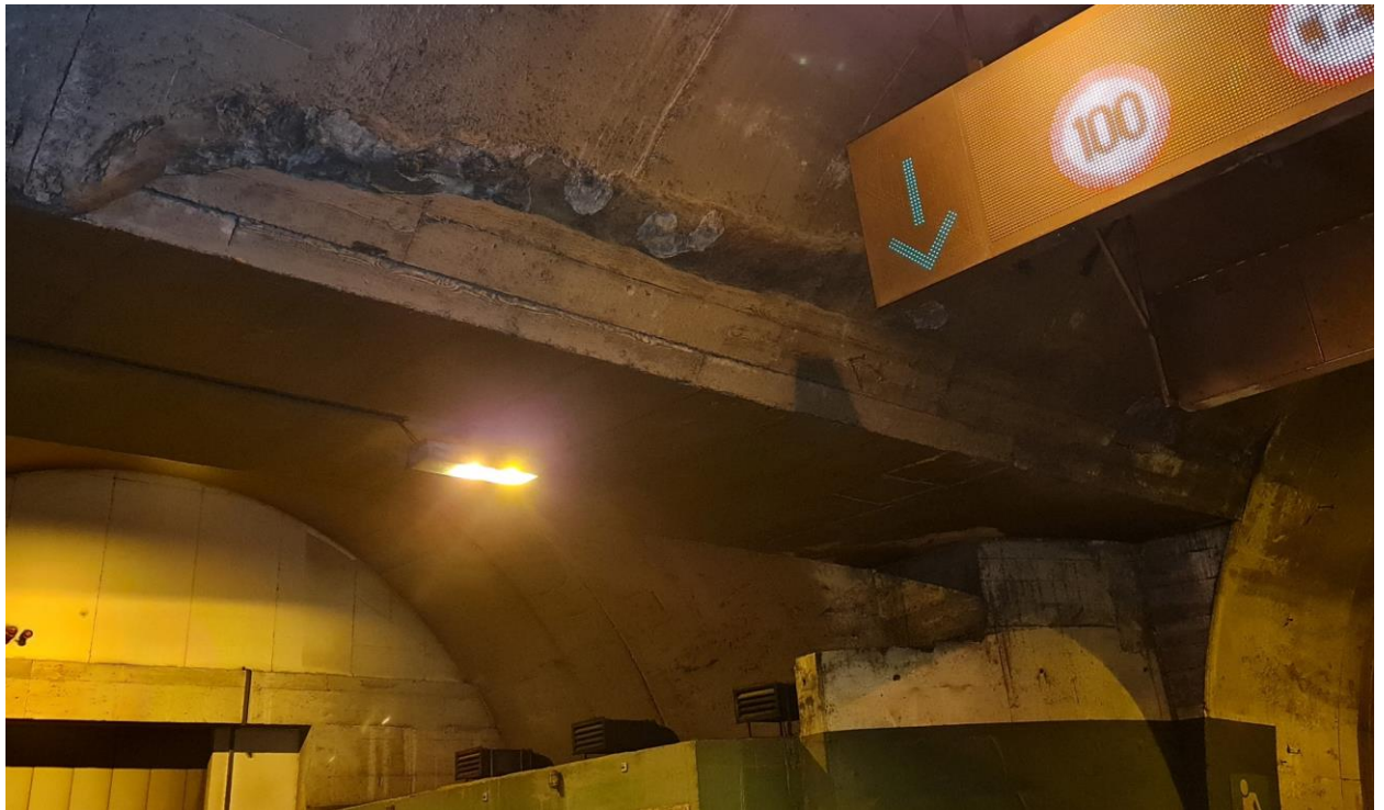
Slika 11: Okretište za automobile 3 - LJUŠTENJE BETONA
