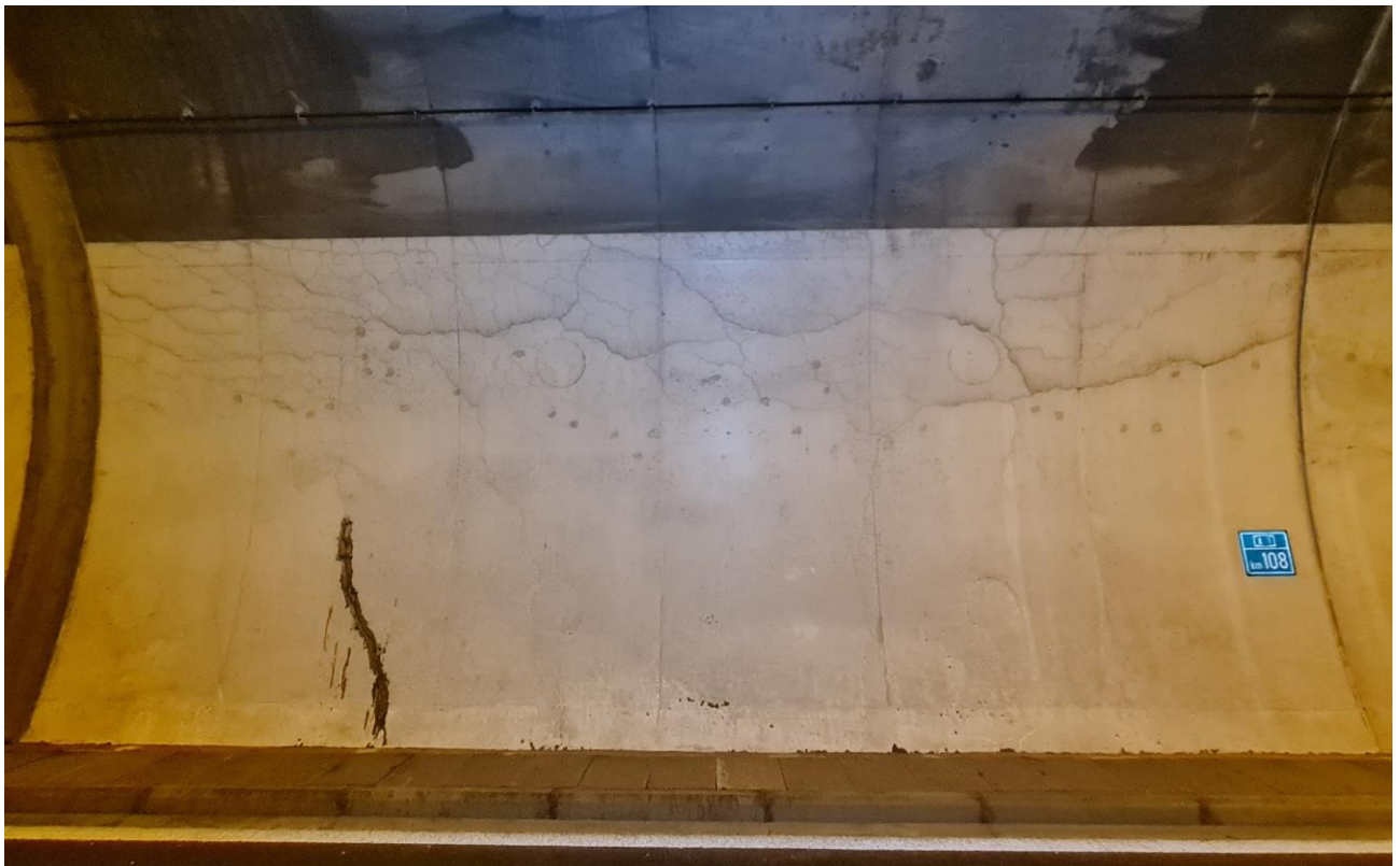
Slika 8: Kampada 39 - UZDUŽNE/ MREŽASTE PUKOTINE
