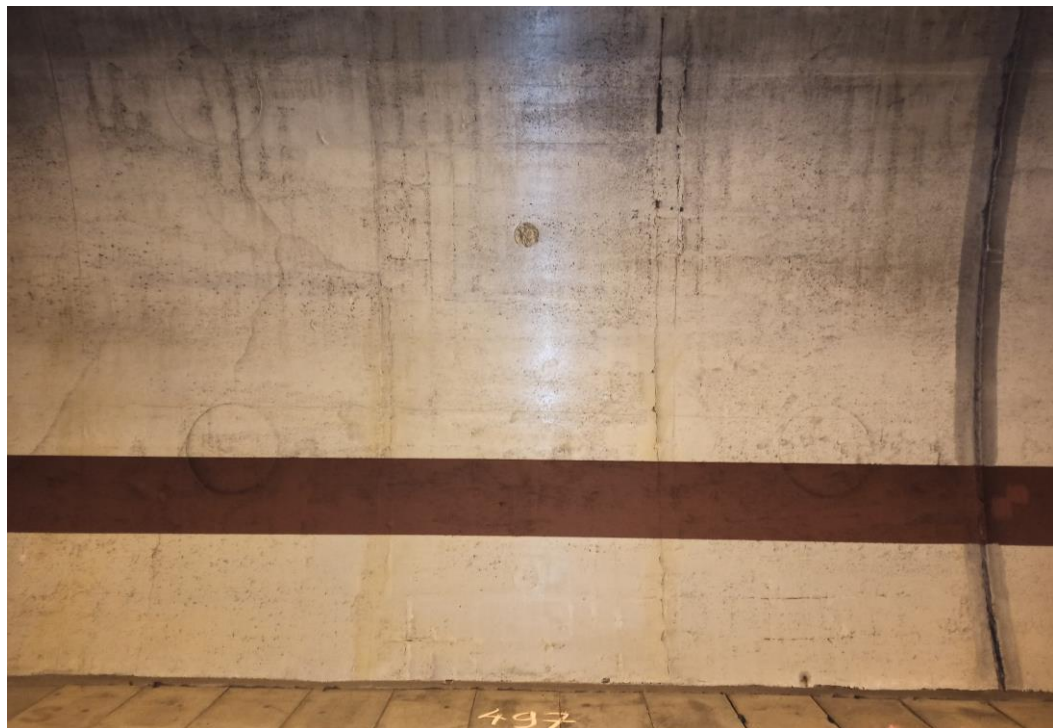
Slika 38: Kampada 497 - NEDOSTATAK ZAŠITNOG SLOJA, KOROZIJA ARMATURE, LJUŠTENJE BETONA
