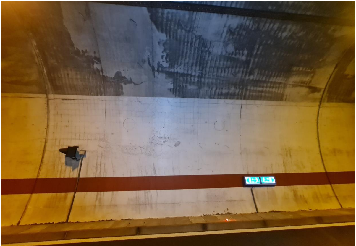
Slika 7: Kampada 31 - NEDOSTATAK ZAŠTITNOG SLOJA, MREŽASTE PUKOTINE
