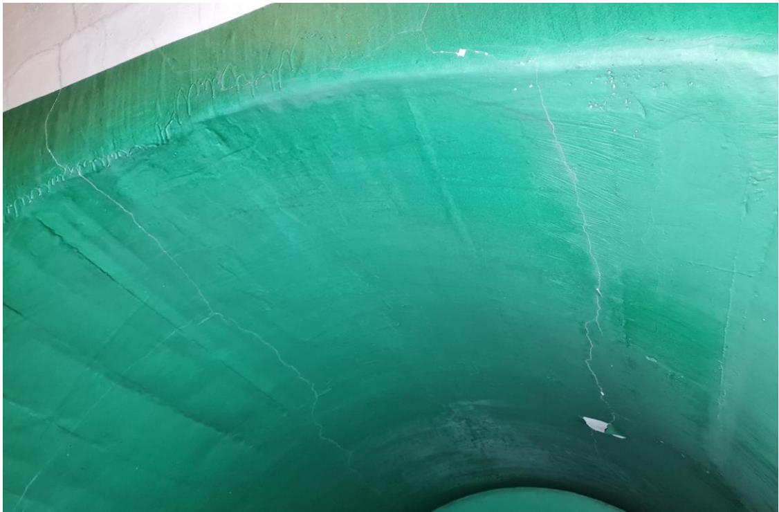
Slika 9: Pješački prolaz 13 - UZDUŽNE PUKOTINE, LJUŠTENJE PREMAZA
