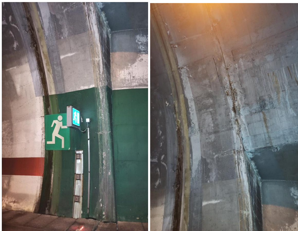
Slika 20: okretište za automobile 1 - RADIJALNE PUKOTINE SA IZLUŽIVANJEM, VLAŽENJE NA SPOJNICI
