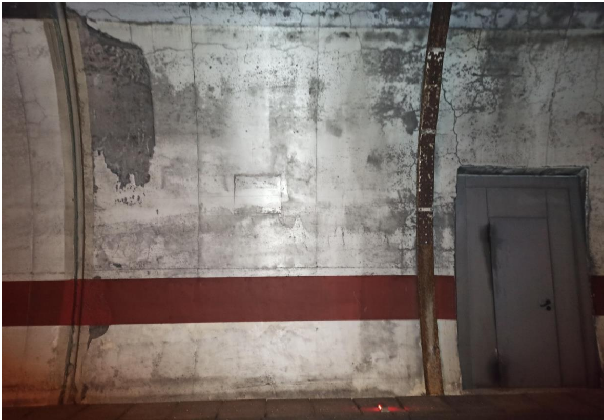
Slika 29: kampada 204 - MREŽASTE PUKOTINE, LJUŠTENJE PREMAZA
