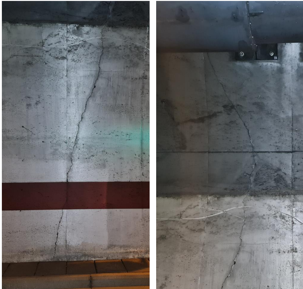
Slika 40: kampada 406 - RADIJALNA PUKOTINA OBA BOKA I SVODA CIJEVI
