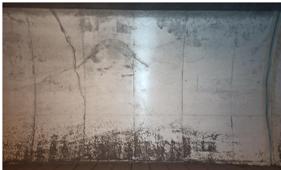
Slika 22: kampada 74 - RADIJALNA PUKOTINA, LJUŠTENJE PREMAZA
