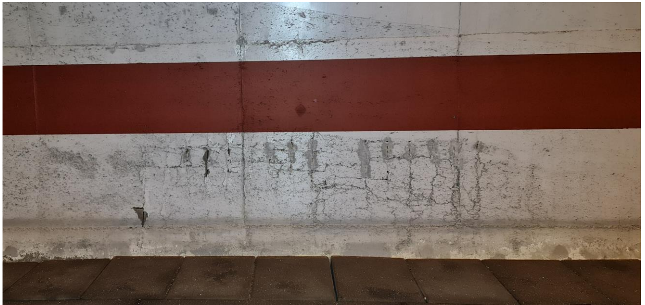
Slika 15: kampada 41 - NEDOSTATAK ZAŠITNOG SLOJA, LJUŠTENJE BETONA
