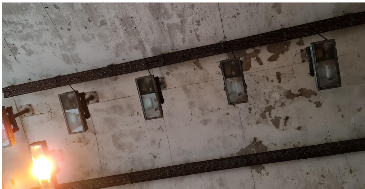
Slika 2: kampada 1 - LJUŠTENJE PREMAZA BETONA SVODA
