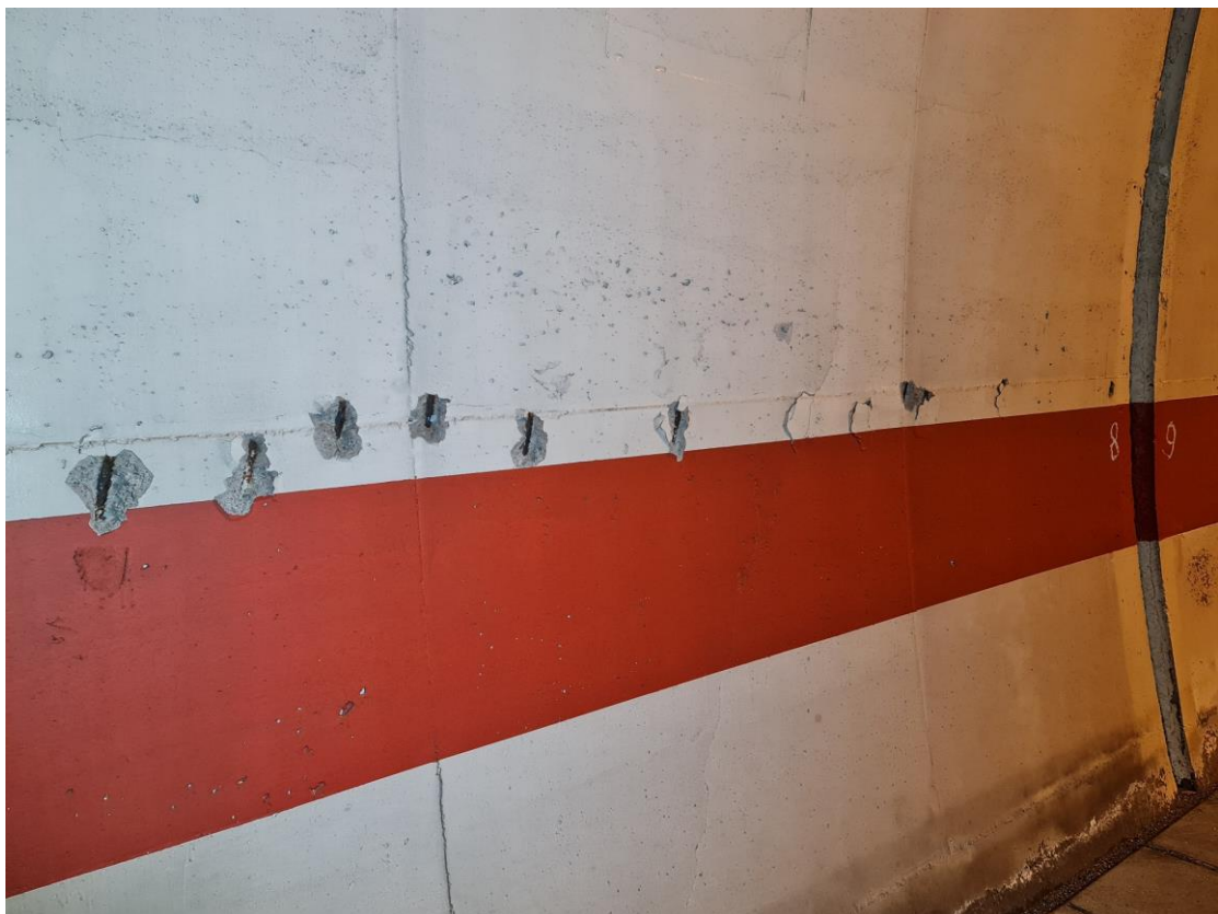
Slika 8: kampada 8 - LJUŠTENJE BETONA, KOROZIJA ARMATURE
