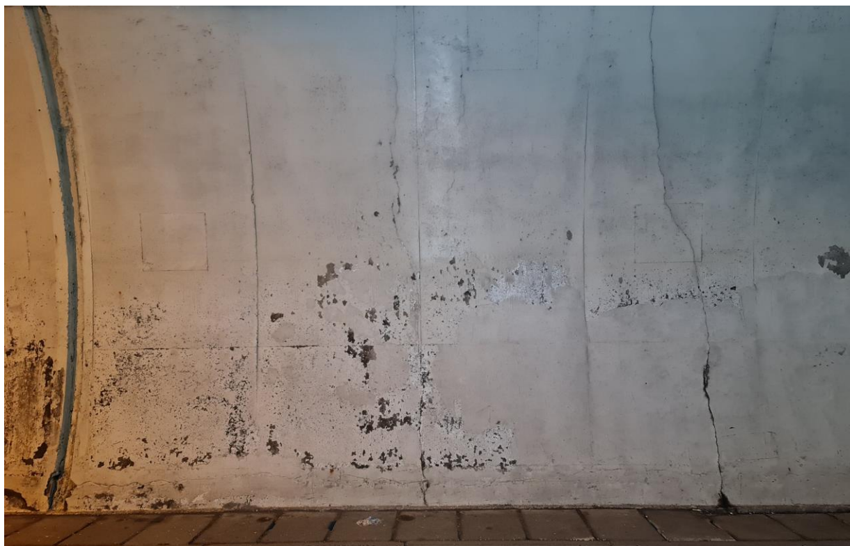
Slika 3: kampada 2 - LJUŠTENJE PREMAZA BETONA I RADIJALNA PUKOTINA
