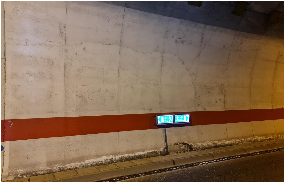
Slika 7: kampada 7 - UZDUŽNA I RADIJALNA PUKOTINA
