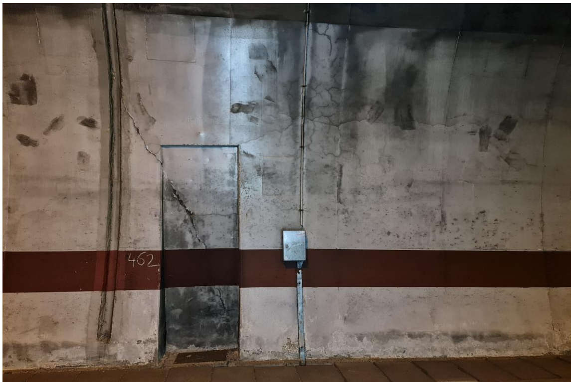
Slika 43: kampada 462 - DIJAGONALA PUKOTINA, MREŽASTE PUKOTINE
