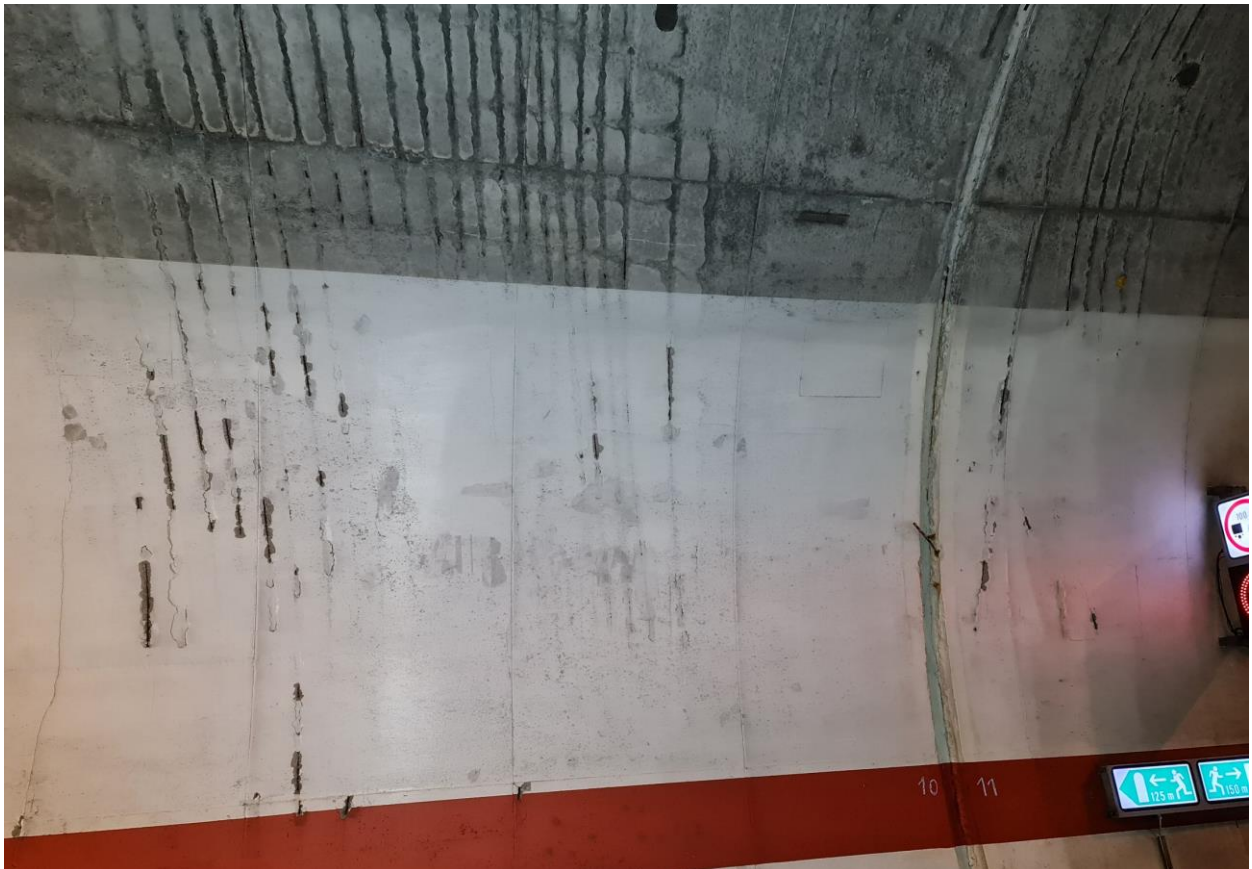
Slika 10: kampada 10 - IZLOŽENA ARMATURA, KOROZIJA, LJUŠTENJE BETONA
