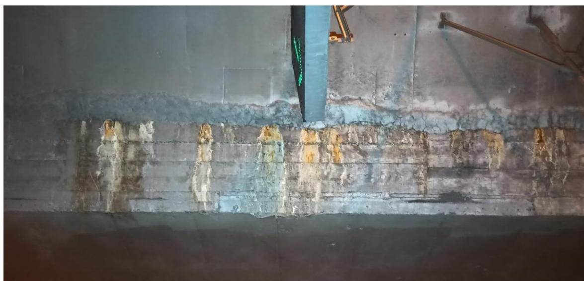
Slika 31: kampada 273 - IZLUŽIVANJE, KOROZIJA ARMATURE
