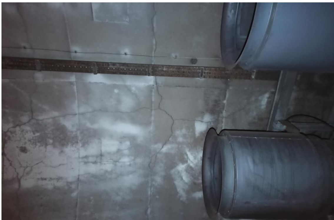
Slika 36: kampada 334 - MREŽASTE PUKOTINE SVODA
