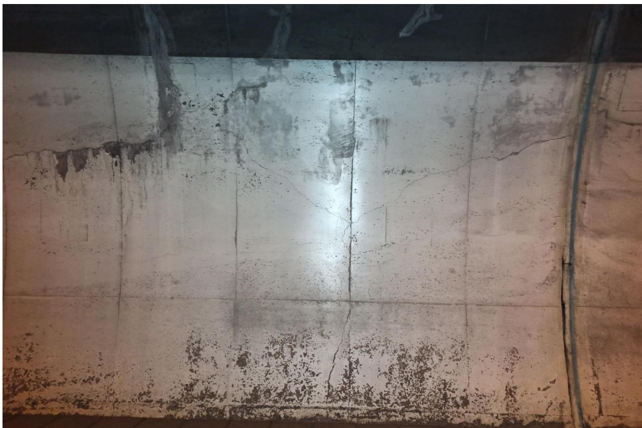
Slika 25: kampada 98 - RADIJALNE/ UZDUŽNE PUKOTINE, LJUŠTENJE PREMAZA I IZLUŽIVANJE
