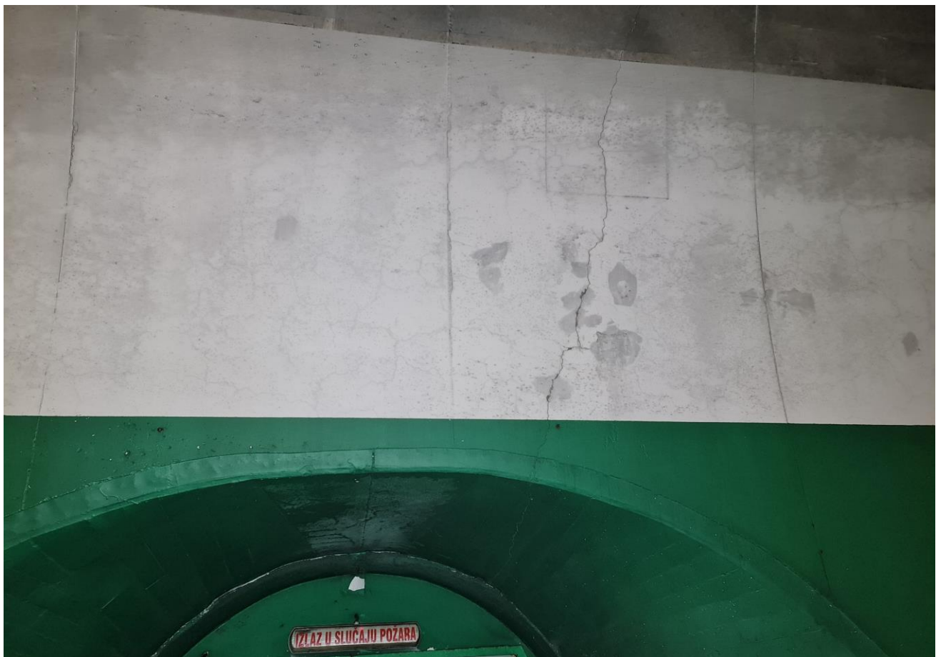
Slika 12: kampada 22 - RADIJALNA PUKOTINA
