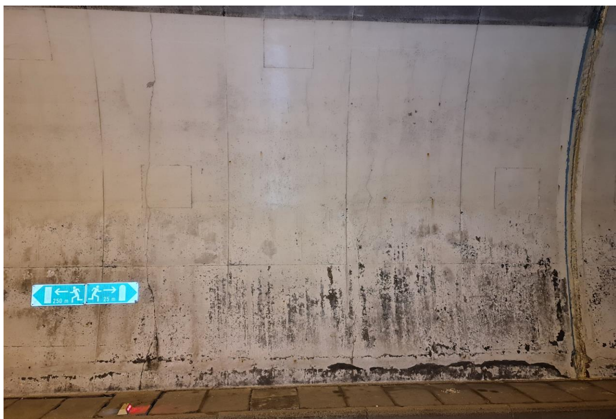
Slika 4: kampada 3 - LJUŠTENJE PREMAZA I RADIJALNE PUKOTINE
