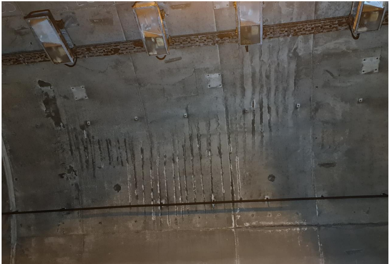
Slika 5: kampada 4 - IZLOŽENA ARMATURA, LJUŠTENJE BETONA
