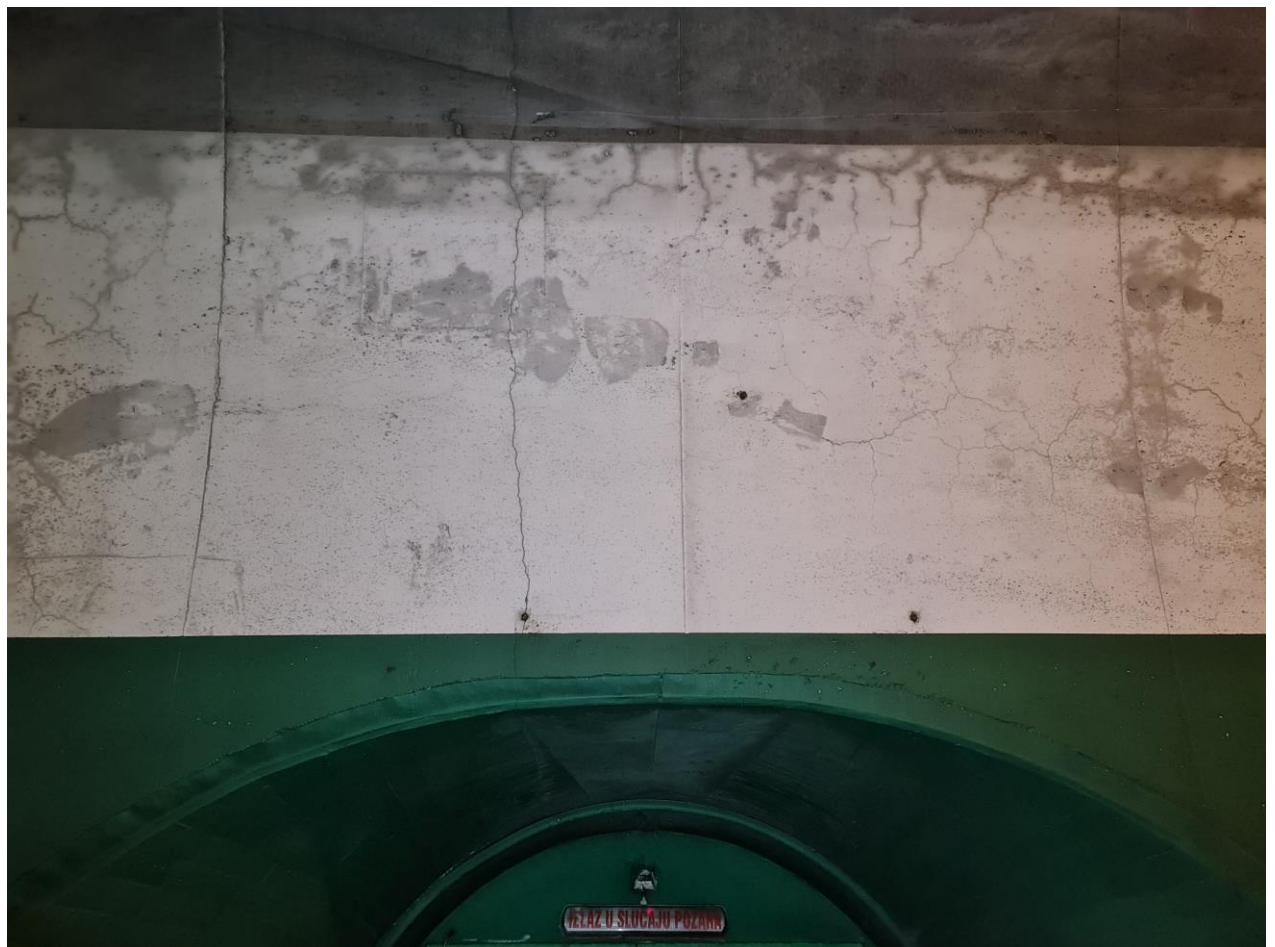
Slika 16: kampada 42 – radijalna pukotina
