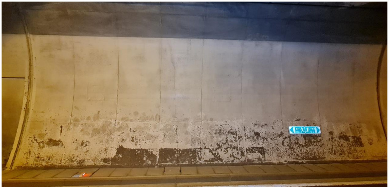
Slika 6: kampada 5 - LJUŠTENJE PREMAZA, RADIJALNA PUKOTINA
