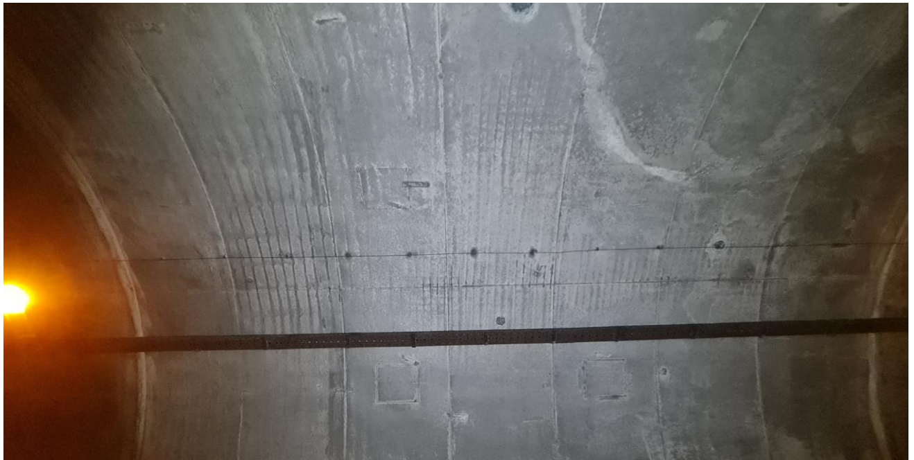
Slika 11: kampada 20 - NEDOSTATAK ZAŠITNOG SLOJA, LJUŠTENJE BETONA
