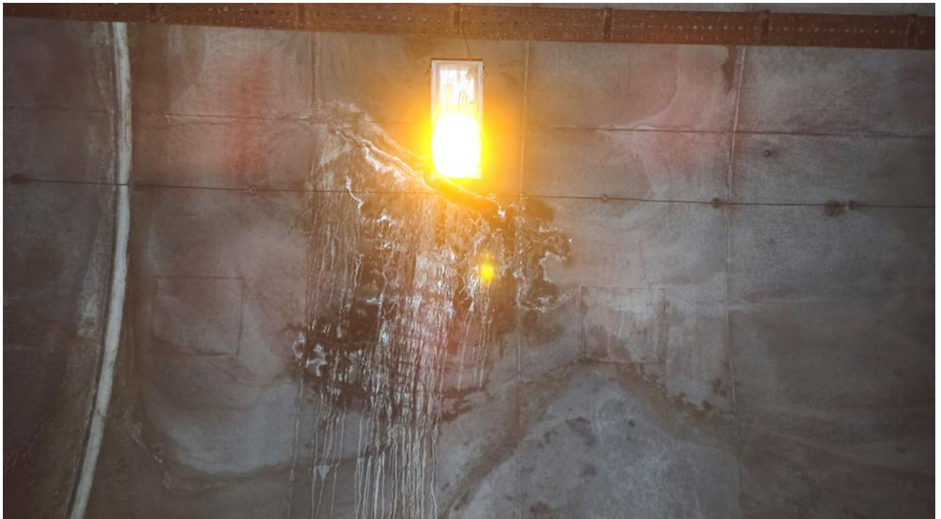
Slika 27: kampada 116 - UZDUŽNA PUKOTINA SA IZLUŽIVANJEM
