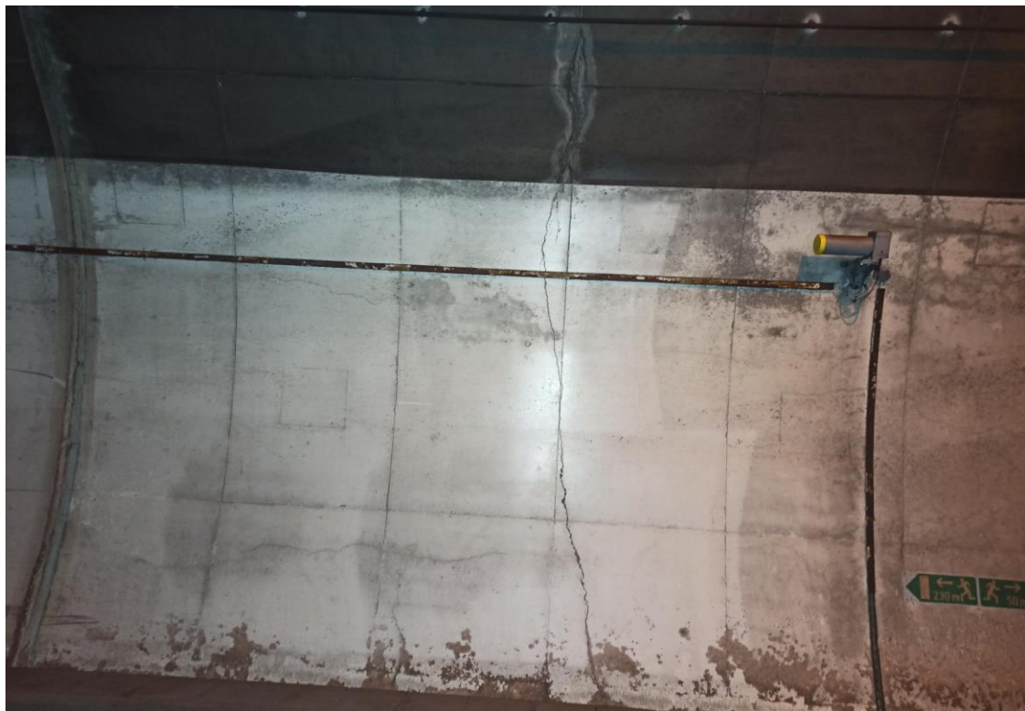
Slika 28: kampada 118 - RADIJALNA PUKOTINA SA IZLUŽIVANJEM, LJUŠTENJE PREMAZA
