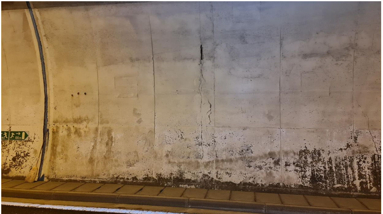
Slika 9: kampada 10 - LJUŠTENJE PREMAZA, LJUŠTENJE BETONA, KOROZIJA ARMATURE
