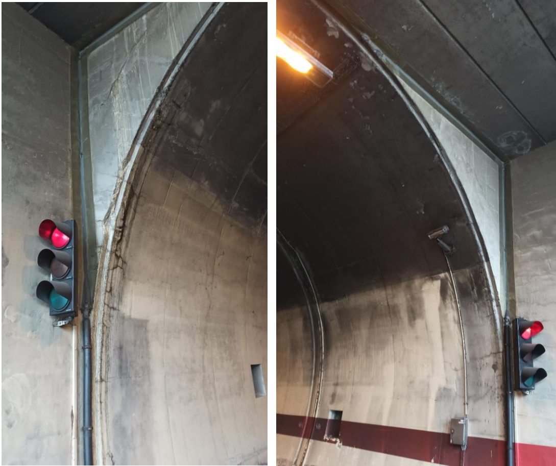
Slika 45: kampada 486 - LJUŠTENJE NA SPOJNICI, VLAŽENJE I MREŽASTE PUKOTINE
