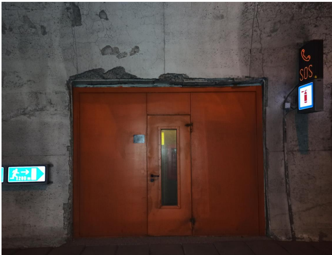
Slika 35: kampada 305 - MREŽASTE PUKOTINE, ODLAMANJE BETONA I LJUŠTENJE PREMAZA
