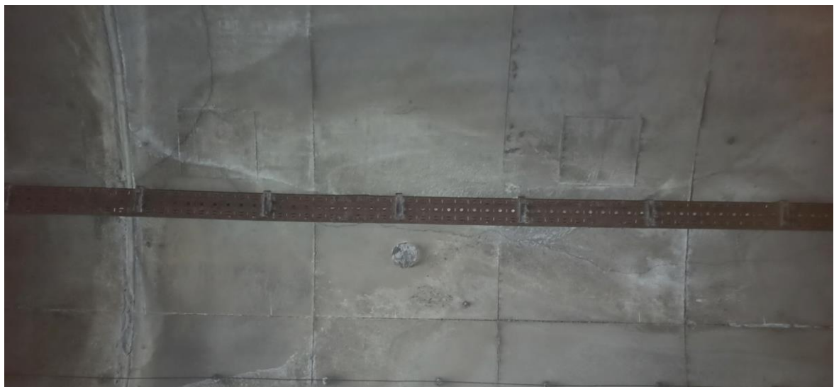
Slika 33: kampada 285 - UZDUŽNA PUKOTINA NA SVODU
