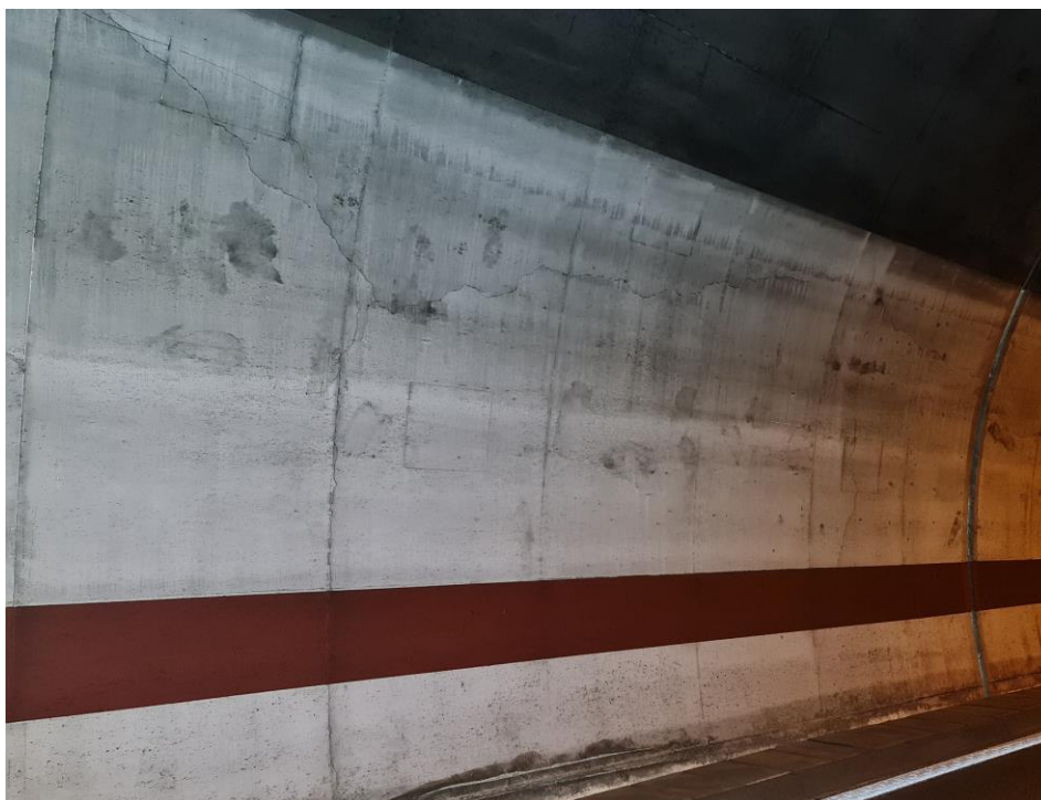
Slika 38: kampada 376 - UZDUŽNE I RADIJALNE PUKOTINE
