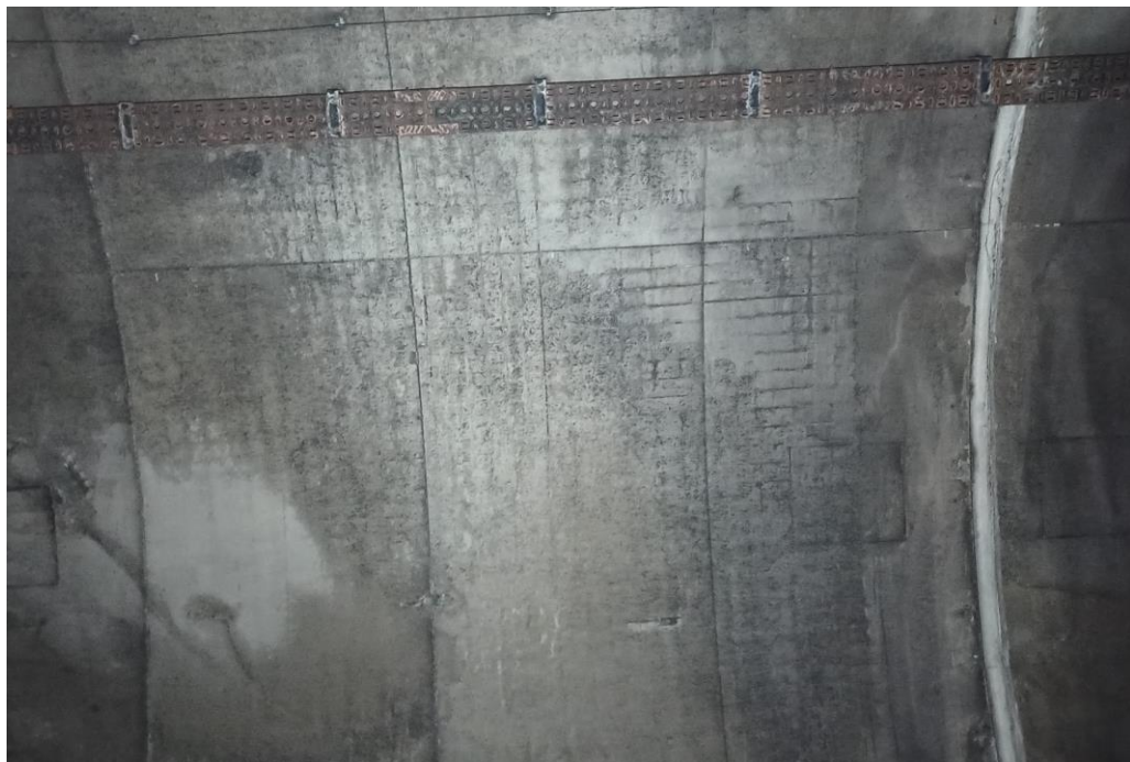
Slika 44: kampada 463 - NEDOSTATAK ZAŠTITNOG SLOJA, SEGREGACIJA
