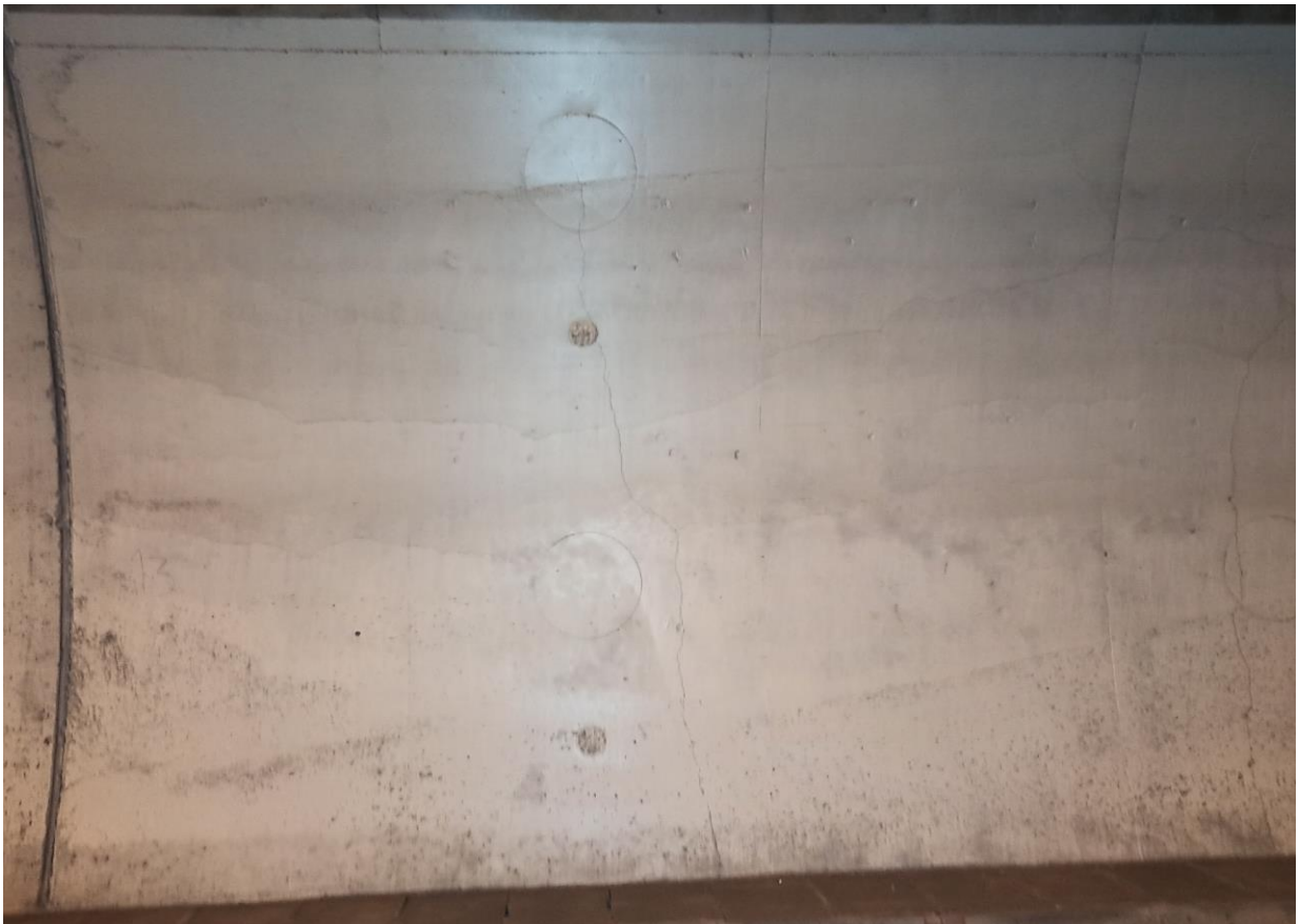
Slika 6: Kampada 13 - RADIJALNE I UZDUŽNE PUKOTINE
