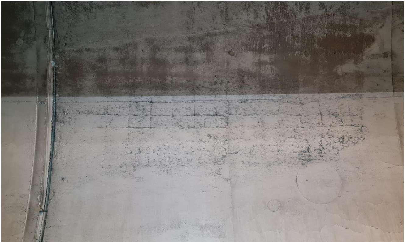
Slika 7: Kampada 57 - NEDOSTATAK ZAŠTITNOG SLOJA, SEGREGACIJA BETONA
