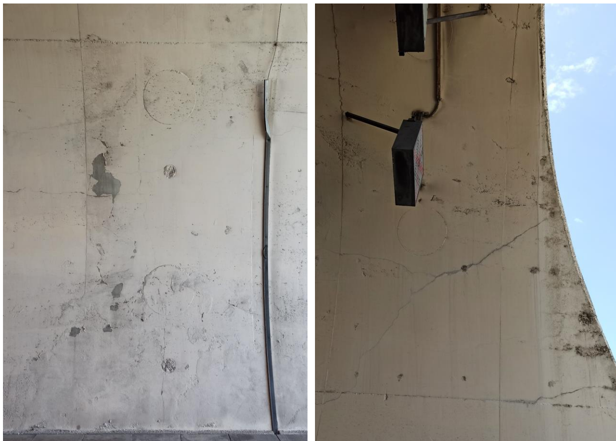
Slika 1: Ulazni portal - DIJAGONALNE PUKOTINE I LJUŠTENJE PREMAZA BETONA
