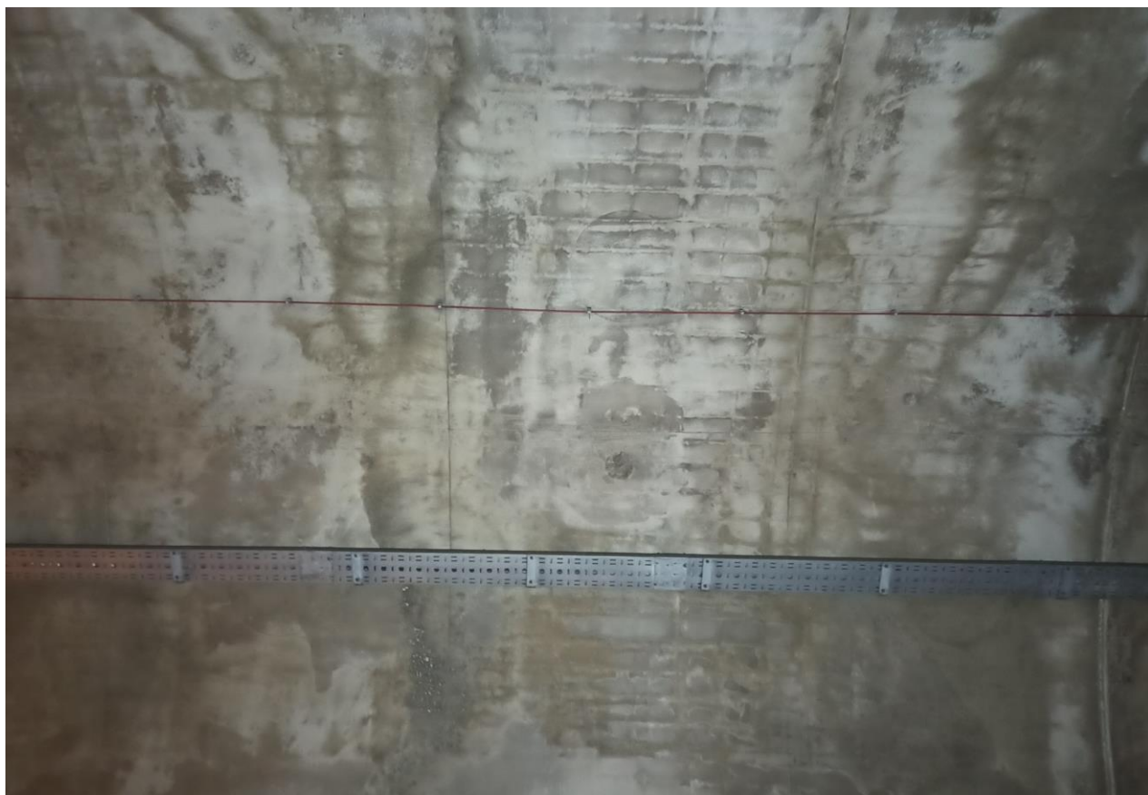
Slika 9: Kampada 17 - NEDOSTATAK ZAŠTITNOG SLOJA
