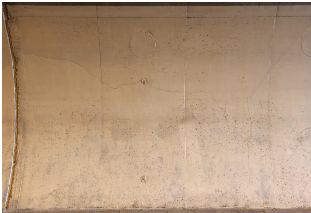
Slika 2: Kampada 3 - UZDUŽNE I RADIJALNE PUKOTINE
