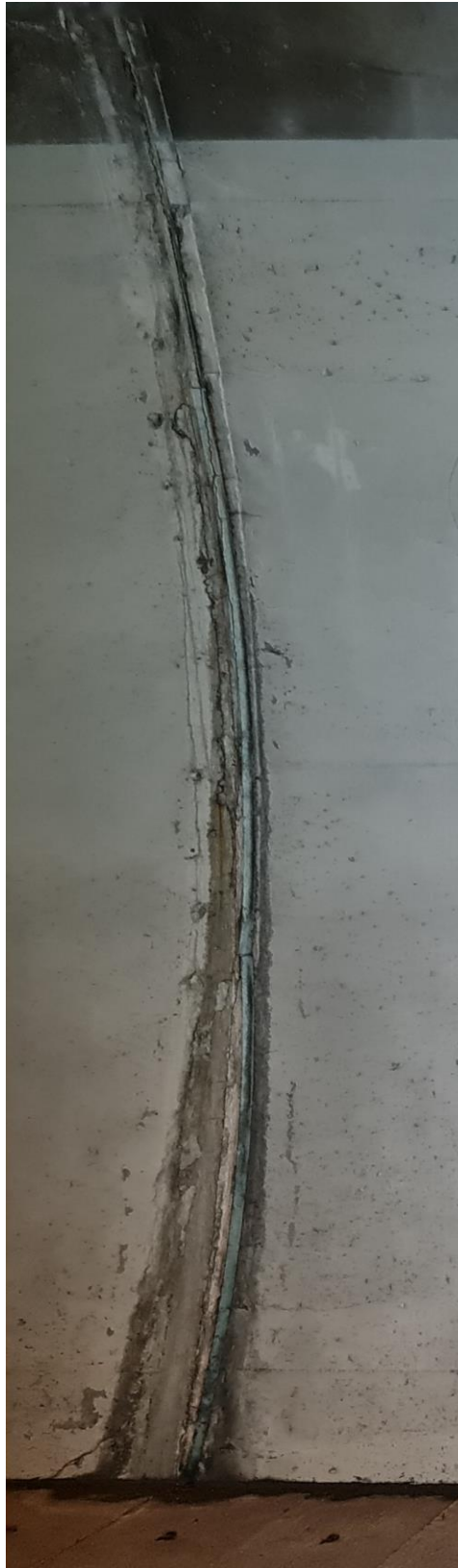
Slika 12: Dilatacijska reška između kampada 48 i 49 - LJUŠTENJE, PROCURIVANJE I CVJETANJE SPOJNICE
