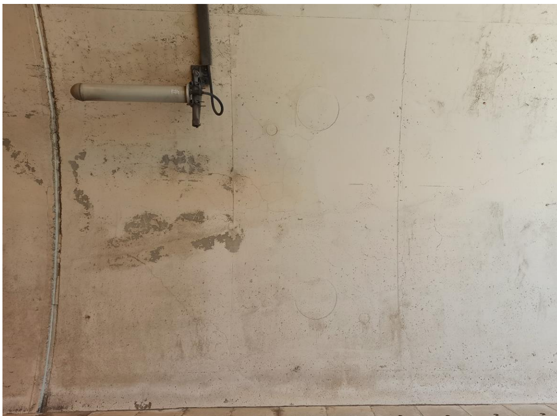
Slika 14: Kampada 74 - MREŽASTE PUKOTINE I LJUŠTENJE PREMAZA
