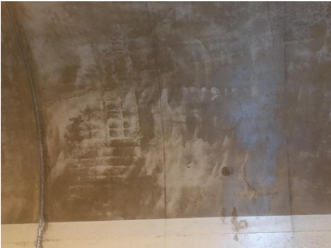
Slika 3: Kampada 8 - NEDOSTATAK ZAŠTITNOG SLOJA
