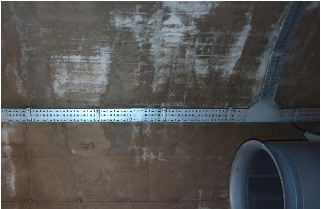
Slika 5: Kampada 11 - NEDOSTATAK ZAŠITNOG SLOJA
