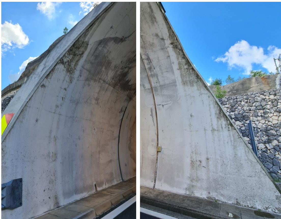
Slika 1: Ulazni portal - LJUŠTENJE PREMAZA BETONA
