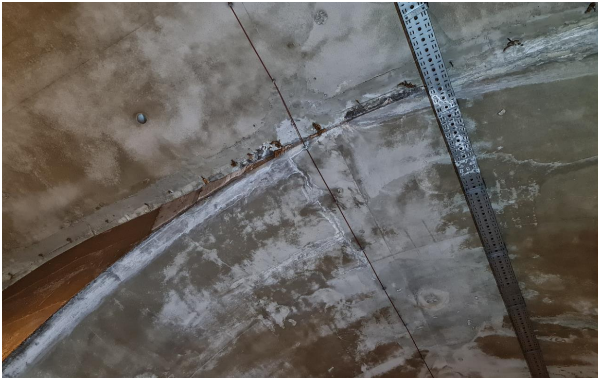
Slika 3: Dilatacijska reška između kampada br. 32 i 33
