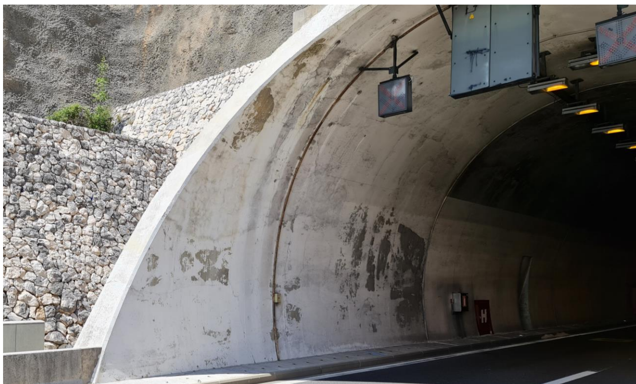
Slika 12: Izlazni portal - LJUŠTENJE PREMAZA, MREŽASTE PUKOTINE
