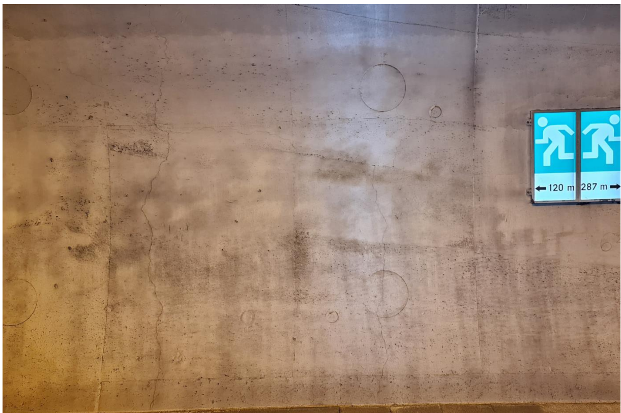
Slika 11: Kampada 63 - RADIJALNE PUKOTINE
