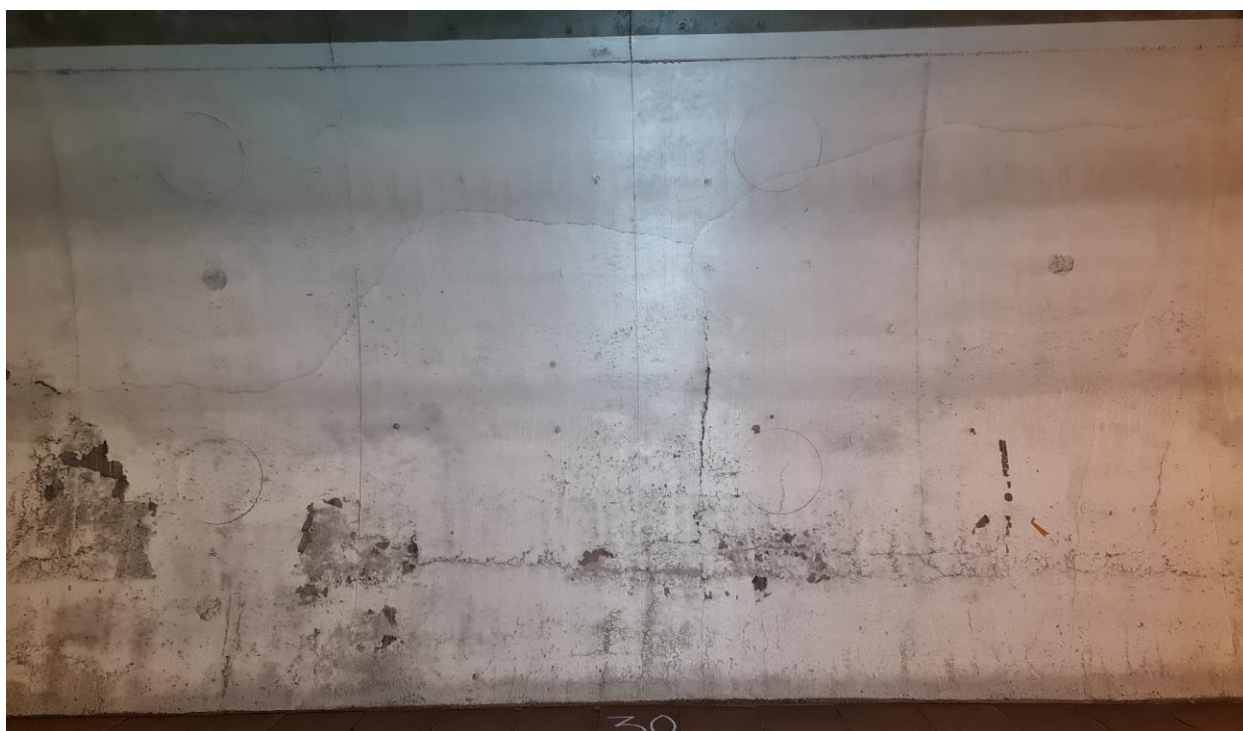
Slika 2: Kampada 30 - UZDUŽNE I RADIJALNE PUKOTINE, LJUŠTENJE PREMAZA
