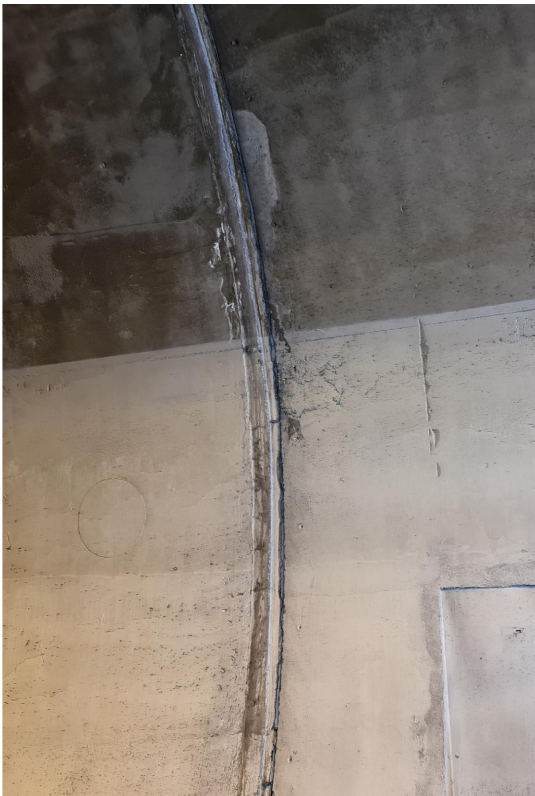
Slika 9: Kampada 67 - ODLAMANJE BETONA NA SPOJNICI
