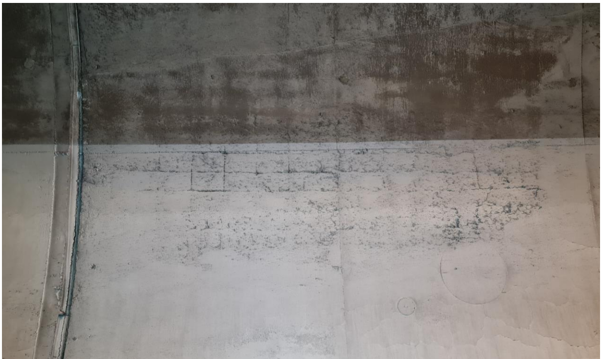
Slika 8: Kampada 57 - NEDOSTATAK ZAŠTITNOG SLOJA, SEGREGACIJA BETONA
