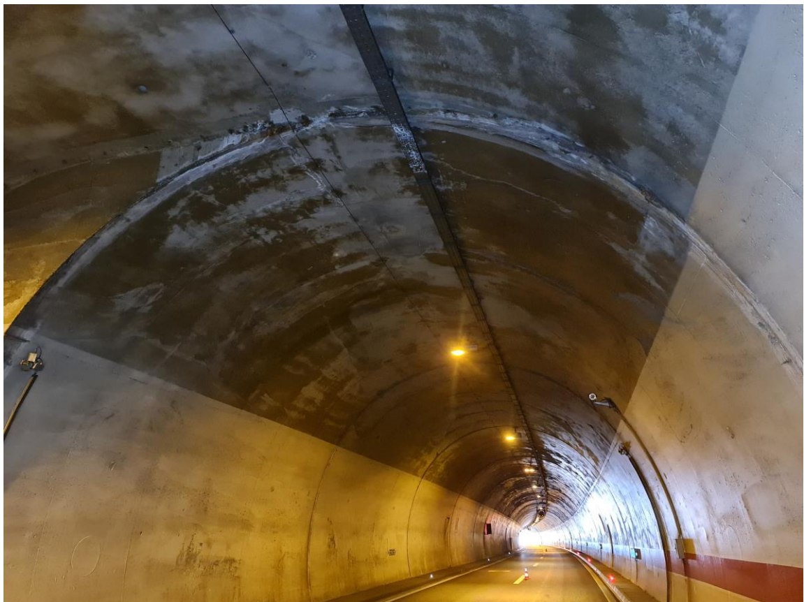
Slika 4: Dilatacijska reška između kampada br. 32 i 33
