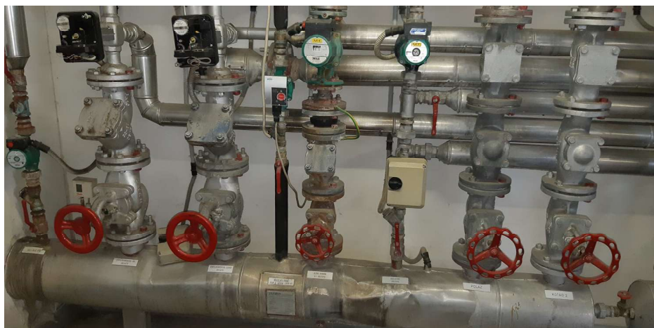
Slika 2. Razdjelnik (polaz) sa krugovima grijanja i pripadajućom armaturom - 1. dio
