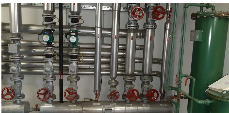
Slika 4. Sabirnik (povrat) sa krugovima grijanja i pripadajućom armaturom te omešivač vode
