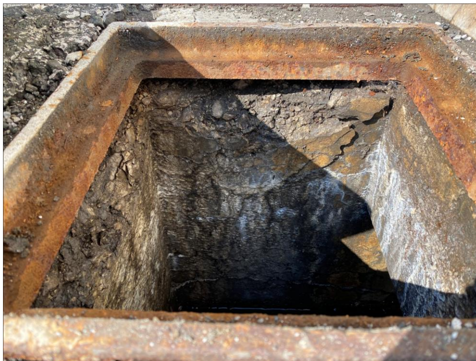
Slika 4: Oštećenja i jako loše stanje unutrašnje strane strane zida sifonskog okna
