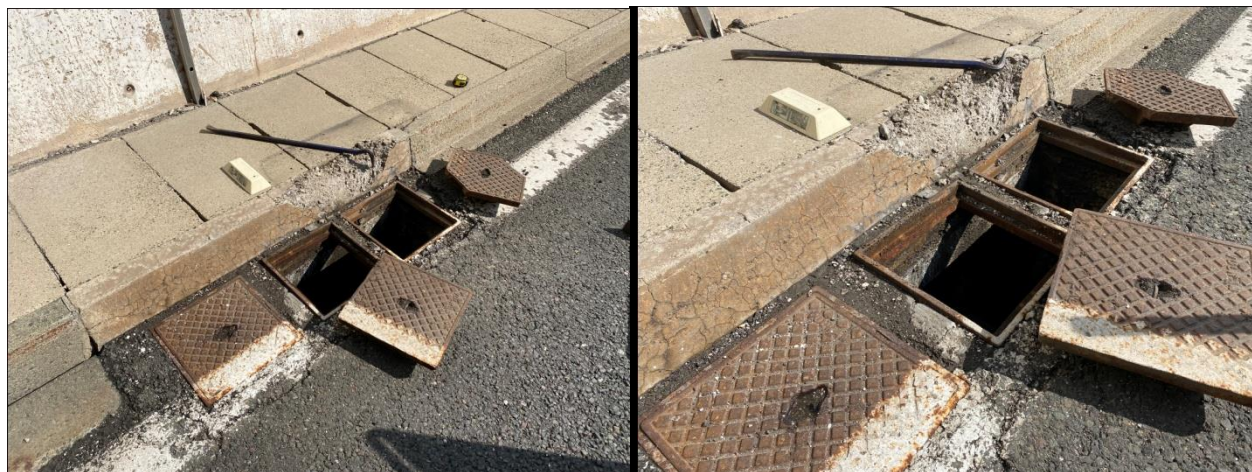
Slika 1: Poklopci sifonskog okna - poklopac najbliži ulasku u tunel je na uglovima oštećen na dva mjesta; vidljiva oštećenja na rubnjaku
