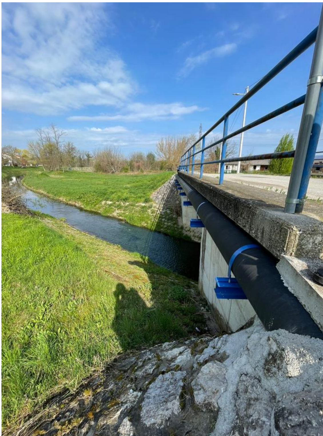
Slika 4 Vodoopskrbni cjevovod d110 mm (2021. g.) u zaštitnoj cijevi preko potoka Brvnica
