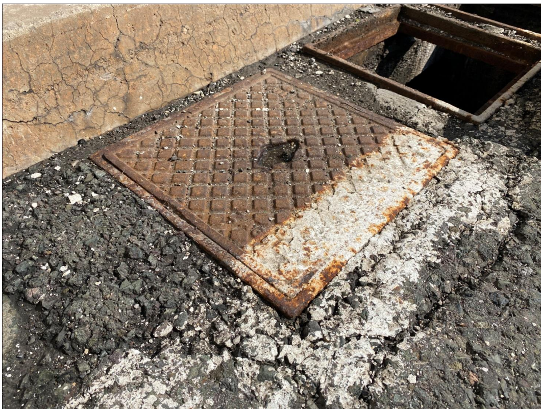
Slika 2: Asfalt oko poklopca je raspucao, došlo je do utonuća poklopca
