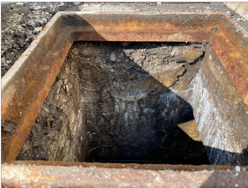
Slika 4: Oštećenja i jako loše stanje unutrašnje strane strane zida sifonskog okna
