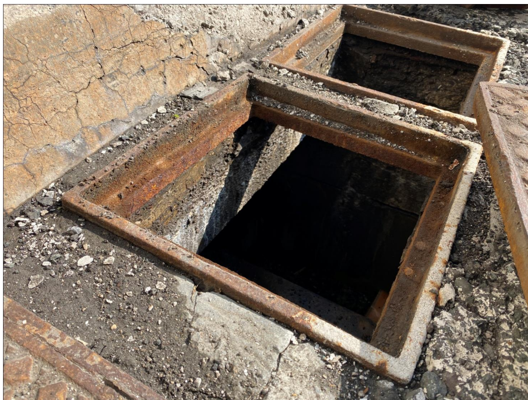
Slika 3: Raspucali asfalt oko srednjeg poklopca
