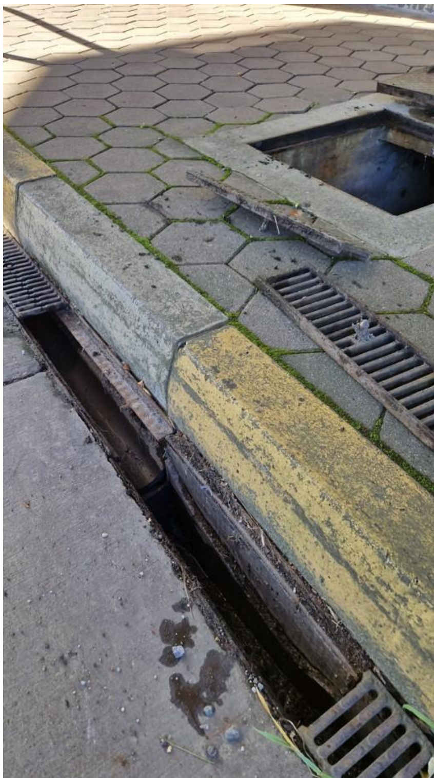
Slika 2. Oštećeni kanal linijske odvodnje u ulaznoj stazi 1NP ( smjer AC A4 )
