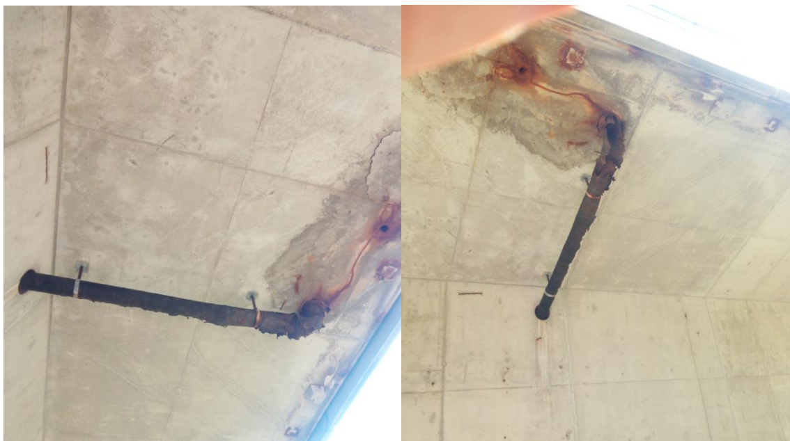
Slika 5 i Slika 6: Na slikama su prikazani dijelovi čelične cijevi koji izlaze van trupa vijadukta prema slivniku. U jako su lošem stanju te ih je potrebno zamijeniti.
