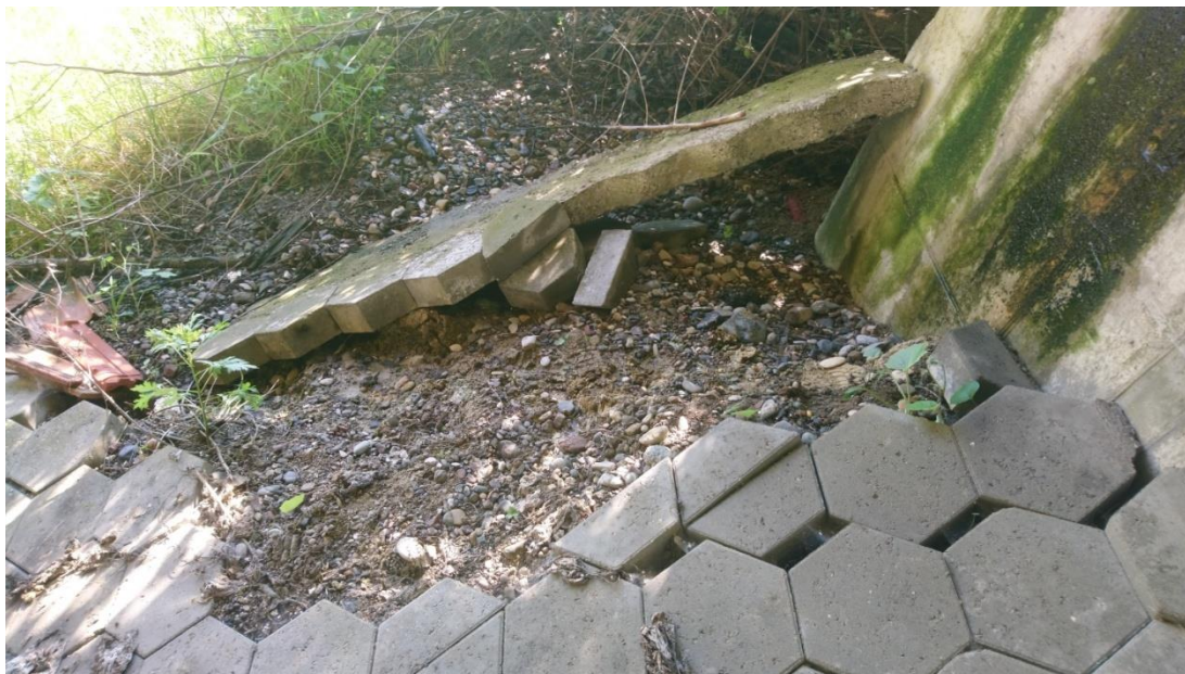
Slika 11. Urušavanje betonske galanterije
