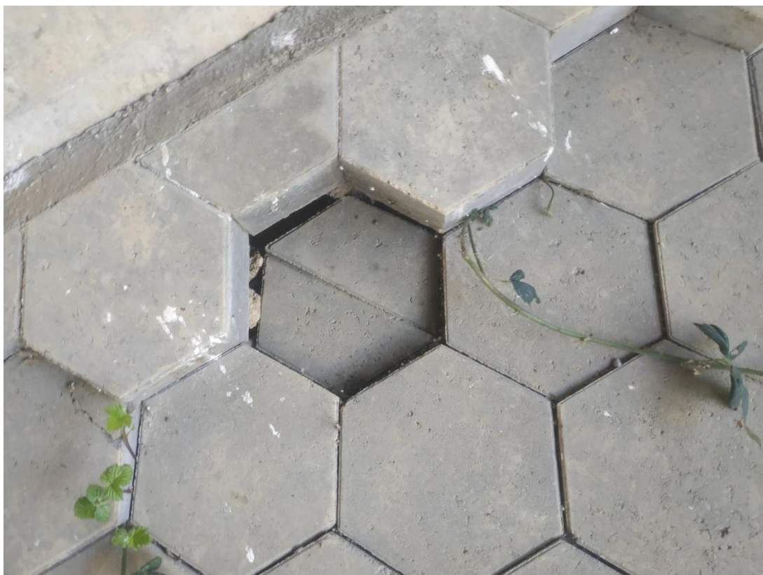
Slika 18. Detalj oštećenja betonske obloge pokosa na desnoj strani
