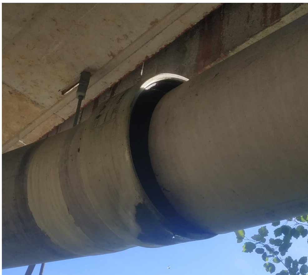
Slika 7. Otklon cijevi oborinske odvodnje
