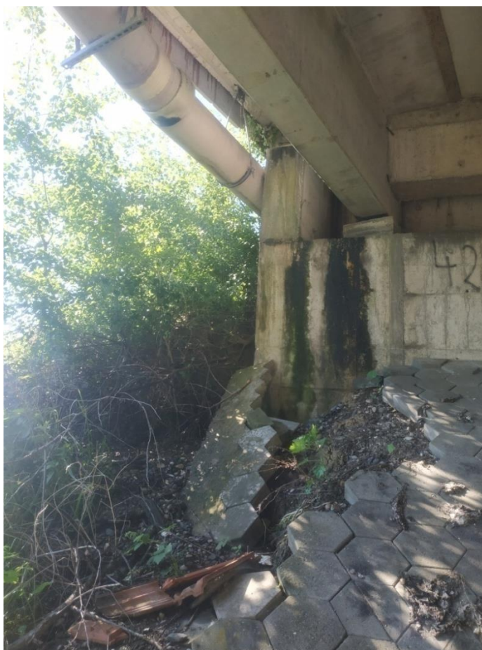
Slika 12. Urušavanje betonske galanterije
