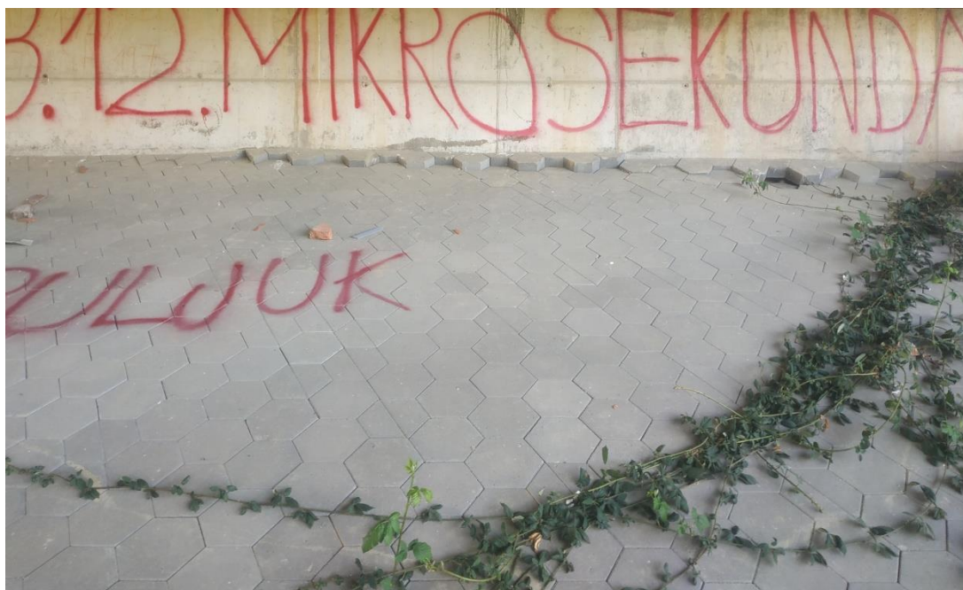
Slika 17. Stanje betonske obloge pokosa na desnoj strani
