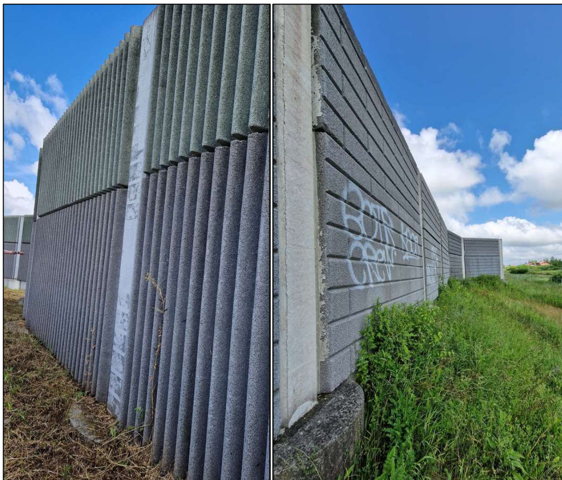
Slika 2. Prednja strana zida (a) i stražnja strana zida (b)
