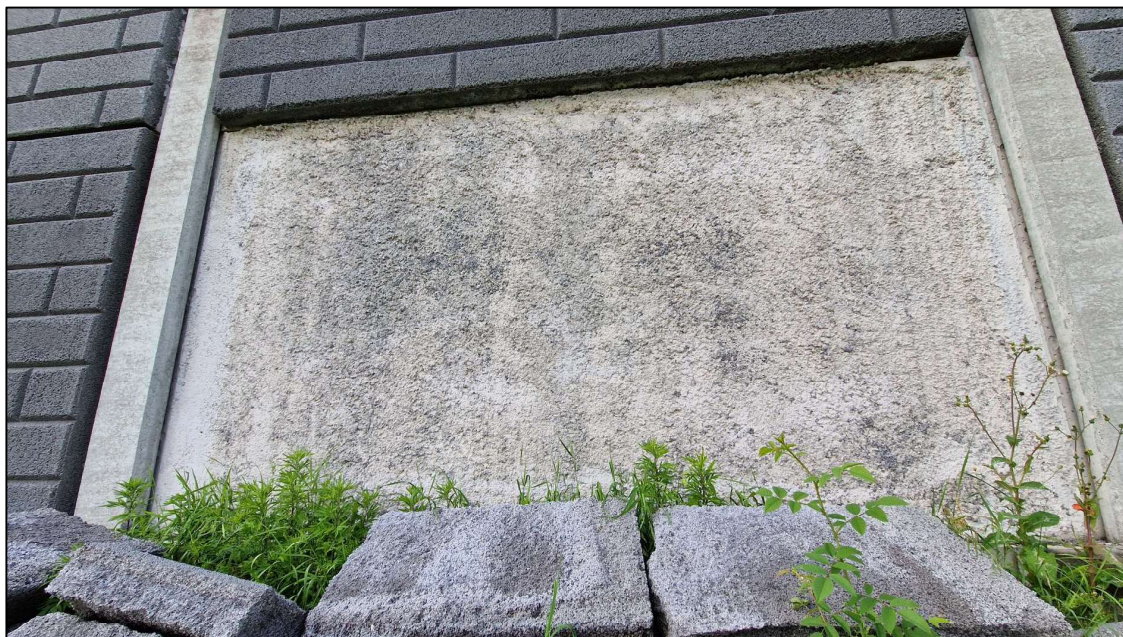
Slika 4. Oštećenje panela i ispala obloga s panela
