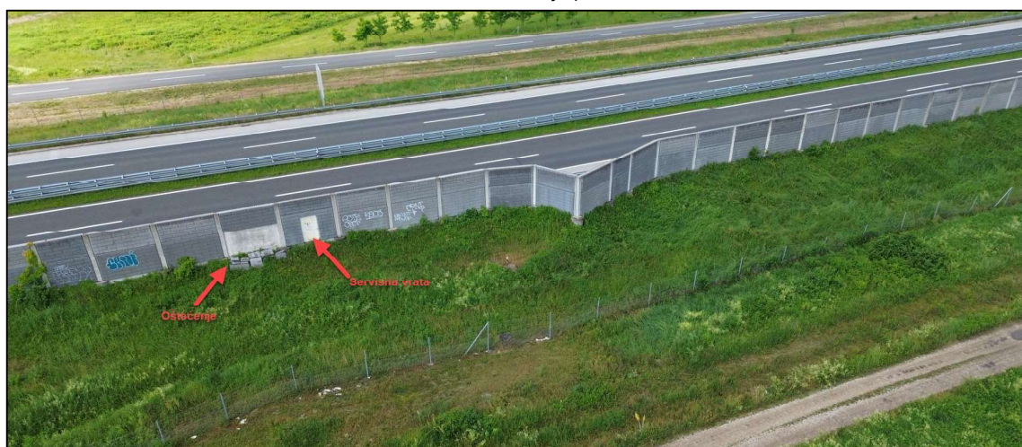
Slika 6. Oštećenje panela i servisna vrata
