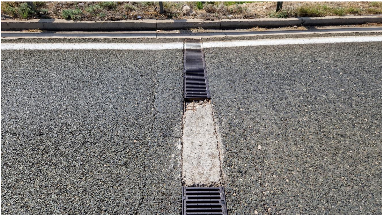
Slika 3. Oštećeni kanal linijske odvodnje u stazi 6 ( izlazna staza NP, smjer grad Šibenik )
