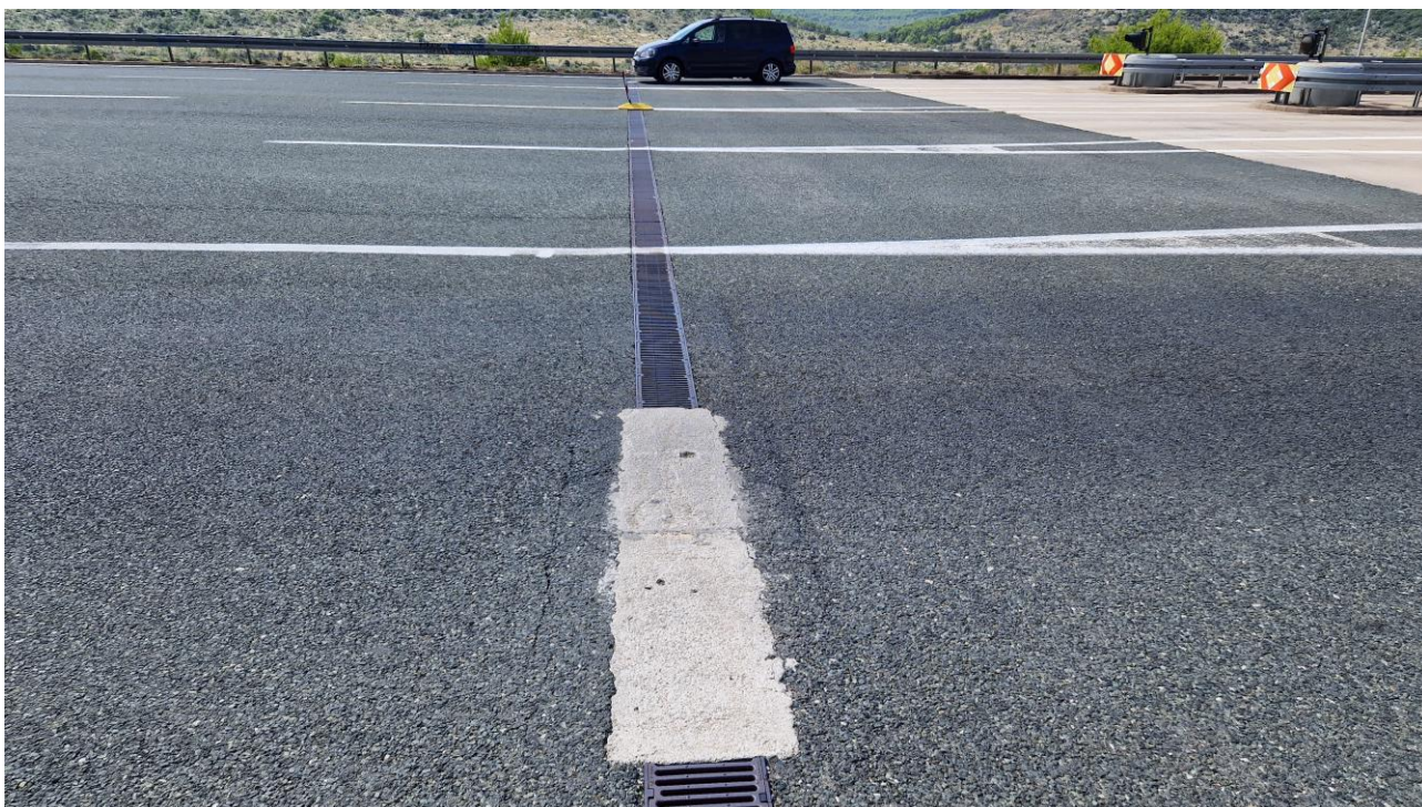
Slika 2. Oštećeni kanal linijske odvodnje u stazi 2 ( izlazna staza NP, smjer grad Šibenik )
