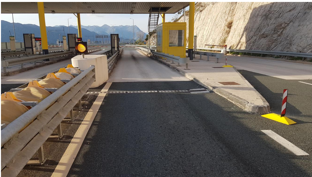
Slika 7. Oštećeni kanal linijske odvodnje u stazi 1 ( ulazna staza ČCP, smjer Vrgorac )
