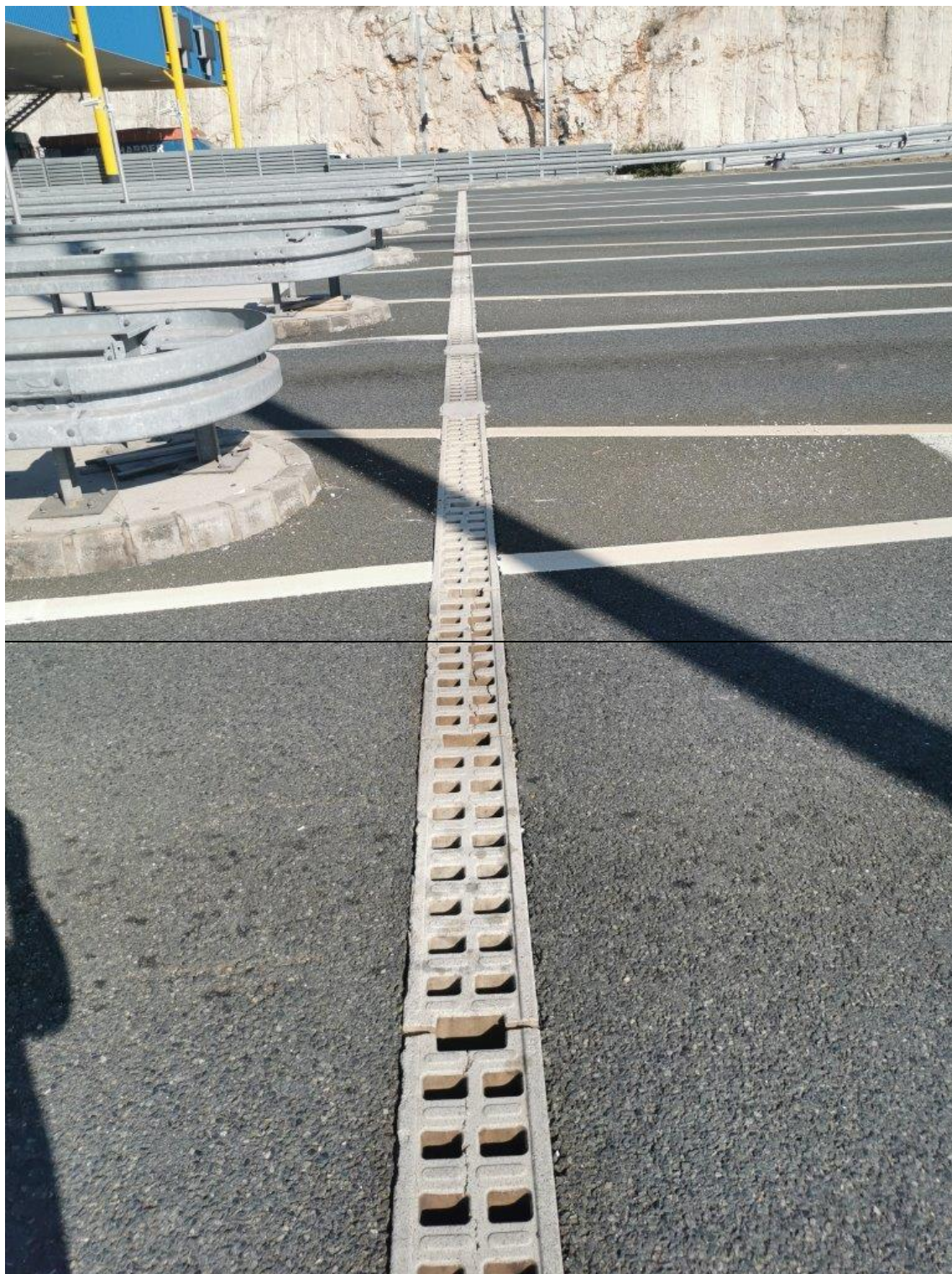
Slika 1. Pogled na kanal linijske odvodnje ( izlazna strana ČCP, smjer Dubrovnik )
