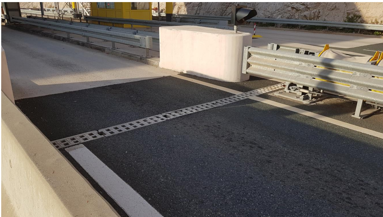
Slika 6. Oštećeni kanal linijske odvodnje u stazi 3 ( ulazna staza ČCP, smjer Vrgorac )
