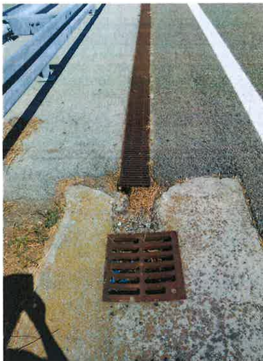
Slika 1. Službeni prolaz SP_2 – početak linijskog kanala – izljev u postojeći slivnik SLp1 ( gledano u smjeru Čvora Čepin )
