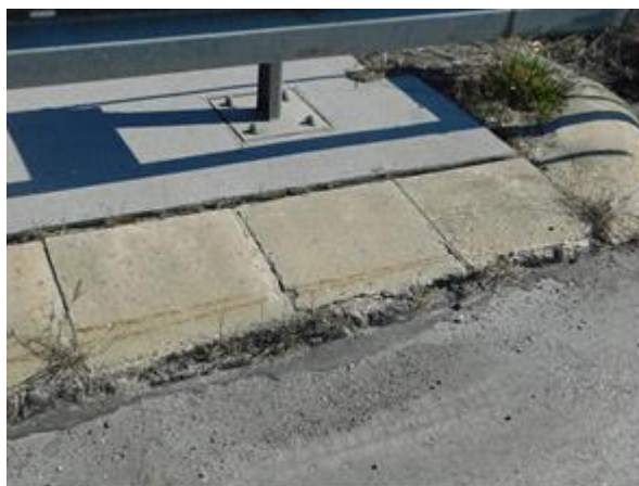
Slika 6_Propust u km 76+729, vanjska staza. Ljuštenje
