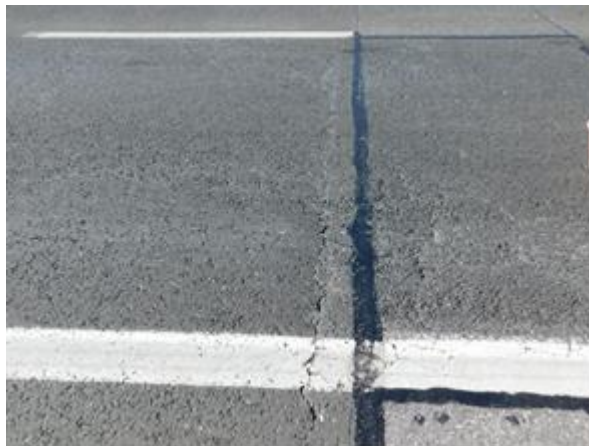
Slika 4_Propust u km 77+130. Poprečna reflektirajuća pukotina od slojeva ispod, uz formiranje „aligatorskih pukotina“ u zoni prolaska kotača vozila
