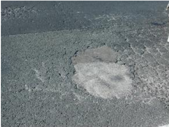
Slika 7_Propust u km 76+729, vozni trak. Aligatorske pukotine i sanirana udarna jama.
