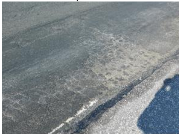
Slika 3_Propust u km 77+130, vozni trak. Pukotine uz formiranje udarne rupe
