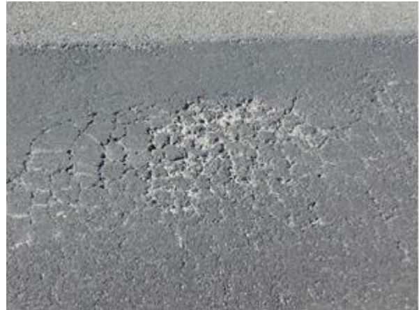
Slika 8_Propust u km 76+729, vozni trak. Uznapredovale aligatorske pukotine, počinje se formirati udarna jama.
