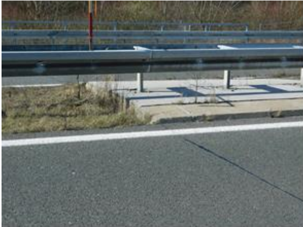
Slika 9_Propust u km 76+729, staza u centralnom pojasu. Ljuštenje betona rubnjaka, pukotine u lijevanom asfaltu, reške ispunjene vegetacijom.
