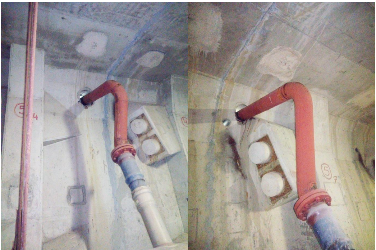
Slika 4 i Slika 5: Vidljivo je zahvaćanje cijevi korozijom na koljenima i u blizini prirubnice. Cijevi je potrebno zamijeniti.
