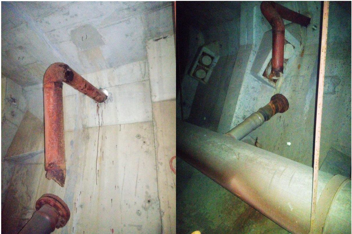
Slika 1 i Slika 2: Korozija je zahvatila cijevi u tolikoj mjeri da nedostaju pojedini dijelovi cijevi
