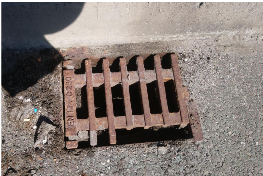
Slika 2: Rešetka slivnika je oštećena i nema pante.
