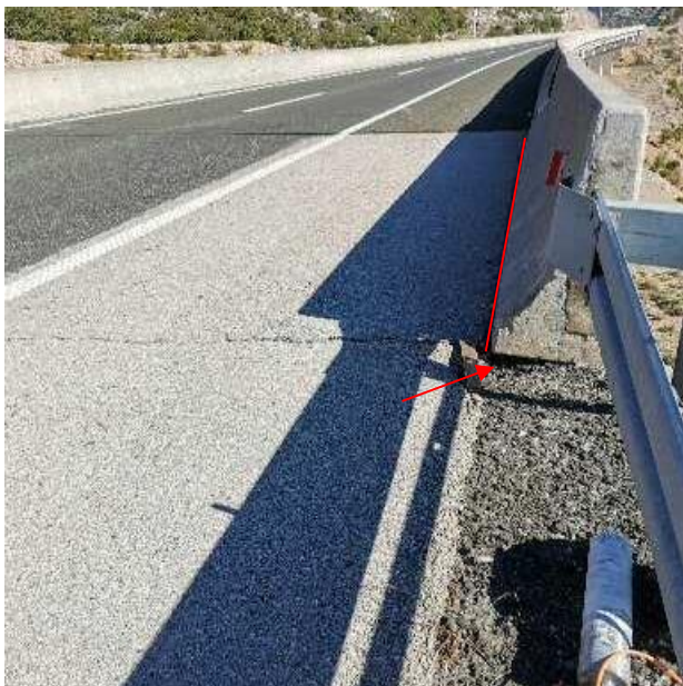
Slika4_Zona otvorene reške između NJ odbojne ograde i asfalta kolnika, a na dijelu konzole iznad vanjskog krila upornjaka
