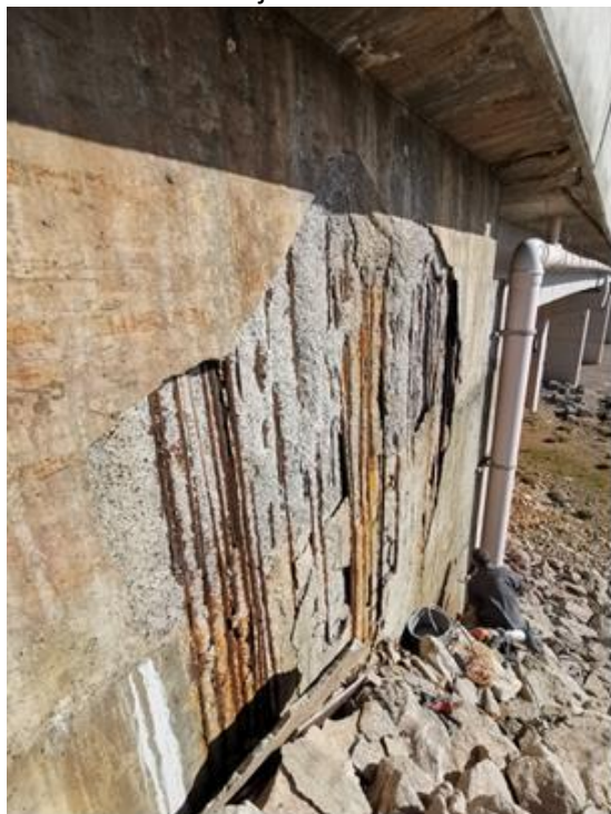
Slika 2_Otpadanje zaštitnog sloja i korozija armature na vanjskom krilu upornjaka U2
