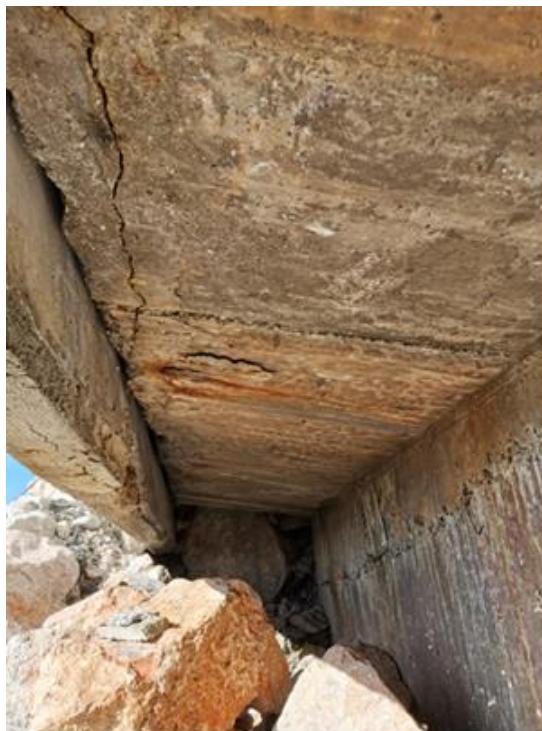
Slika 3_Mrlje od korozije armature i raspucavanje zaštitnog sloja betona na podgledu konzole iznad U2
