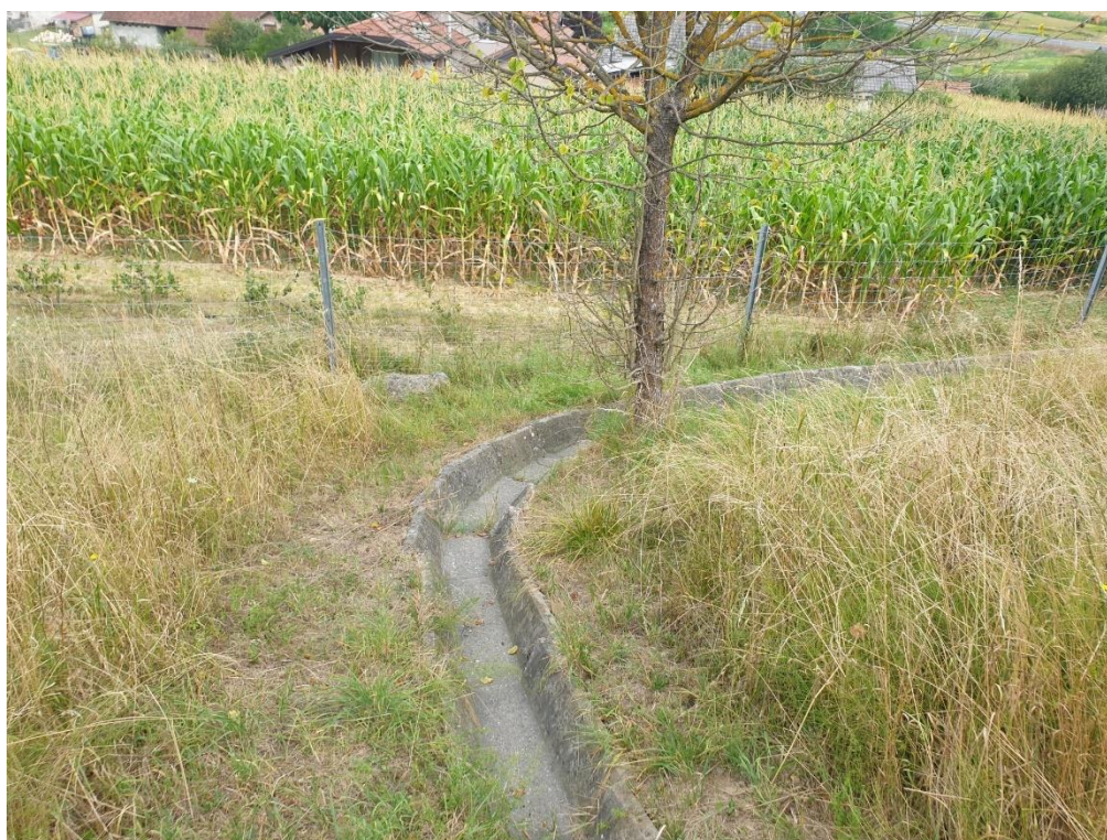
Slika 6. Pregled predmetne lokacije - Prikaz trapezne kanalice i okolnih privatnih parcela koje se plave za vrijeme oborina
