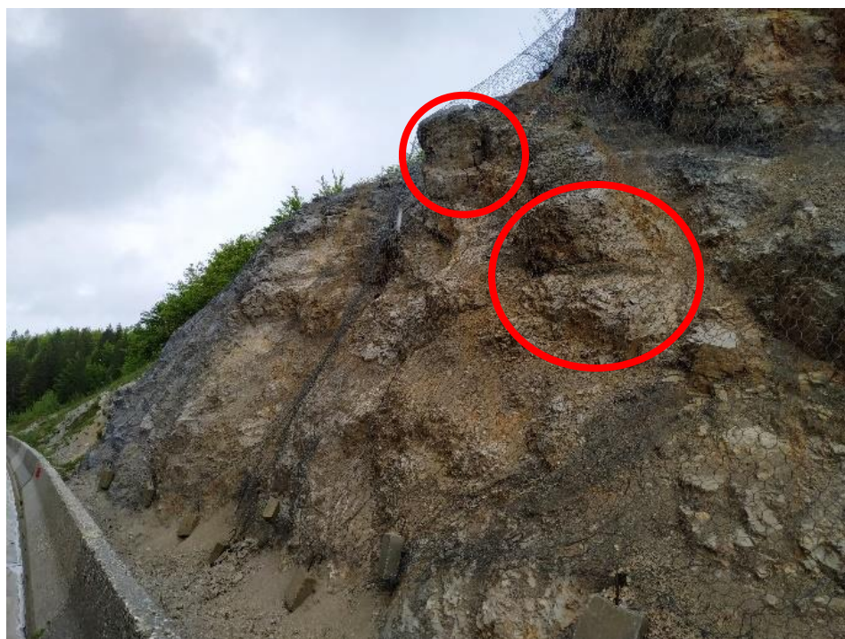
Slika 19. Prikaz nestabilnosti formiranih u naslagama dolomita u sklopu desnog pokosa predmetnog usjeka; blok u prevjesu cca 5,0 m 3 (slika lijevo) i blok u prevjesu cca 2,0 m 3 (slika desno)
