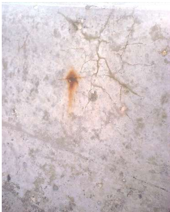
pukotine i smeđe mrlje uslijed korozije
