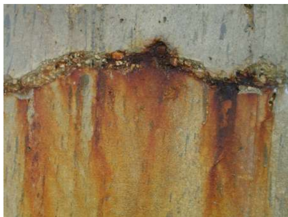
horizontalna pukotina u zidu upornjaka
