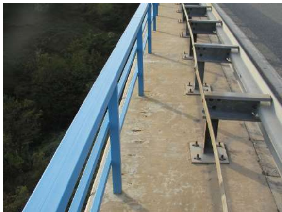
vidljiva korodirana armatura
