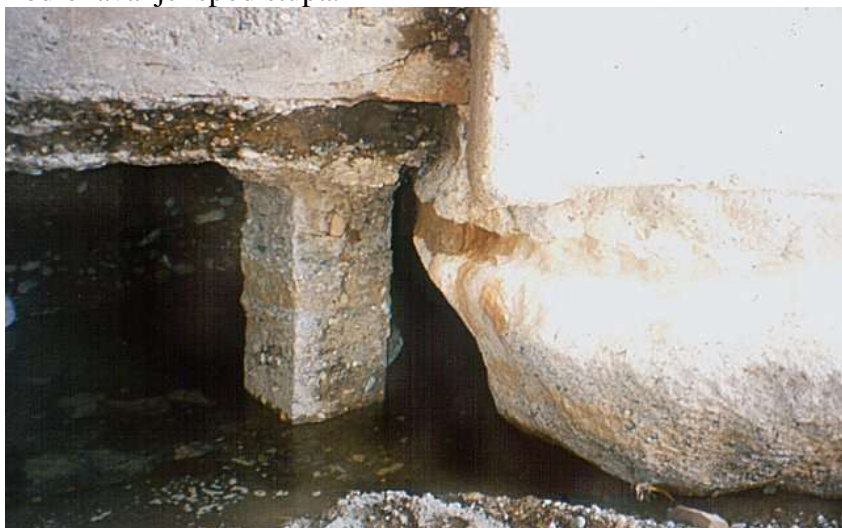
Podlokavanje ispune ispod upornjaka uslijed protoka vode
