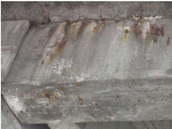
smeđe mrlje od korozije na glavnim nosačima
