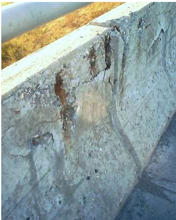
odlamanje zaštitnog sloja, izložene korodirane šipke
