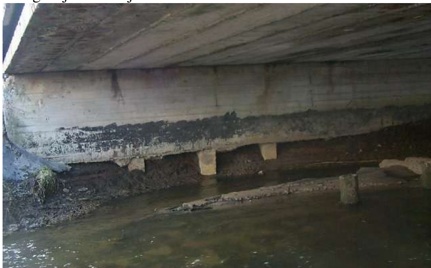
Podlokavanje ispod zida upornjaka.
