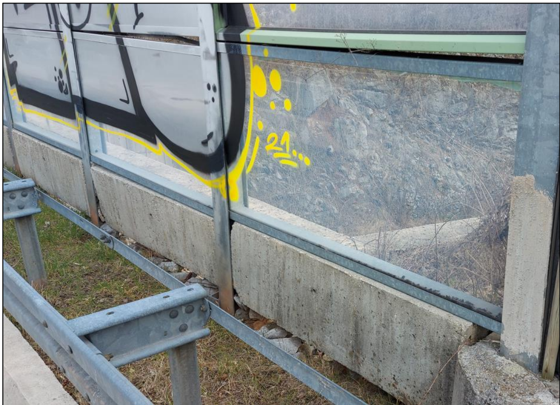
Slika 13. km 9+000.00 - 9+500.00 - stanje naglavnih greda i transparentnih panela na nadvožnjaku
