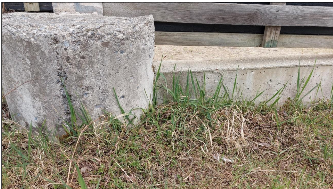
Slika 6. km 0+400.00 – propadanje naglavne grede u tlo/erozija
