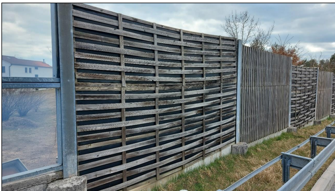
Slika 2. km 0+400.00 – karakteristično oštećenje drvenog panela (2)
