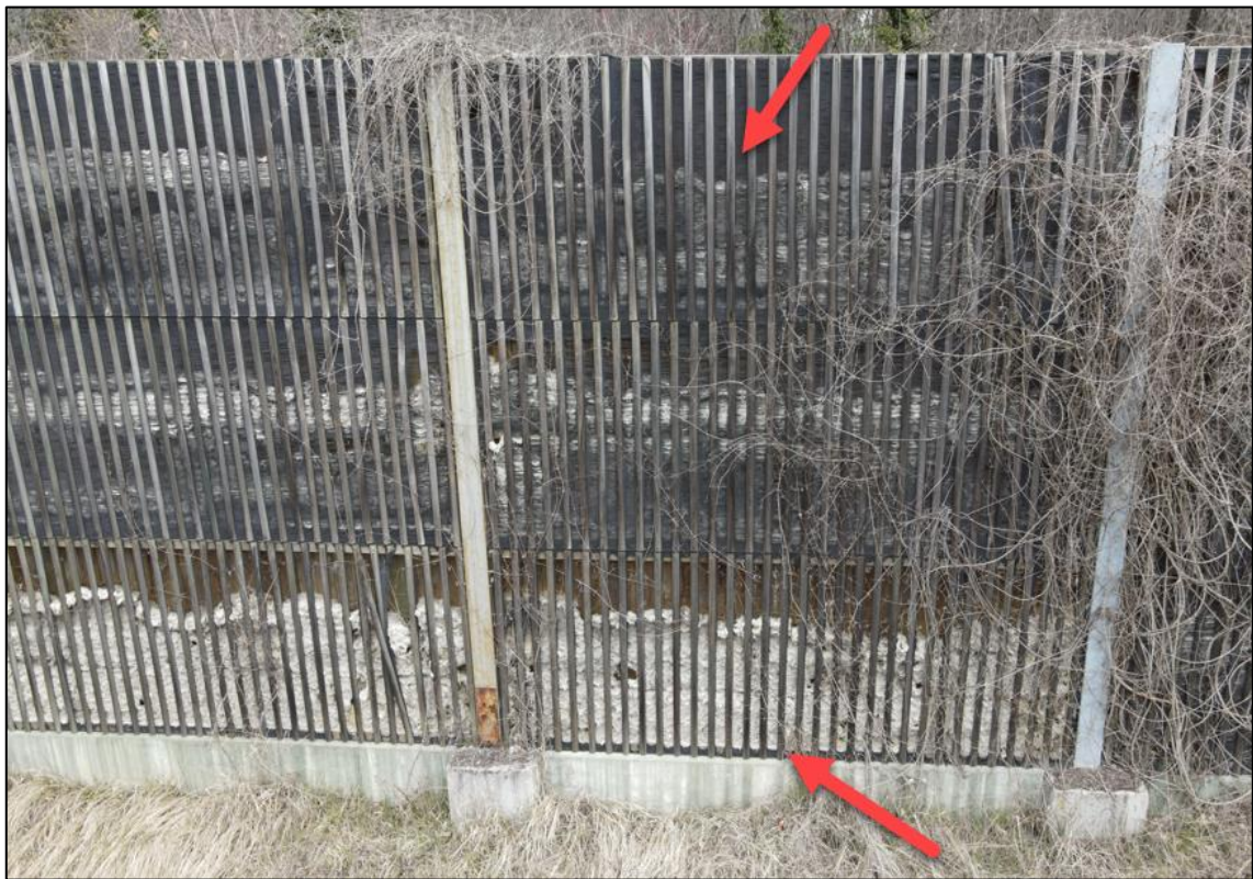
Slika 17. km 13+800.00 – oštećenje panela
