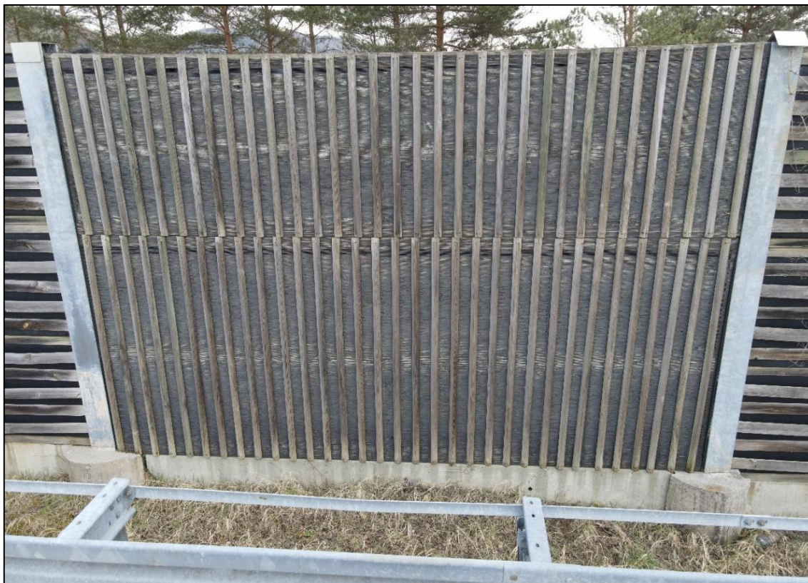
Slika 1. km 0+400.00 – karakteristično oštećenje drvenog panela (1)
