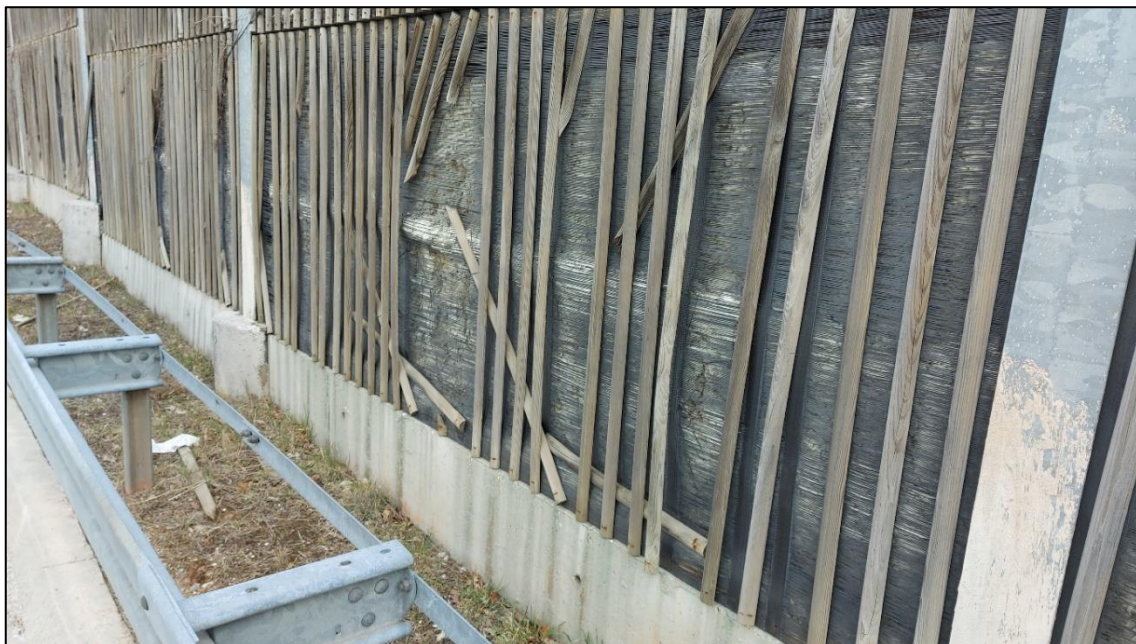
Slika 11. km 9+000.00 – karakteristično oštećenje drvenih panela
