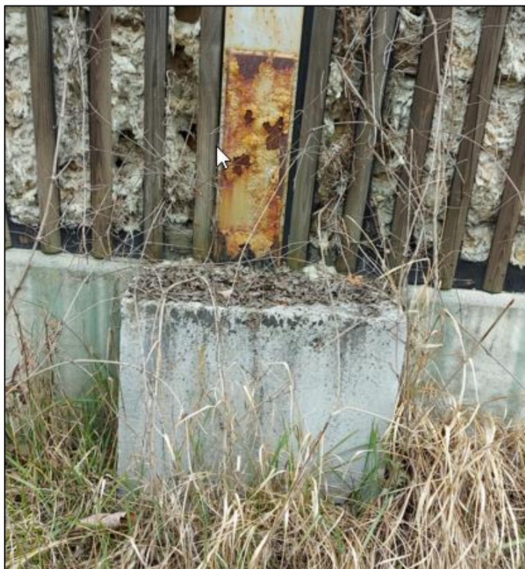
Slika 19. km 13+800.00 – korozija na HEA profilima
