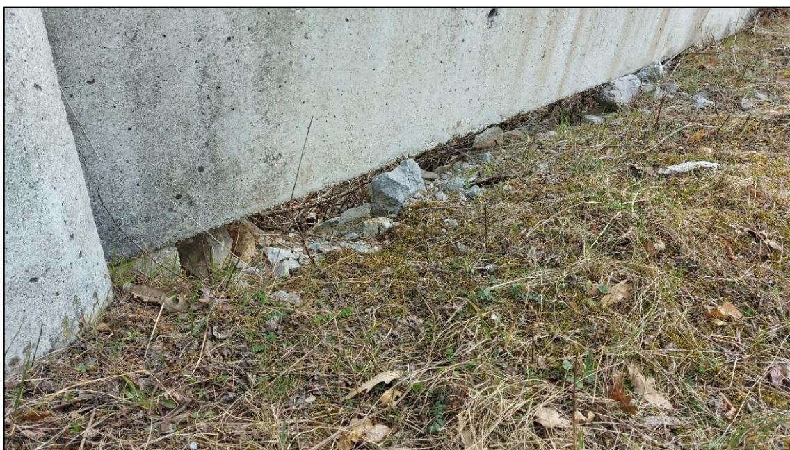
Slika 10. km 8+700.00 – 8+900.00 – zračnost ispod naglavne grede uslijed pojave erozije tla
