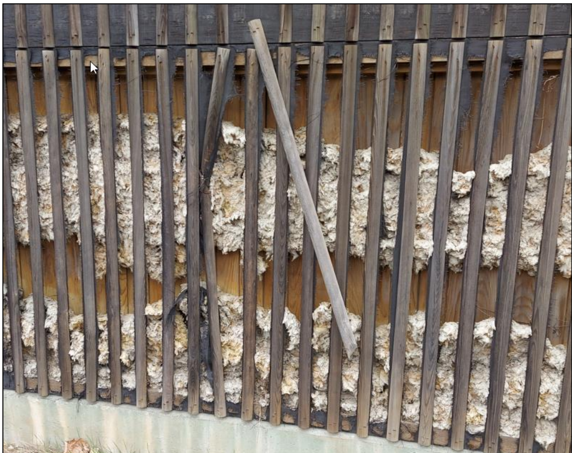
Slika 18. km 13+800.00 – oštećenje drvenih letvica i filca
