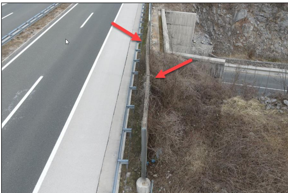
Slika 12. km 9+000.00 – 9+500.00 – ispadanje drvenih akustičkih panela iz ravnine
