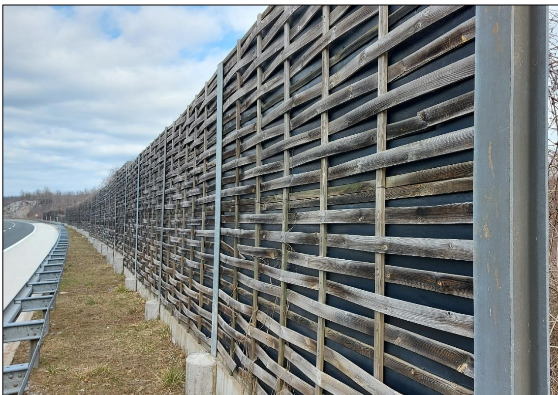
Slika 8. km 8+700.00 – 8+900.00 – stanje panela
