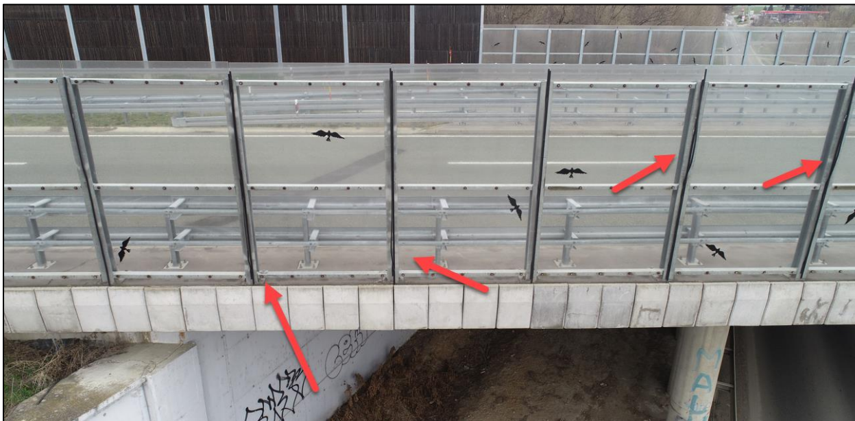
Slika 5. Oštećene gume na spojevima – smjer Beli Manastir
