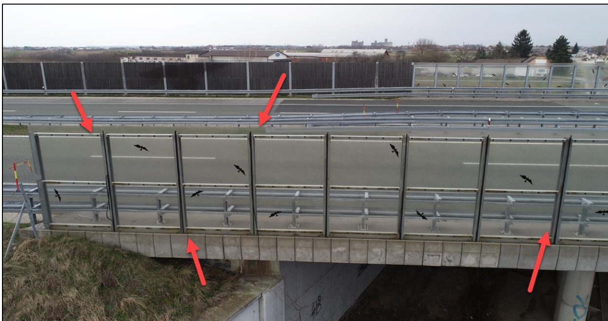
Slika 6. Oštećene gume na spojevima – smjer BiH
