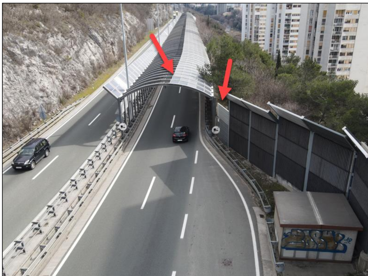
Slika 23. km 25+000.00 – pozicija oštećenog polja ZZOB i solarnih panela
