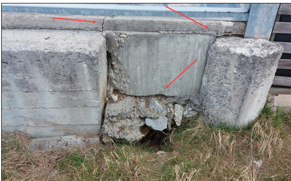
Slika 4. km 0+400.00 – oštećenje betonskih dijelova konstrukcije neposredno prije nadvožnjaka
