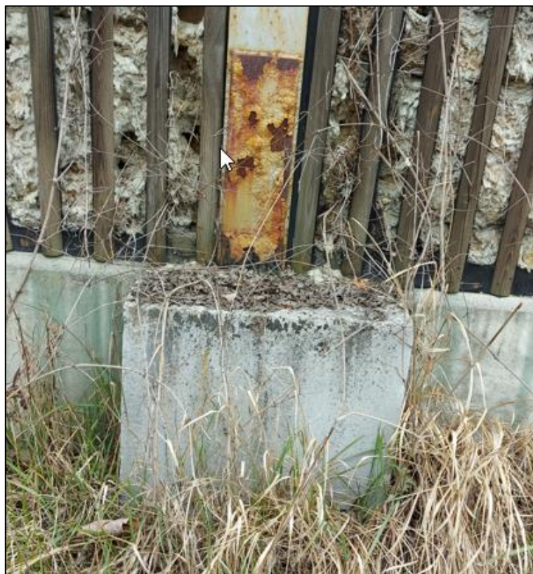
Slika 19. km 13+800.00 – korozija na HEA profilima
