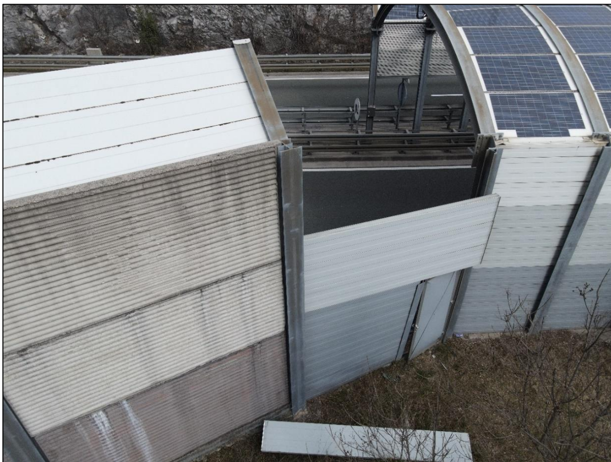
Slika 24. km 25+000.00 – oštećeno polje i aluminijska vrata
