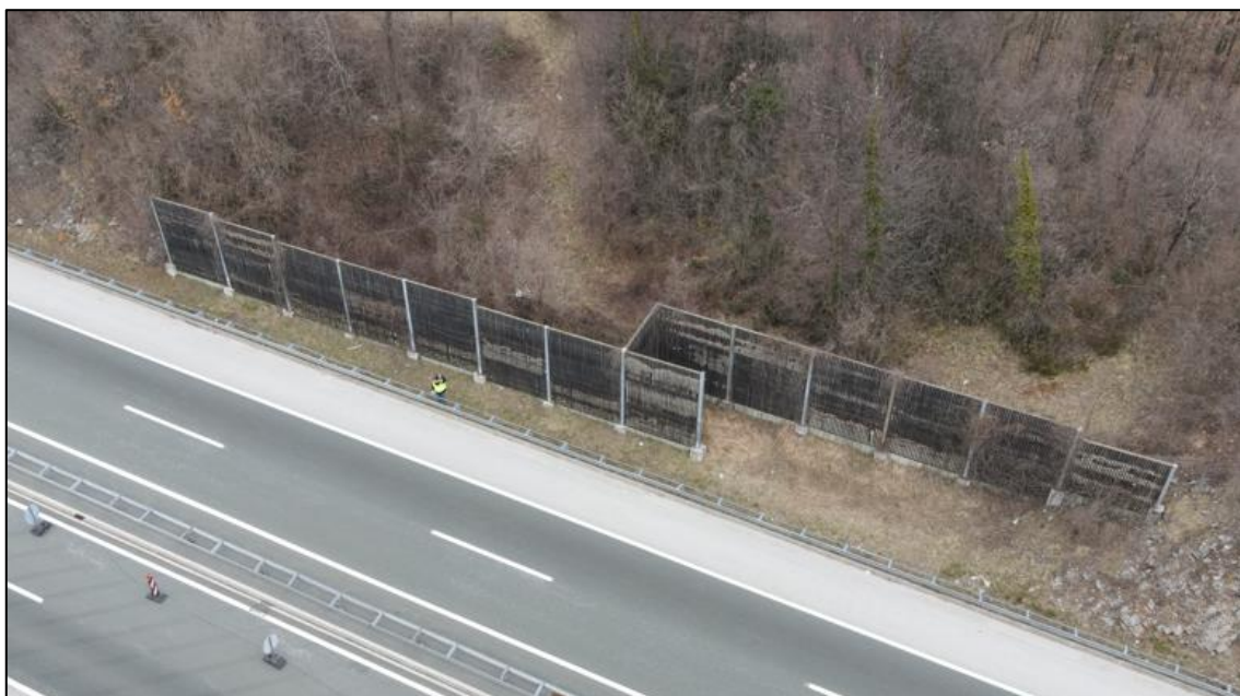
Slika 16. km13+800.00 – 13+900.00 – oštećeni zid za zaštitu od buke
