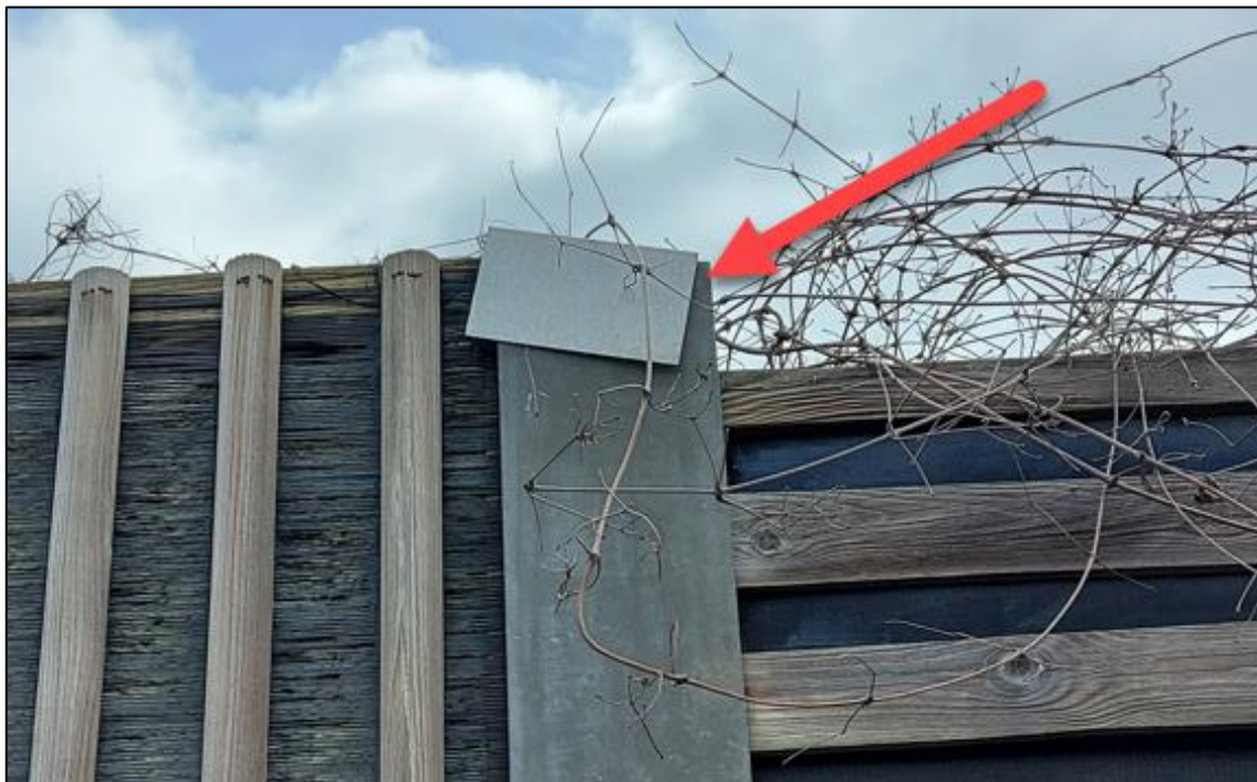
Slika 5. km 0+400.00 – oštećenje zaštitne kape na HEA profilima
