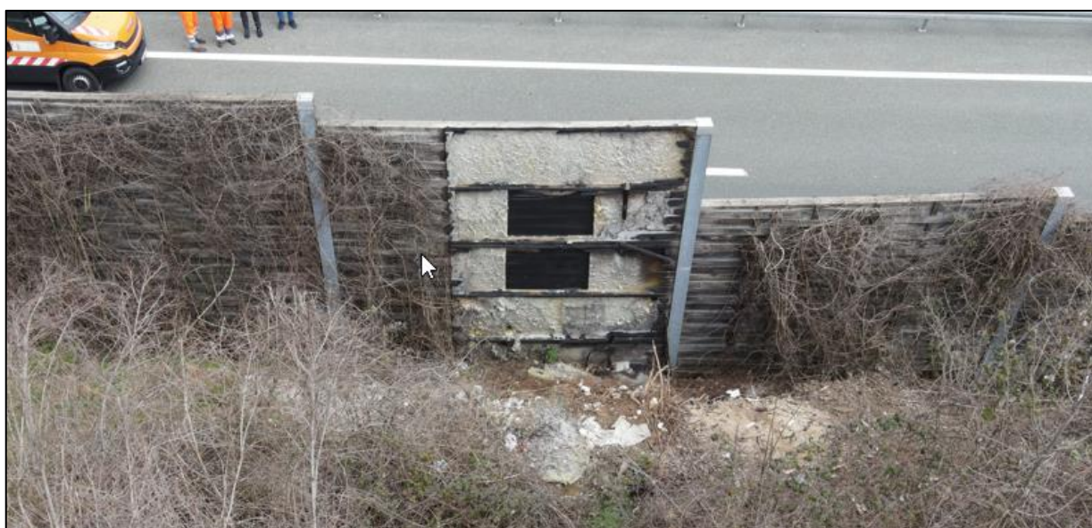
Slika 21. km 14+600.00 – panel oštećen u požaru – stražnja strana
