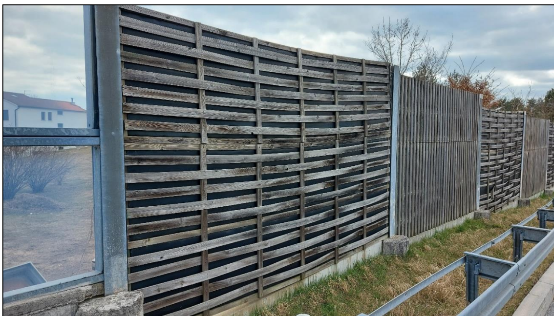
Slika 2. km 0+400.00 – karakteristično oštećenje drvenog panela (2)
