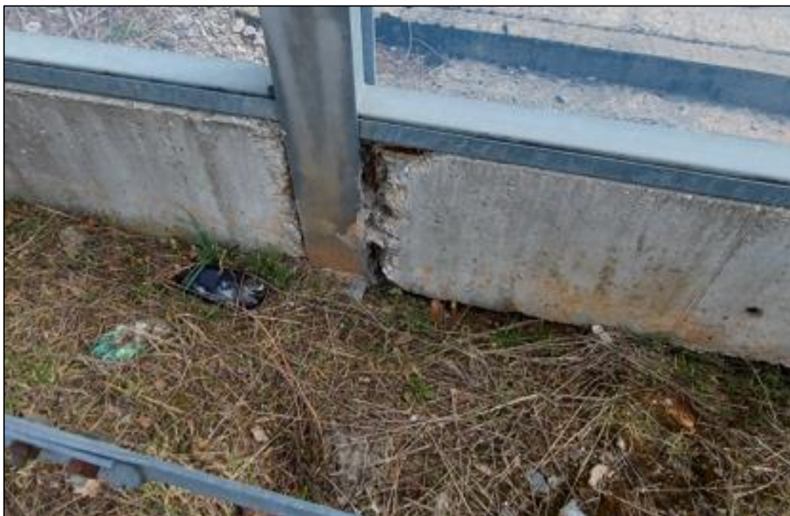
Slika 15. km 9+000.00 - 9+500.00 - otkrhnuće naglavne grede
