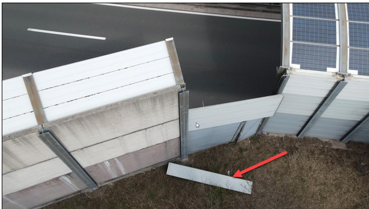
Slika 25. km 25+000.00 – odvojeni aluminijski panel
