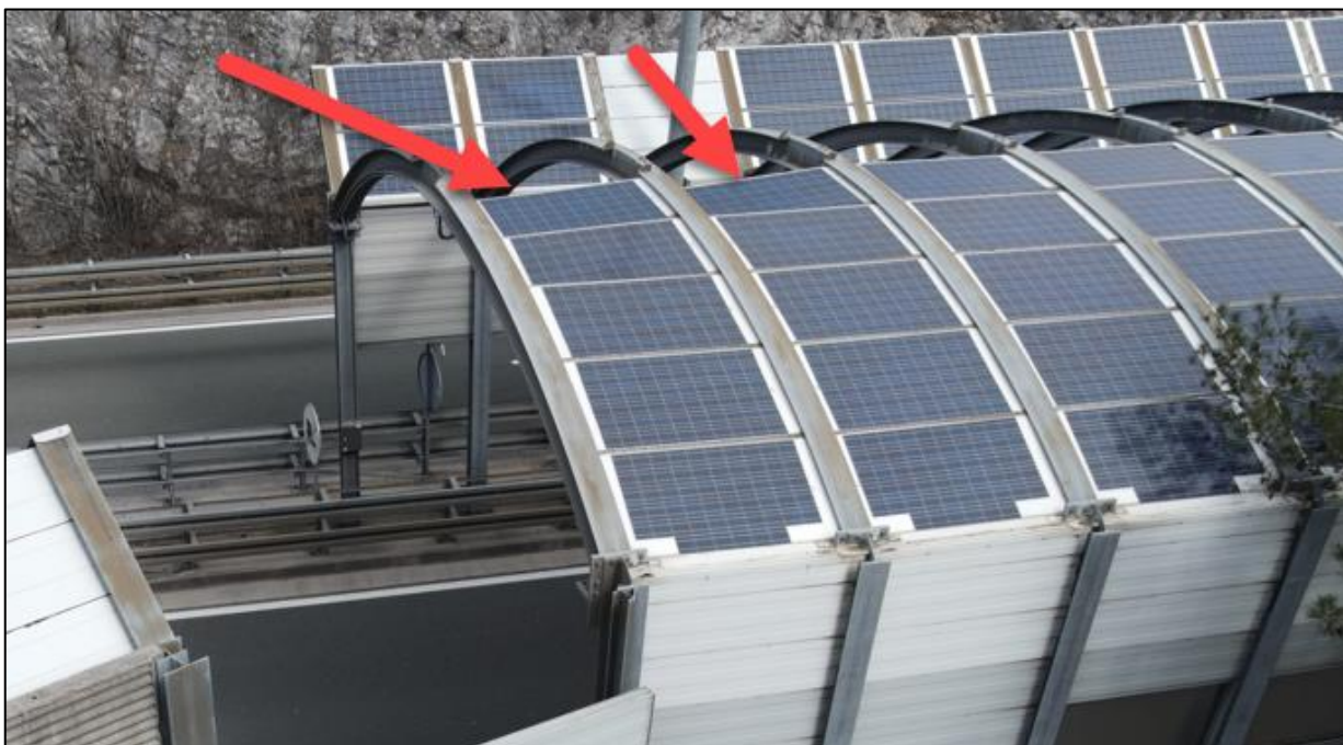
Slika 26. km 25+000.00 – oštećeni solarni paneli
