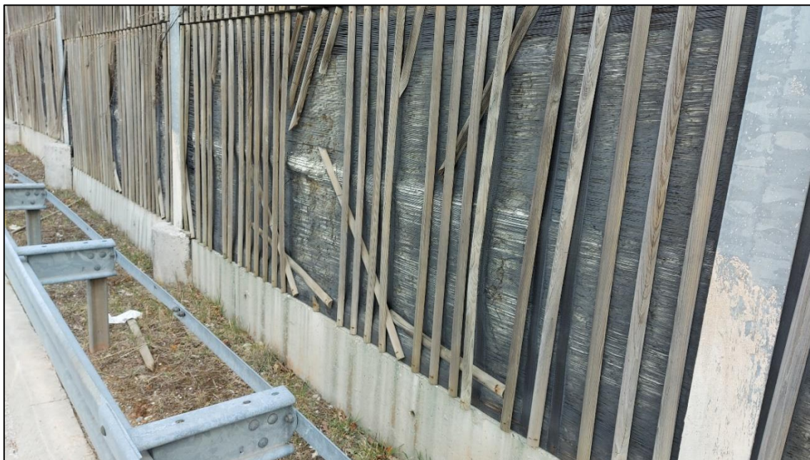
Slika 11. km 9+000.00 – karakteristično oštećenje drvenih panela
