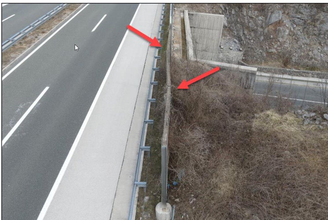
Slika 12. km 9+000.00 – 9+500.00 – ispadanje drvenih akustičkih panela iz ravnine
