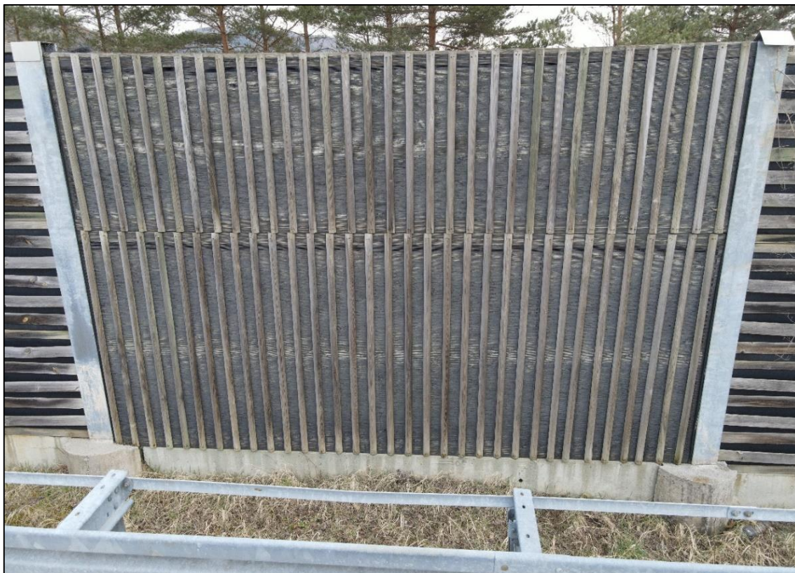
Slika 1. km 0+400.00 – karakteristično oštećenje drvenog panela (1)
