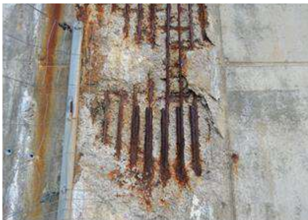
Slika 4_Korozija armature, krilo upornjaka U1
