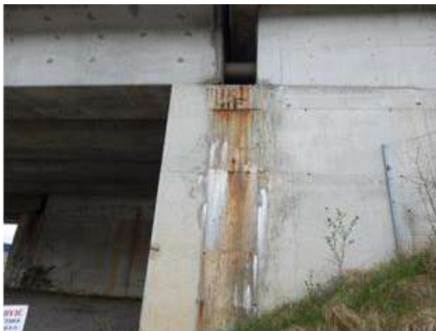
Slika 3_Pukotine, ljuštenje, odlamanje betona i korozija armature na krilu upornjaka U2, lijevo
