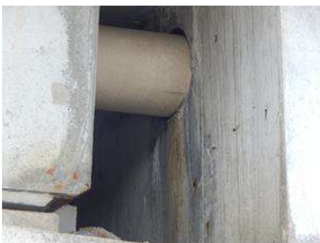
Slika 5_Vlaženje na spoju cijevi odvodnje i zidića upornjaka.
