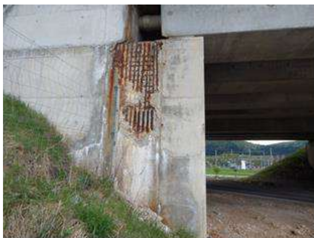
Slika 2_Odlomljen zaštitni sloj i korozija armature cijelom visinom upornjaka U1, desno.
