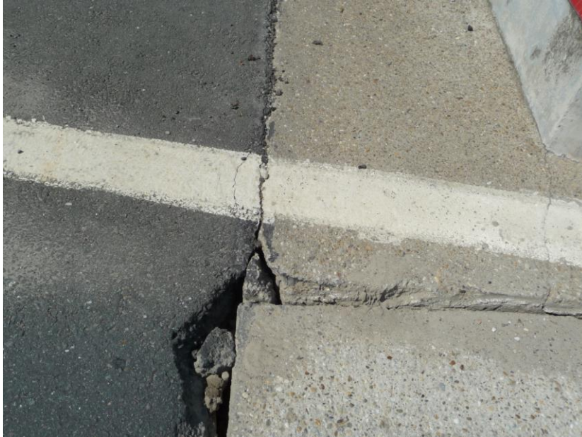
Slika 1.1.4: Odlamanje asfalta kod ruba 1. ploče i pukotina na otoku
