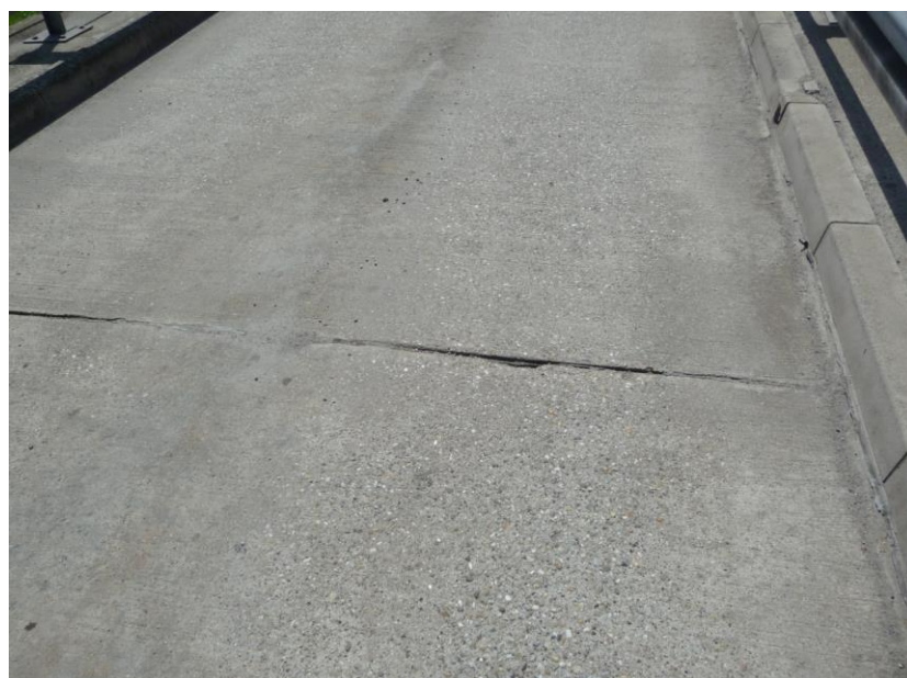
Slika 1.1.3: Oštećenja na rubovima betonskih ploča
