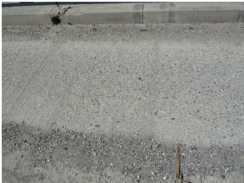
Slika 1.1.2: Poprečne pukotine na drugoj betonskoj ploči
