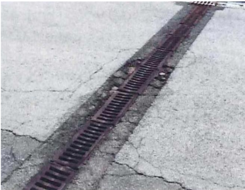
Oštećen je slivnički kanal pri izlazu sa odmorišta L strana (istok)
