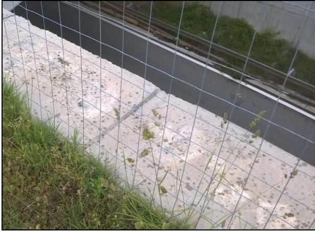
Slika 1.1-3: Kraj potpornog zida, spoj sa upornjakom, smanjenje uzdužne pukotine
