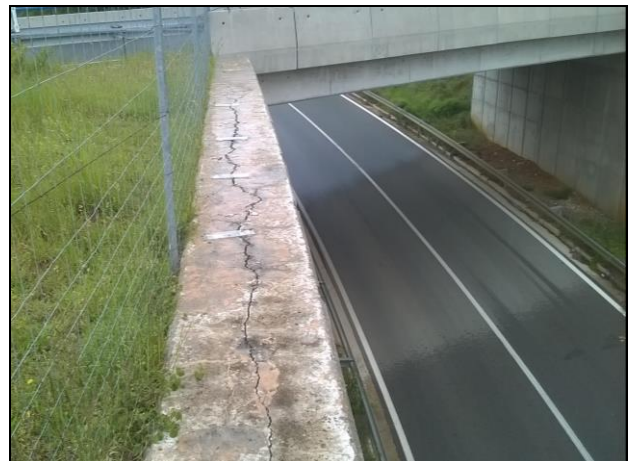
Slika 1.1-2: Uzdužna pukotina po cijeloj dužini potpornog zida nastala uslijed odvajanja unutarnje i vanjske zone zida, kao posljedica uzdužnog savijanja
