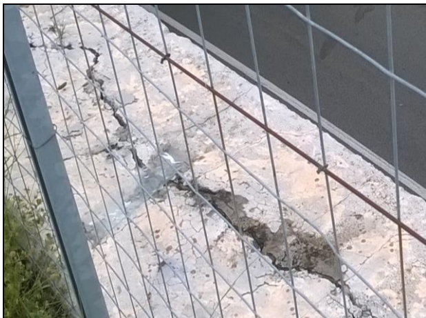
Slika 1.1-1: Pojava uzdužne pukotine 5-10 mm na sjevernom potpornom zidu podvožnjaka
