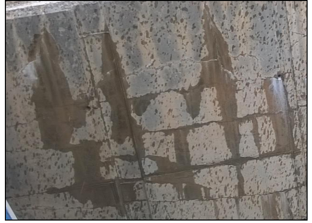
Slika 1.1-4: Izgled vanjske površine zida sa nizom mrežastih pukotina, kroz koje se dešava procjeđivanje oborinskih voda sa terena
