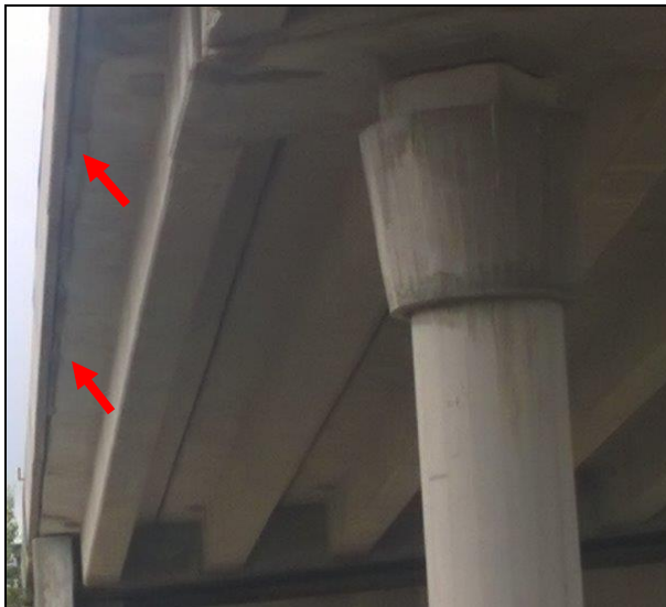
Slika 1.1-3: Curenje betona cijelom dužinom uz moguća odlamanja očvrstlog betona na spojevima ruba zaštitne ograde i konzole, koja mogu značajno ugroziti sigurnost prometa.
