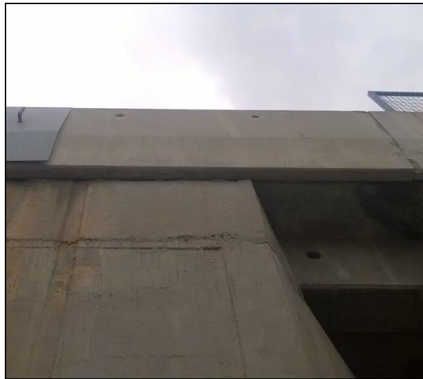
Slika 1.1-4: Spoj zaštitne ograde i upornjaka. Vidljivi su tragovi curenja betona od ispune.
