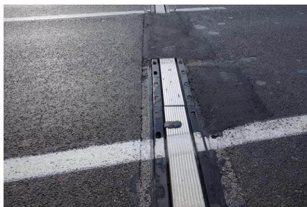
Slika 1.4 Detalj oštećenja prijelazne naprave
