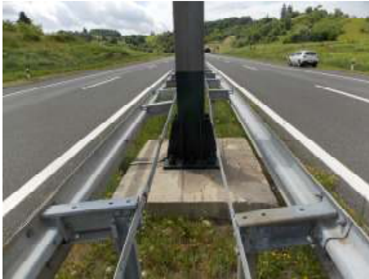
Slika 3 Raspucani temelj portala SPZ-a u centralnom pojasu autoceste.
