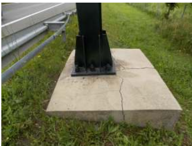
Slika 1 Pogled na oštećeni temelj portala SPZ-a uz zaustavni trak autoceste
