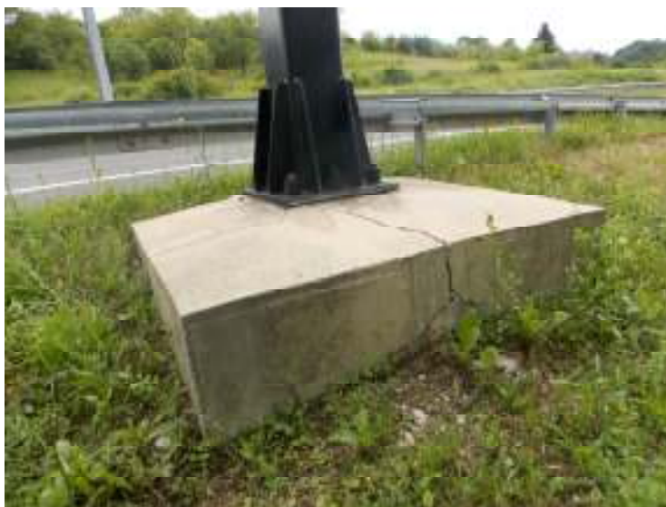
Slika 2 Bočna strana temelja. Pukotine kroz cijeli temelj.
