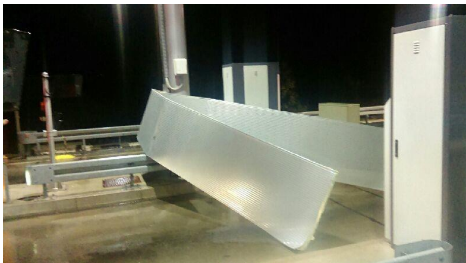
Slika 5. Srušene ploče podgleda
