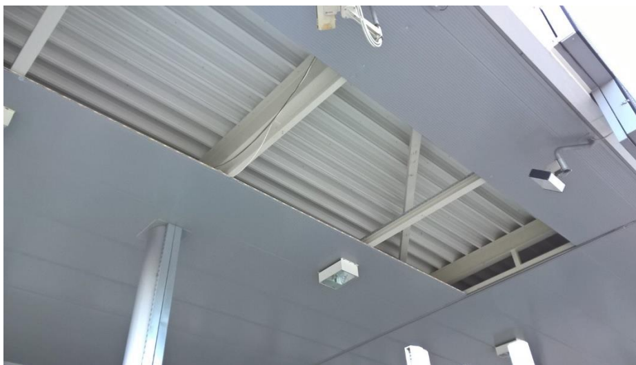
Slika 2. Podgled (oštećenje uslijed rušenja ploče podgleda)
