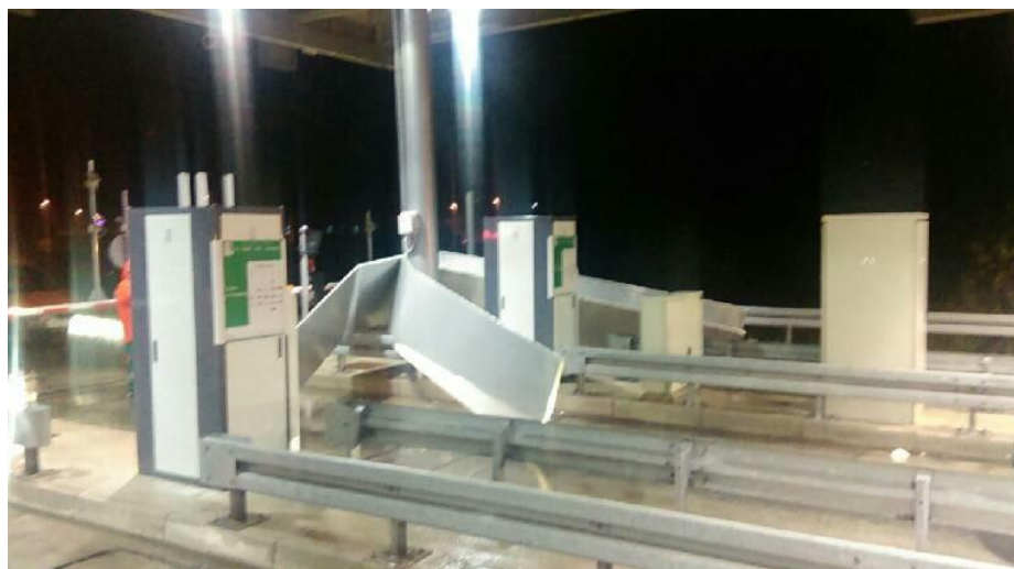
Slika 6. Srušene ploče podgleda
