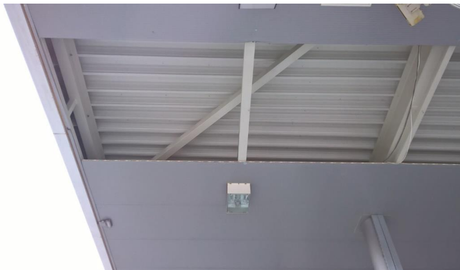
Slika 3. Podgled (oštećenje uslijed rušenja ploče podgleda)
